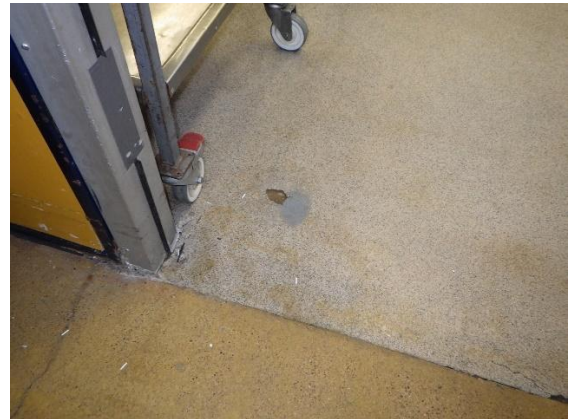
Kuva 89. Lattiapinnoite haljennut ja rikkoutunut
