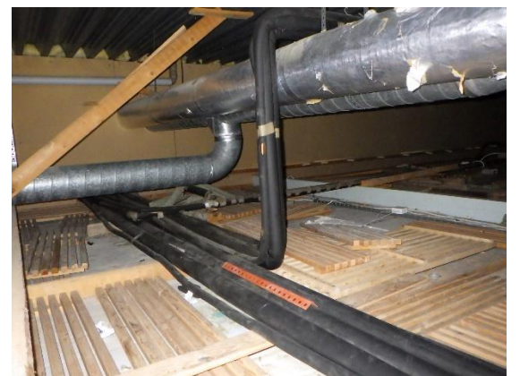
Kuva 59. Kylmiön yläpuolista tilaa
