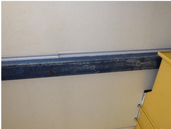
Kuva 88. Ruostetta tiskaushuoneen 53 teräspalkissa
