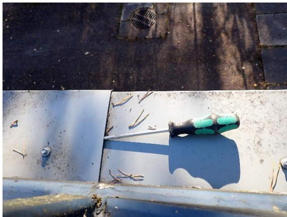
Kuva 50. Rästäspellitysten saumat eivät ole tiiviitä
