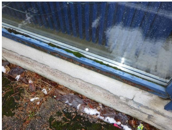
Kuva 64. Ikkunoiden osalla havaittiin paikoin sammaloitumista ja metalliosissa ruostetta
