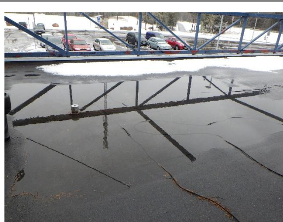
Kuva 44. Vesikatolla havaittiin veden lammikoitumista, koska roskat tukkivat roskasihtiä
