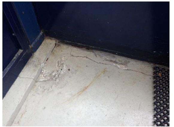
Kuva 13. Kosteusjälkiä ja halkeamia tuulikaapin lattiassa
