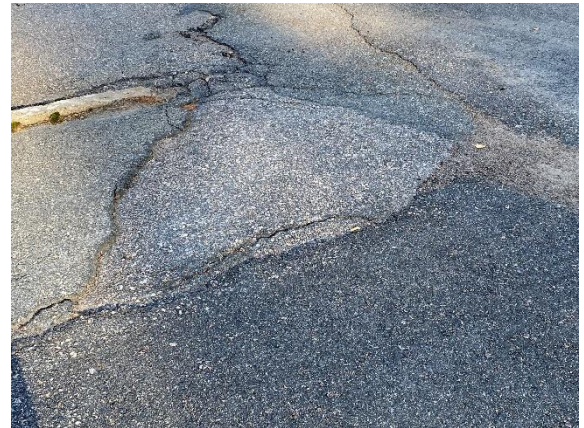
Kuva 8. Kuormauspihan huonokuntoista asfalttia
