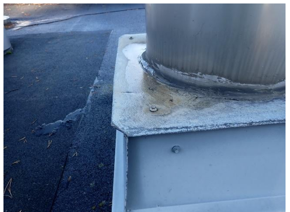
Kuva 47. IV poistopuhaltimen laatikon kannen päälle jää vettä lammikoitumaan, vuotoriski
