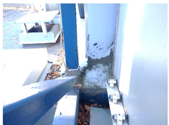
Kuva 53. Vesikattopellitysten kittauksia, osa kit- tauksista ikääntyneitä ja tiiveys huono
