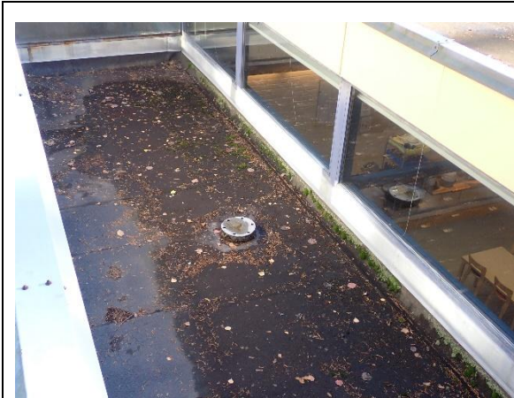
Kuva 42. Ruokalan ns. käytävän vesikattoa, kattopinnalla roskaa ja sammalta. Ei käyntitikkaita.
