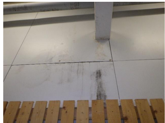
Kuva 97. Levytyksissä havaittiin tummentumia
