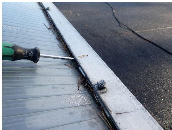
Kuva 56. Valokatteen alaosan listoitus ei ole tiivis, vesi valuu listaa vasten, kiinnitysruuvi irti
