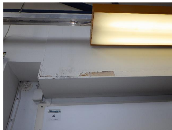
Kuva 99. Pakastin nro 4 (vihannes- ja kalapakaste) oven yläpuolisessa levytyksessä havaittiin kosteus- ja valumajälkiä
