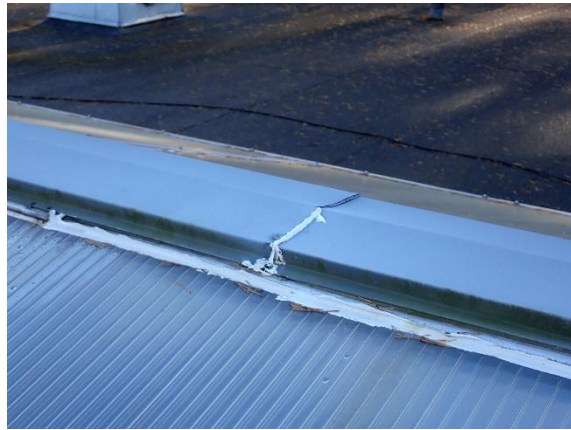
Kuva 54. Valokatteen harjapellityksen sauma ei ole tiivis
