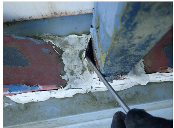
Kuva 51. Vesikattopellitysten kittauksia, osa kit- tauksista ikääntyneitä
