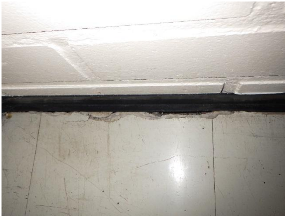
Kuva 16. Lattian ja ulkoseinän epätiivis liittäjä ruokalassa
