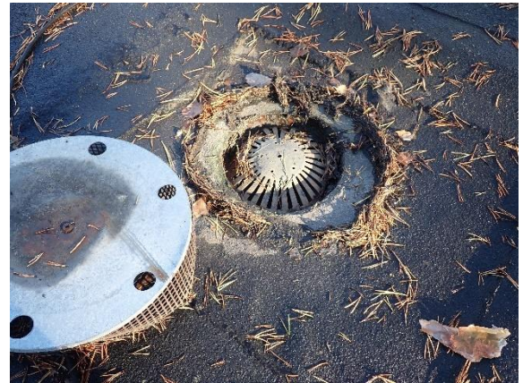
Kuva 43. Kattokaivo, sihti nostettuna sivuun. Havunneulasia pääsee sadevesijärjestelmään varmuudella.
