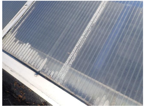
Kuva 55. Kosteutta kennovalokatteen sisällä
