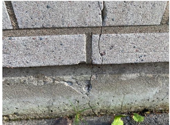
Kuva 29. Julkisivun halkeama alkaa sokkelin halkeaman kohdalta
