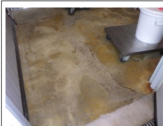
Kuva 96. Kylmiötilaa, lattiapinnoite on kulunut
