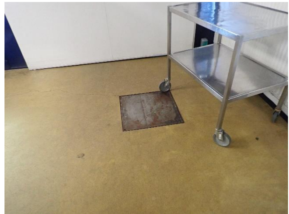
Kuva 21. Luukku AP rakenteessa, ruosteessa ja epätiivis
