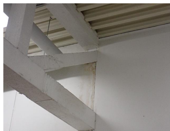
Kuva 101. Ristikon liittymä ulkoseinään, levypin- nalla kosteusjälkiä ja hometta.
