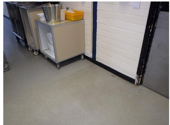
Kuva 111. Kosteusjälkiä ruokailutilan väliseinän alaosassa
