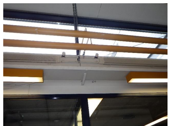
Kuva 117. Lämmityspatteri katon rajassa ikkunan alla
