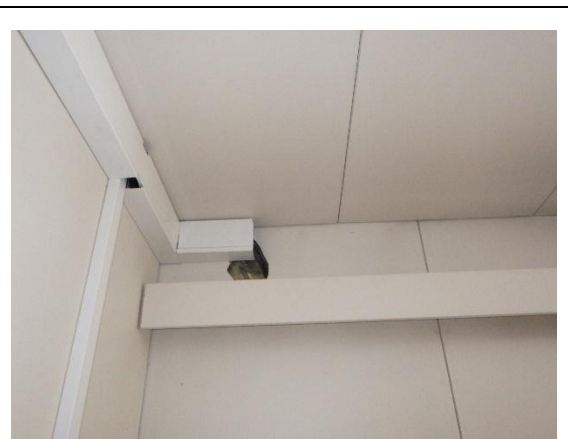
Kuva 109. Ulkoseinän osalla oleva avoin läpivienti
