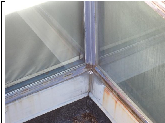
Kuva 74. Käytävän ikkunan liittymä, vesivuotoa
