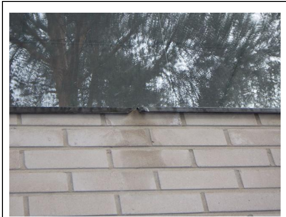
Kuva 68. Epätiiviskohta ikkunan vesipellissä
