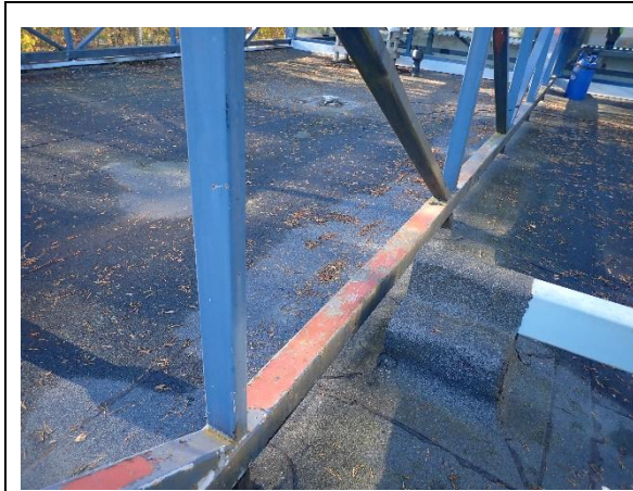
Kuva 34. Pinnoitavaurioita kantavissa teräsrakenteissa ja alkavaa ruostumista
