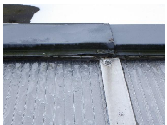
Kuva 71. Kattoikkunan harjapellin liittymä ei ole tiivis
