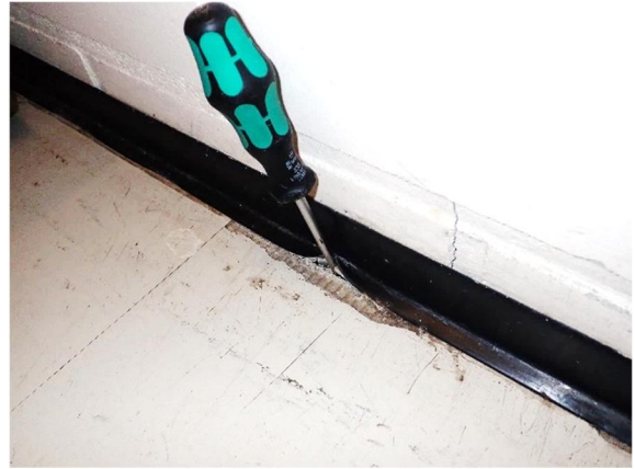
Kuva 17. Alapohjan epätiivis liittäjä tila 5
