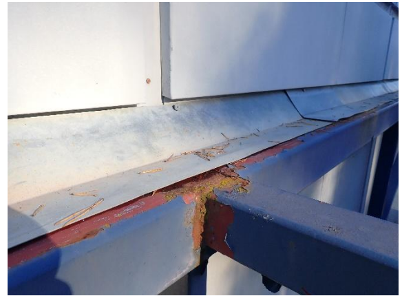
Kuva 35. Ruostetta kantavissa teräsrakenteissa
