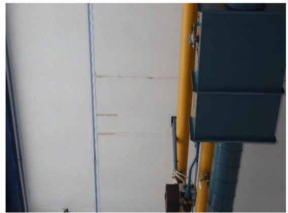
Kuva 63. Kattopinnoitteissa havaittiin kosteusjälkiä
