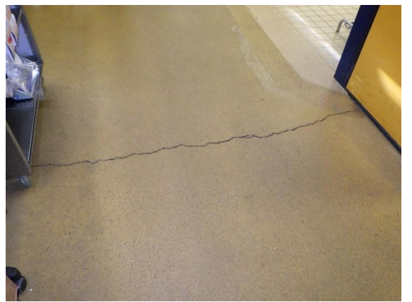
Kuva 15. Halkeama käytävän 7 lattiassa
