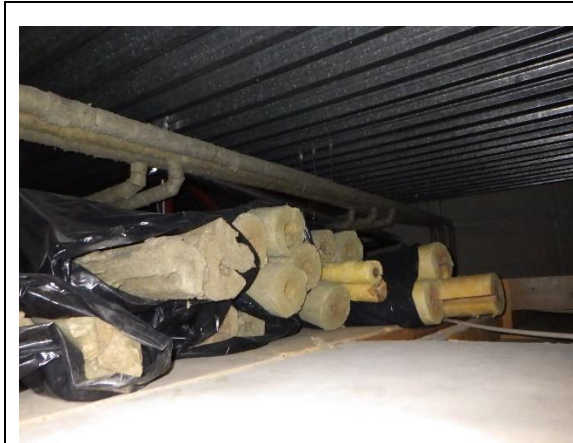
Kuva 131. Ilmanvaihtokanavia ja varastoituja putkieristeitä
