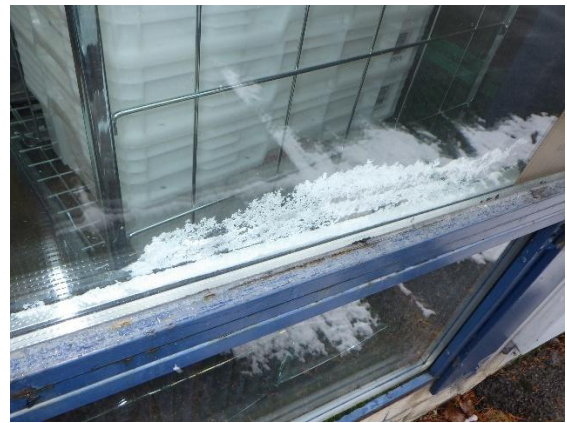
Kuva 65. Kalkkihärmettä ikkunan välissä
