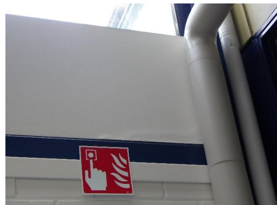
Kuva 33. Kosteusjälkiä ulkoseinän levyrakenteissa ruokalan ns. katoksen pädyssä ulkoseinän levyrakenteissa
