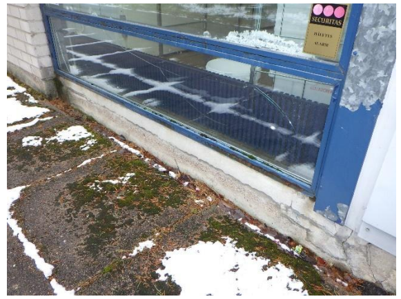
Kuva 11. Halkeamia ja pinnoitteen irtoamista sokkelissa
