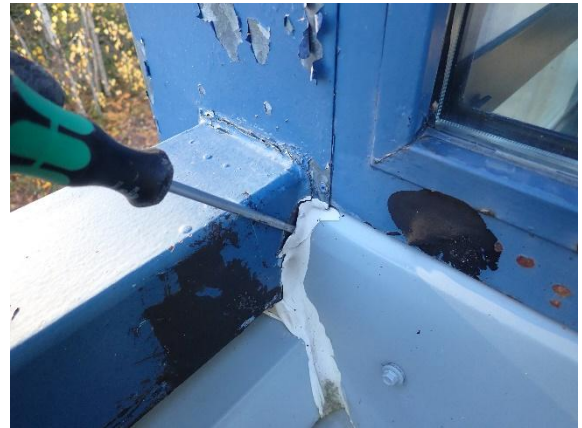
Kuva 49. Vesikattopellitysten kittauksia, osa kit- tauksista ikääntyneitä
