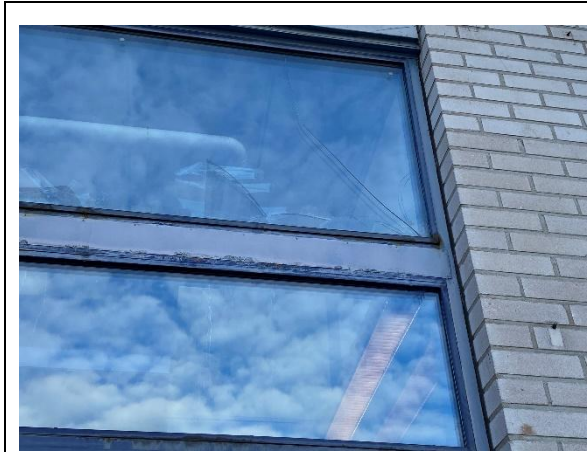
Kuva 66. Eteisen 4 ikkunassa havaittiin halkeama
