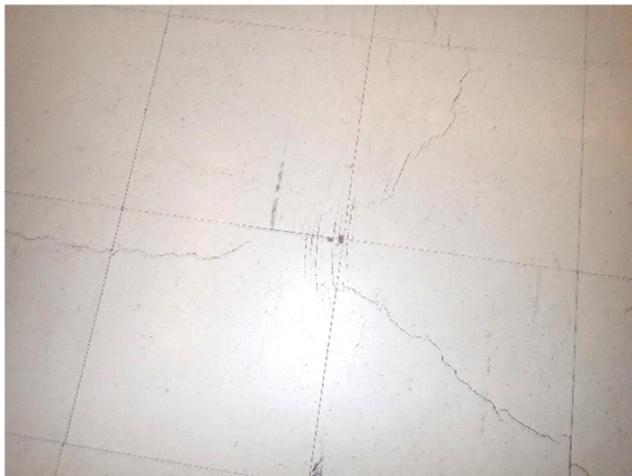
Kuva 20. Ruokala(tila 5 varasto) lattiapinnoite on alkuperäinen vinyylilaatta(sis. asbestia), pinnoite halkeillut ja kulunut
