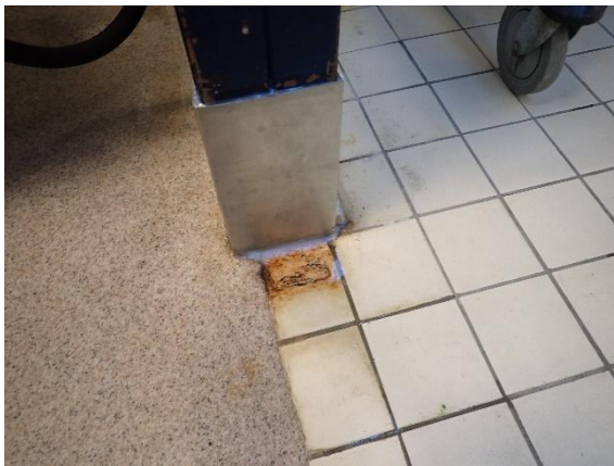
Kuva 92. RST pellillä peitetty ruosteinen kantava teräspilari, pilarin alaosan kunnosta ei tietoa, ruostunut voimakkaasti.
