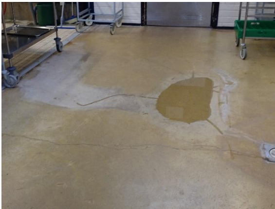
Kuva 18. Lammikoituvaa vettä käytävä 6 lattialla
