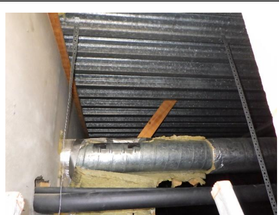
Kuva 132. Ilmanvaihtokanavia, puuttuva eristys ja avoimia villapintoja.
