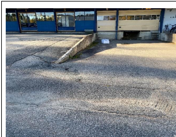
Kuva 7. Kuormauspihan huonokuntoista asfalttia
