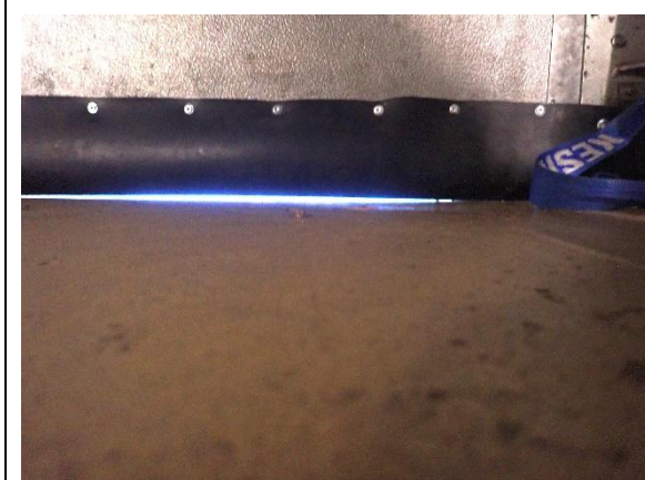
Kuva 76. Lastausalueen ovissa tiiveyspuutteita joista on seurauksena pienjyrsijäongelma kiinteistössä
