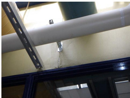
Kuva 32. Kosteusjälkiä ulkoseinän levyrakenteissa kattoikkunoiden alapuolella
