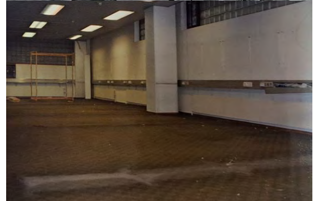
Kuva 68. Kuvassa huonokuntoinen kirjaston alkuperäinen kokolattiamatto. Kuva vuodelta 1993.
