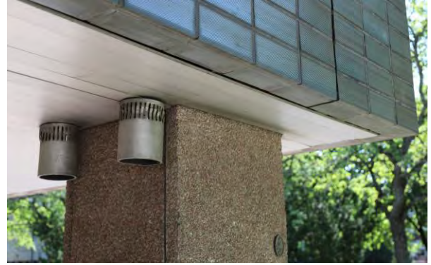
Kuva 129. Arkadikäytävän katoksen liitos.
