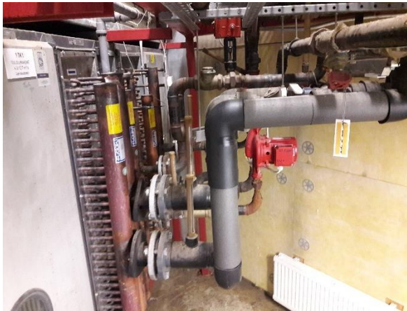
13.30 Ilmastointikone 1 TK 1 yläpohjassa sijaitsevassa IV-konehuoneessa.
