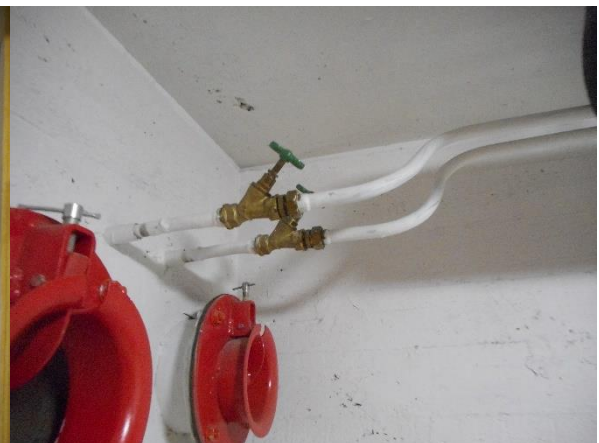
13.6 Väestönsuojassa olevat, eristämättömät lämpöputket ja karasulkuventtiilit. Karasulkuventtiilit ovat arviolta alkuperäiset.
