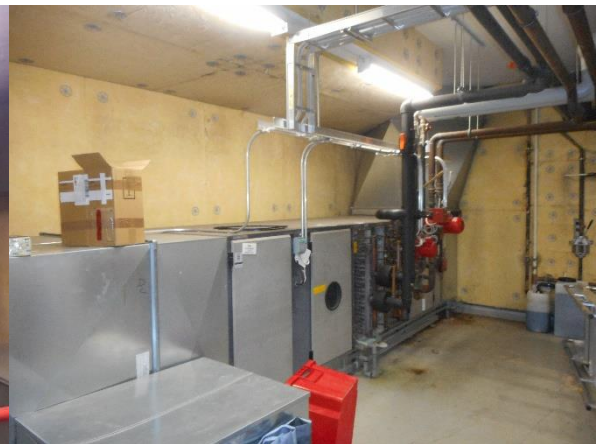
13.33 Ilmastointikone 3 TK1 pohjakerroksen teknisessä tilassa.
