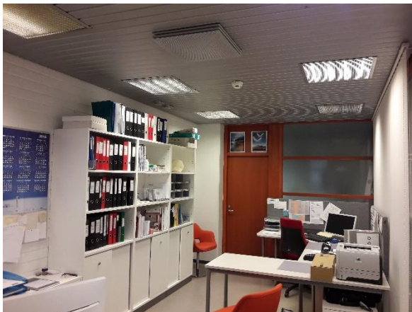
13.40 Ilmastoinnin päätelaitteet pohjakerroksen tilassa 048.
