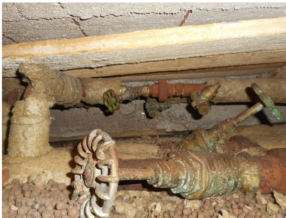
13.50 Putkikanaalissa havaittiin aistinvaraisesti pinnoittamatonta mineraalivillaa.
