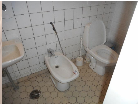
13.23 Naisten pukuhuoneen WC-tila. WC-tilassa oli alkuperäinen kuparinen lattiakaivo. Vesikalusteet on uusittu eri ajankohtina.
