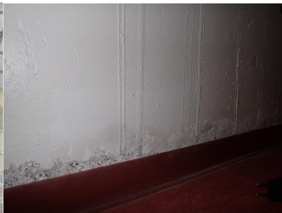
7.6 Maanvastaisessa ulkoseinärakenteessa lähellä lattiaa maali irronnut rakennuksen itäpuolella
