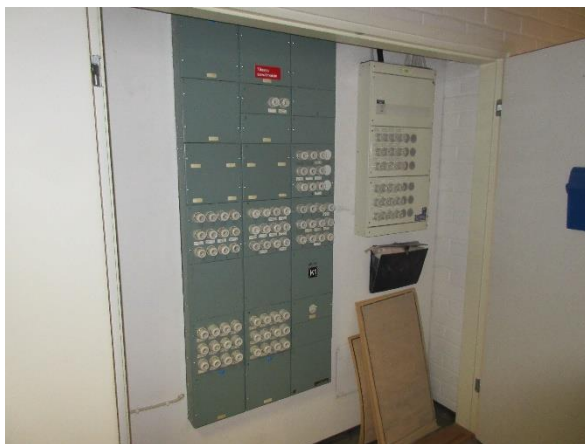
13.1.1 Keskuskomerossa alkuperäinen keskus vuodelta 1971 ja vuonna 1994 lisätty tulppasulakekeskus
