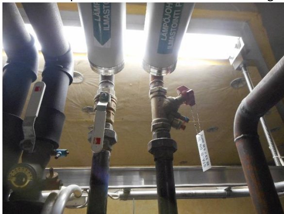
13.14 Ilmastointikoneiden lämmityspatterien putkia ei ole eristetty putkien pystyosuuksilta lainkaan.
