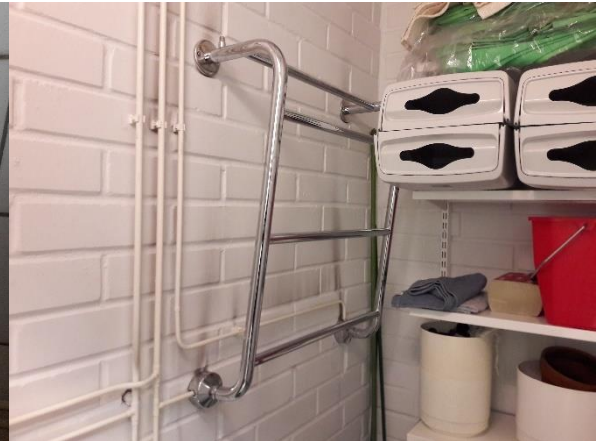
13.27 Siivouskomero on varustettu käyttövesiverkostoon liitetyllä rätipatterilla.
