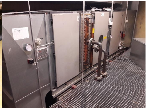
13.31 Ilmastointikone 1 PK 1 yläpohjassa sijaitsevassa IV-konehuoneessa.
