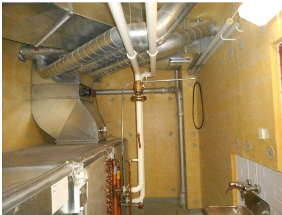
13.46 Pohjakerroksen IV-konehuoneessa olevat asennukset ovat maalaamattomia pyöreitä kierresaumattuja kanavia ja kanttikanavia.
