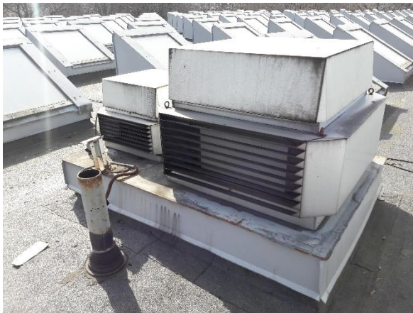
13.36 Poistoilmapuhallin 4 PF 2 palvelee keittön ja WC-tilojen poistoilmanvaihtoa.
