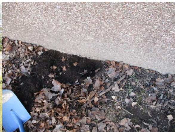
6.2 Rakennuksen maanalaisissa rakenteissa ei havaittu ulkopuolella perusmuurilevytystä tai vesieristettä. Reunustat ovat joko sorakivettyjä tai multaa
