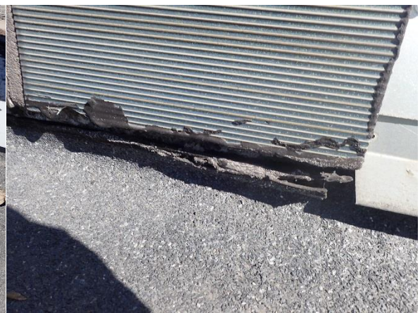
12.2 IV-konehuoneen liittymä kattuhuopa hie- man irronnut ja epätiivis
