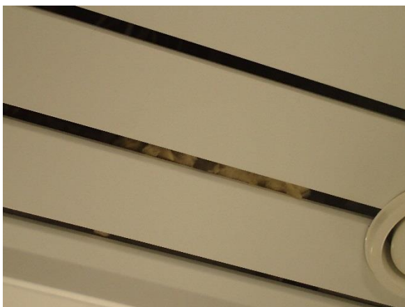
10.7 Paikallinen irtonainen mineraalivilla kellari- kerroksen wc-tilan alaslasketun katon yläpuo- lella
