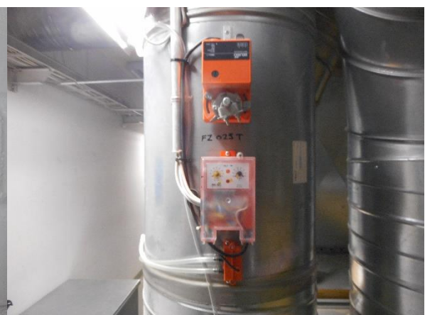
13.66 Ilmavirtasäädin pohjakerroksen IV-konehuoneessa olevassa IV-kanavassa.
