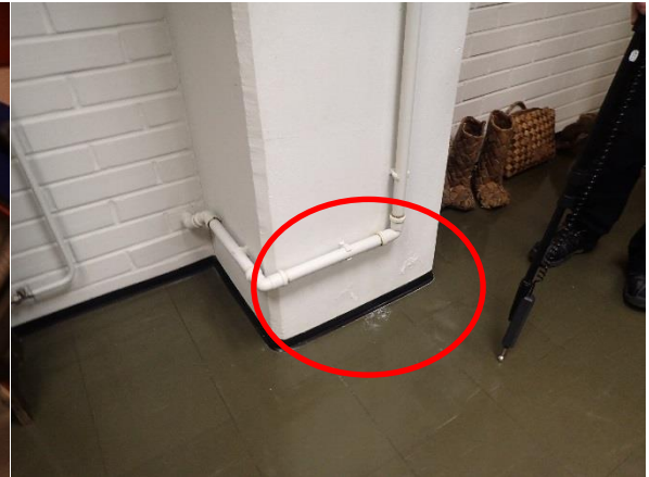
8.5 Muistohuoneen 062 ilmankostutin vuotanut lauhdevettä lattialle ja pilarin juureen
