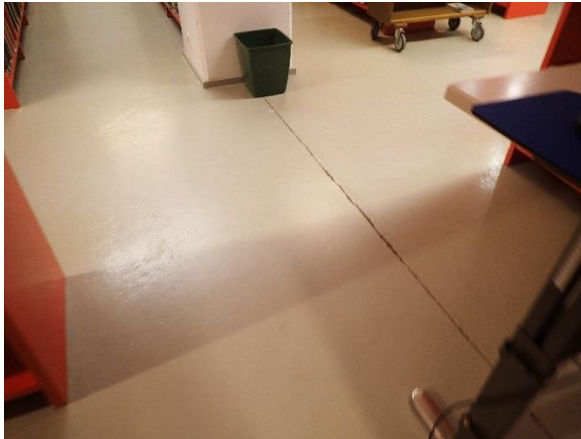
8.4 Kirjavaraston 013 lattiassa selkeä halkeama
