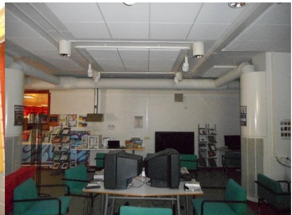
13.47 Näyttelytilassa olevat kanavat ovat valkoiseksi maalattua pyöreää, kierresaumattua kanavaa.
