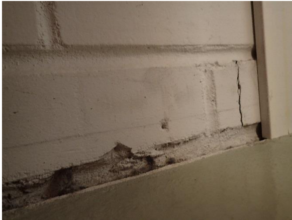
8.6 Kotiseutukokoelman 030 väliseinän ja alapohjan välissä on selkeä rako
