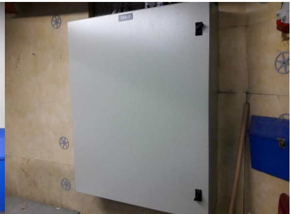
13.64 VAK-1 yläpohjan IV-konehuoneessa.
