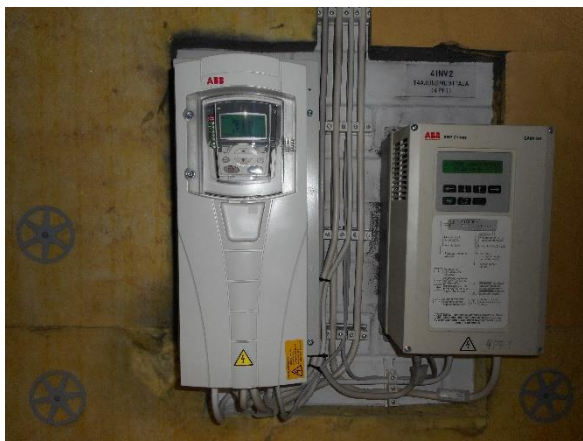
13.67 Ilmastointikoneen puhaltimen taajuusmuuttaja.
