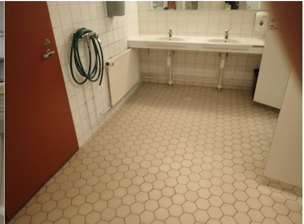
10.4 1.kerroksen wc-tilojen pintamateriaalit ikääntyneitä
