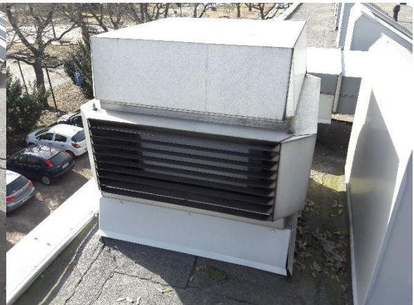
13.37 Poistoilmapuhallin, jonka kyljestä ei löydetty laitetunnusta.
