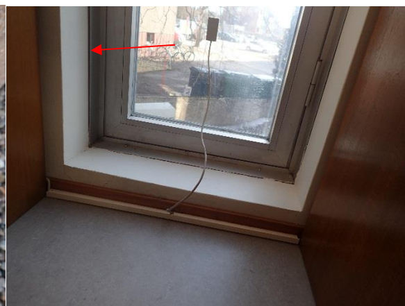
9.10 Ikkunoiden alumiinilistat vääntyneet ja epätiivisiä
