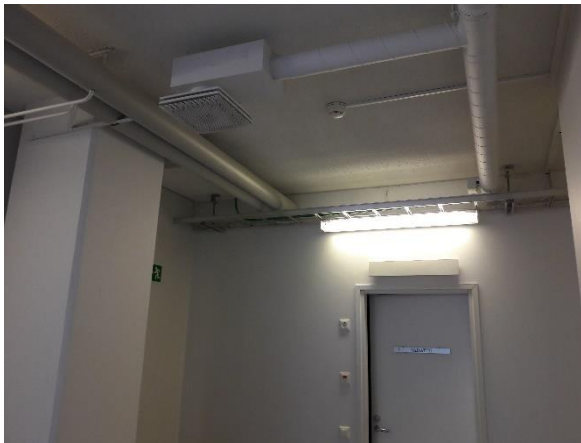
13.44 Pohjakerroksessa olevaa näkyvää kanava-asennusta. Näkyvät kanava-asennukset on maalattu valkoiseksi.
