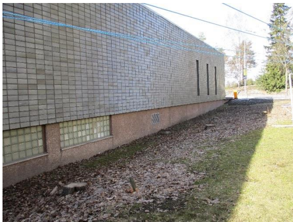
6.1 Rakennuksen itäpuoli viettää voimakkaasti rakennukseen päin
