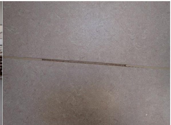
10.2 Paikallisia epätiivelyskohtia havaittiin pinnoitteiden saumoissa
