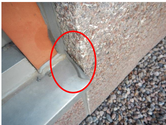
9.9 Lasitiili ikkunan pellityksen liittymä ulkoseinärakenteeseen epätiivis
