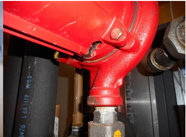
13.4 Ilmastointikoneen 3 TK1 lämmityspatterin kiertovesipumpussa havaittiin vuoto.
