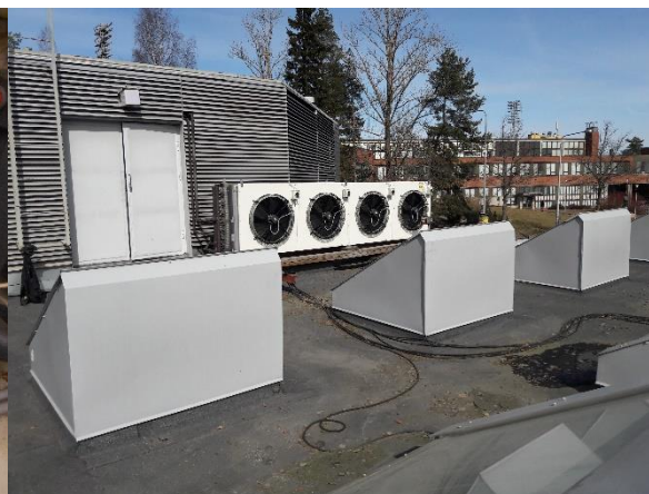
13.52 Jäähdytysjärjestelmän lauhduttimet sijaitsevat vesikatolla.
