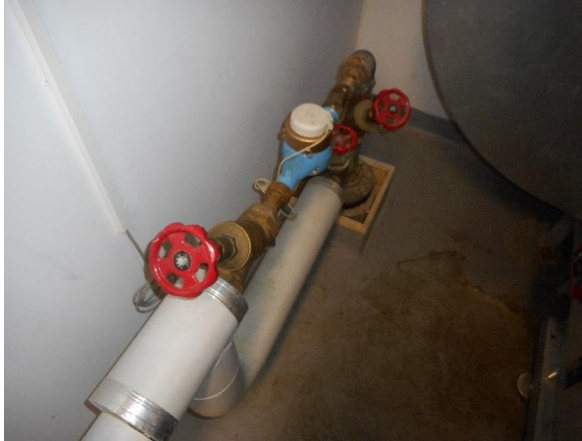
13.16 Rakennuksen tonttivesijohto ja vesimitari IV-konehuoneessa.
