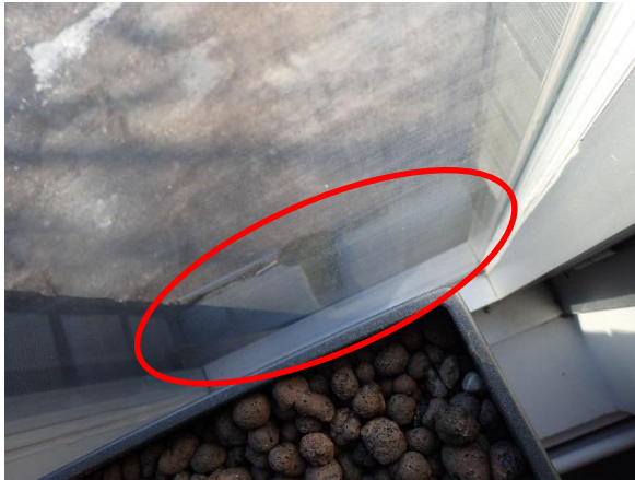
9.3 Ikkunapenkeillä ja alapuolella sammalkasvustoa
