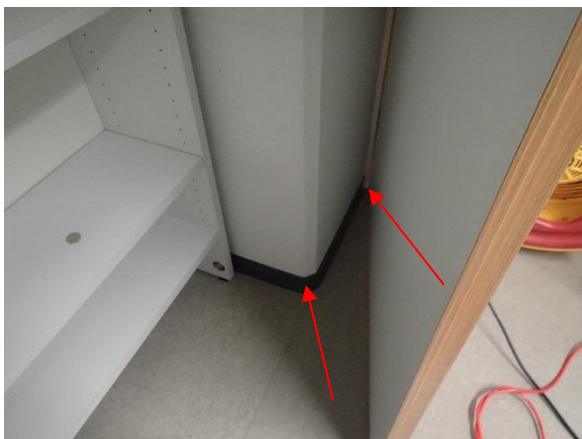
8.15 Pilarin ulko- ja sisänurkasta havaittiin selkeä ja merkittävä ilmavuotoreitti
