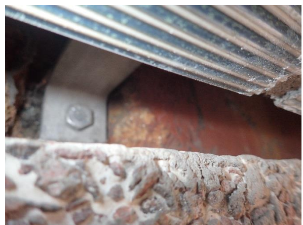
9.8 Ulkoseinän kuorielementin ja eristeen välissä selkeä ilmarako
