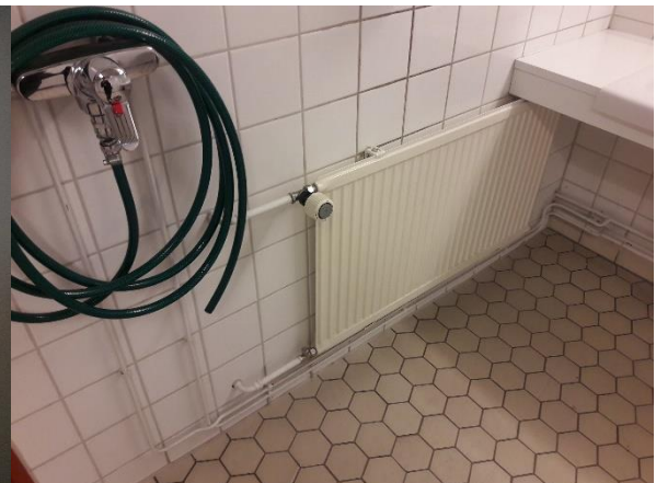
13.11 Naisten WC-tilaan oli asennettu urapintainen patteri ja termostaatti.
