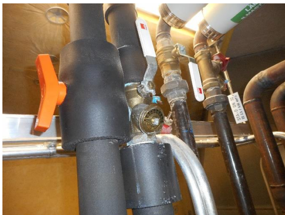
13.7 Lämmitysputkien sulku- ja linjasäätöventtiileitä on uusittu ajan saatossa.
