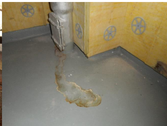
13.21 IV-konehuoneessa oleva valurautainen pystyviemäri on vuotanut tarkastusluukun kautta. Kosteusjälki oli tutkimushetkellä kuiva.
