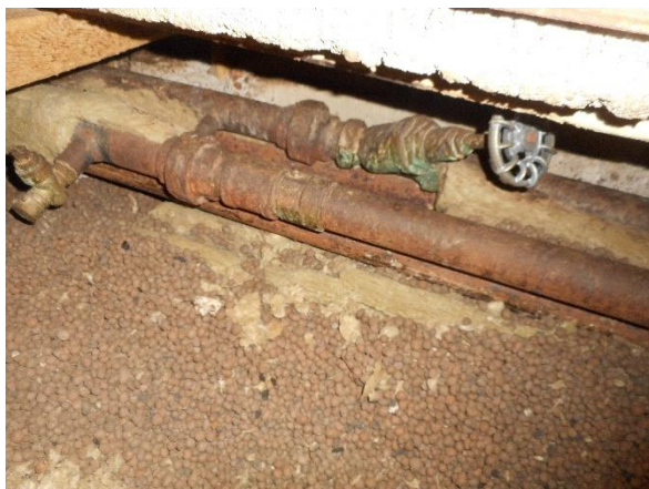
13.20 Putkikanaalissa olevia vesi- ja lämpöputkia. Putket ovat hapettuneet.
