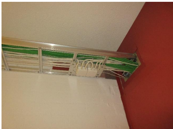
13.1.3 Tiivistämätön läpivienti, vaikuttaisi olevan paloläpivienti.
