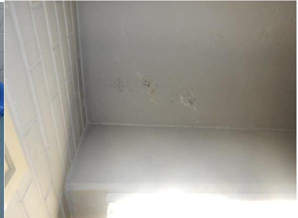
10.6 Välipohjarakenteen alapinnassa on maali- kupruja (IV-konehuone, pohjakerros), miesten wc:n alapuolella
