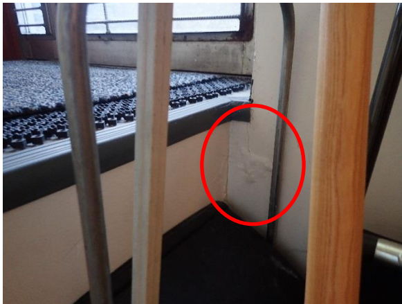
7.3 Oven viereisessä maanvastaisessa ulkosei- nässä kosteusjälkiä (tuulikaappi 065)
