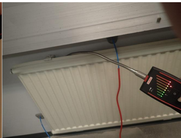
9.14 Ulkoseinällä sijaitsevan patterin kannakkeesta pistemäinen ilmavuotoreitti
