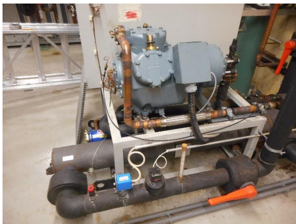
13.51 Vedenjäähdytyskoneen kompressorin ja höyrystin.
