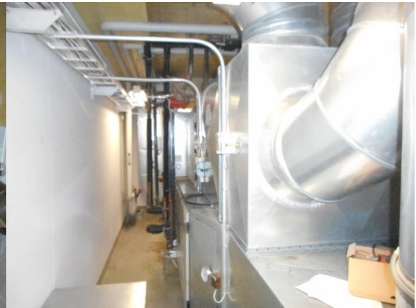
13.35 Ilmastointikone 4 TK1/PK1 pohjakerroksessa sijaitsevassa IV-konehuoneessa.
