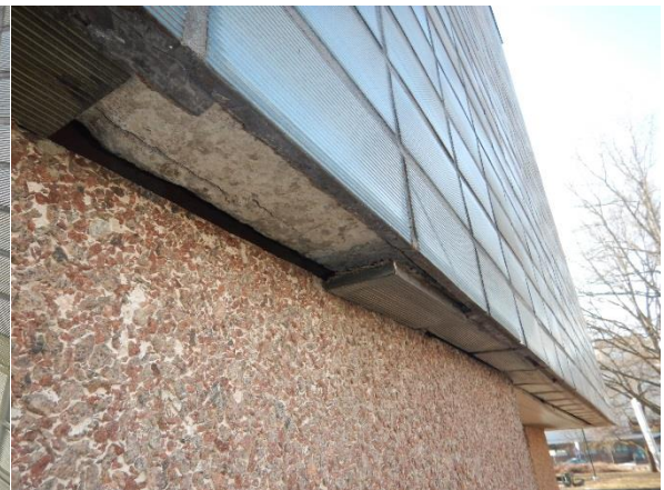
9.6 Julkisivuelementin klinkkerilaattoja irronnut kokonaan tai osin
