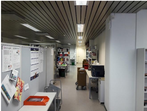
13.38 Ilmastoinnin päätelaitteita pohjakerroksen avotoimistossa.
