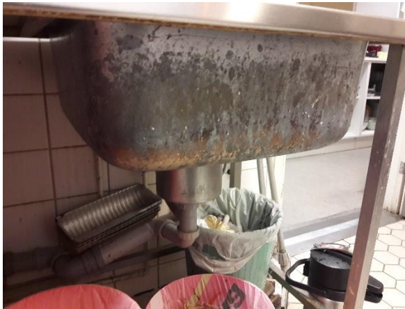
13.24 Keittiön pesualtaan ulkopinta on hapettunut.
