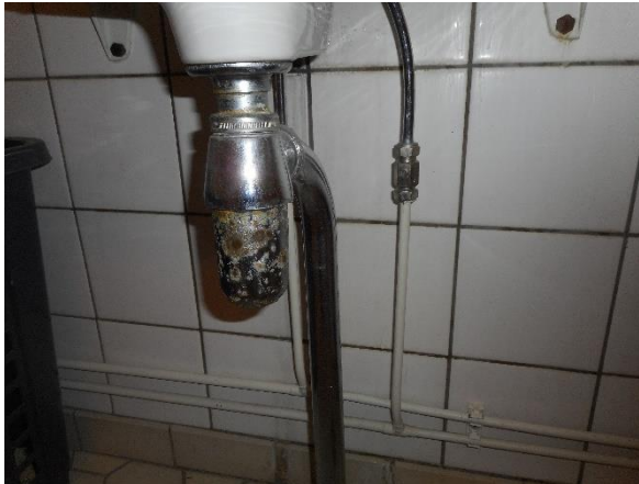
13.26 WC-tilan hapettunut vesilukko.
