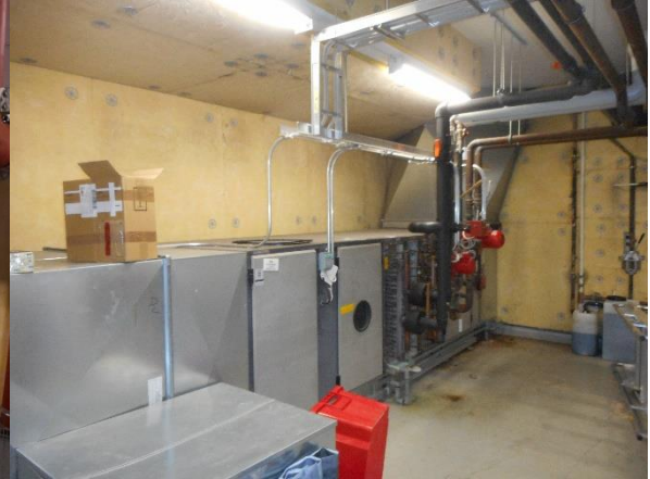
13.49 Teknisen tilan seinät on verhottu pinnoitetulla mineraalivillalla.
