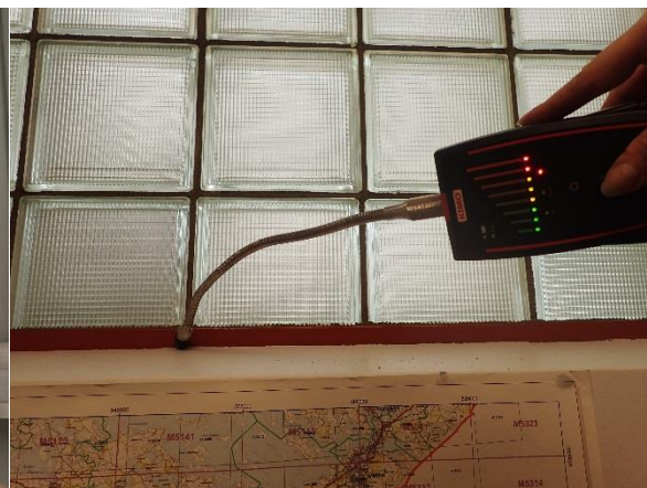
9.12 Ulkoseinärakenteen ja lasitiili ikkunan liittymästä pistemäisiä vuotokohtia
