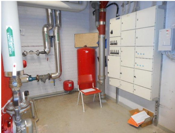
13.3 Teknisessä tilassa olevat PV- ja IV-lämmön-siirtimien paisunta-astiat.
