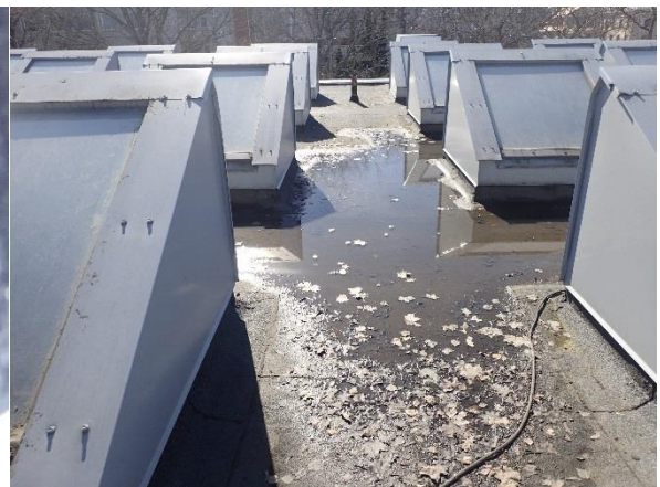
12.4 Vesi lammikoitunut katolle useamassa kohdassa
