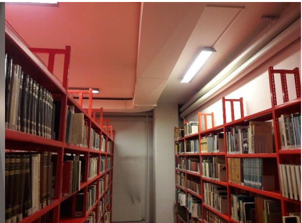
13.45 Kirjastovaraston näkyvissä olevat kanava-asennukset ovat valkoiseksi maalattua kanttikanavaa.
