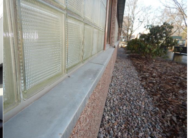
9.4 Lasitiili ikkunoiden pellitykset loivia ja ikkunoiden liittymät epätiivitä
