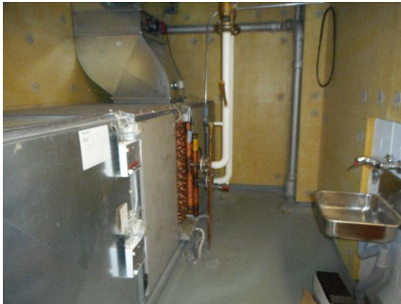
13.34 Ilmastointikone 3 PK1 pohjakerroksessa sijaitsevassa IV-konehuoneessa.
