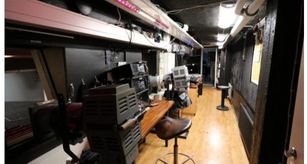
Kuva 35. Valo- ja äänitekniikkatiloja pääsalin parvella.
