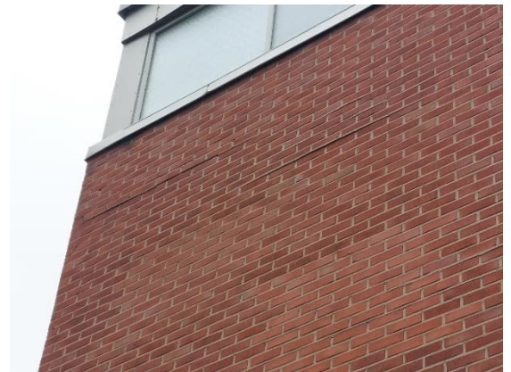
Kuva 7. Muuraussaumojen irtoamista, ja lisäksi julkisivussa on värieroja.
