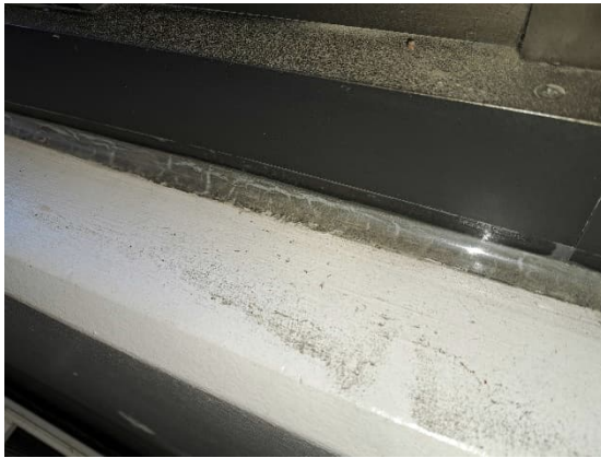
Kuva 40. Asuntolakerroksessa ikkunaliittymää on tiivistetty teipillä, mutta lopputulos ei vastaa nykyajan laatuvaatimuksia tiiveydestä.
