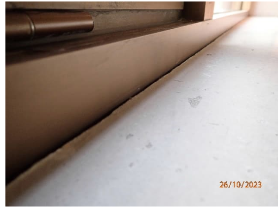
Kuva 41. Monin paikoin ikkunaliittymät vaikuttavat jo silmämääräisesti arvioiden epätiivailtä.
