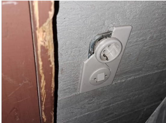
Kuva 100. Sähköjärjestelmissä on puutteita.
