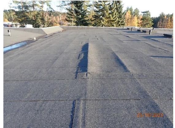
Kuva 71. Vesikatteen pinnassa näkyy säännönmukaisia kohoumia
