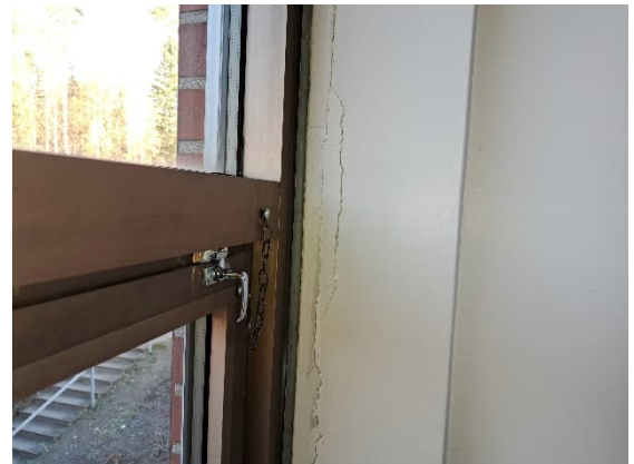
Kuva 29. Asuntolakerroksen päädyssä, ikkunasmyygissä halkeilua.
