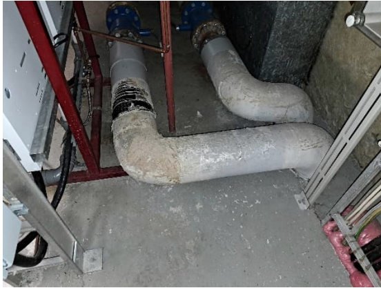
Kuva 98. Ilmanvaihtokonehuoneessa olevat huonokuntoiset putkieristeet voivat aiheuttaa asbestialtistusriskin.
