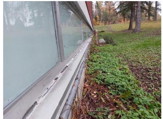
Kuva 47. Kellarikerroksen ikkunoita on ummistettu eristelevyllä, elastiset saumat huonokuntoisia.
