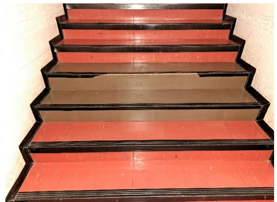
Kuva 85. Portaiden vinyylilaattapinnoitteet ovat jo kuluneet.
