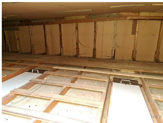
Kuva 66. Salin alakaton yläpuolinen tila, valaisimet vaihdetaan tätä kautta.
