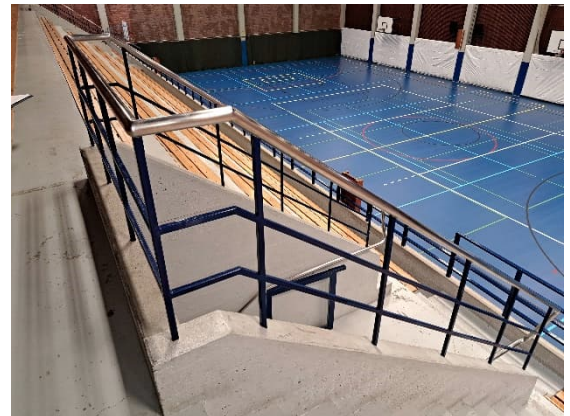
Kuva 103. Katsomossa ei ole esteetöntä ratkaisua, kaiteet ovat harvarakenteiset ja siten vaaralliset lapsia ajatellen.
