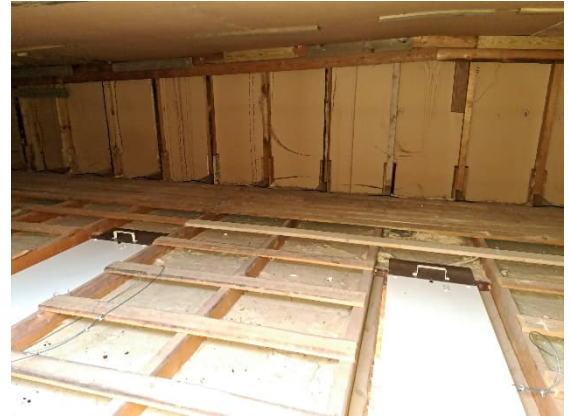
Kuva 69. Päätyseinän levytyksessä näkyy myös kuivuneita kosteusjälkiä.
