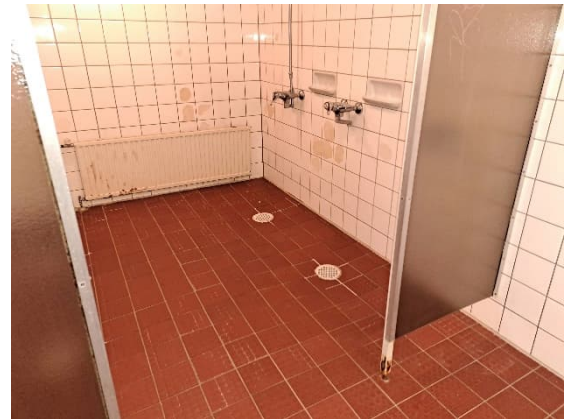
Kuva 91. Osassa pesuhuoneita seinälaatat ovat huonokuntoisia.
