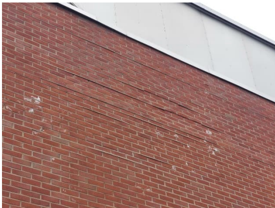
Kuva 6. Julkisivumuurauksessa näkyy muuraussaumojen irtoamista, sekä valkoista kalkkihärmää.
