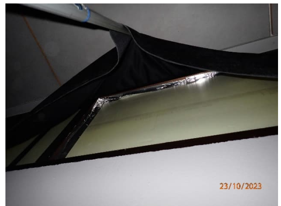
Kuva 49. Keilahallin ikkunoita on ummistettu sisäpuolelta eristelevyllä.
