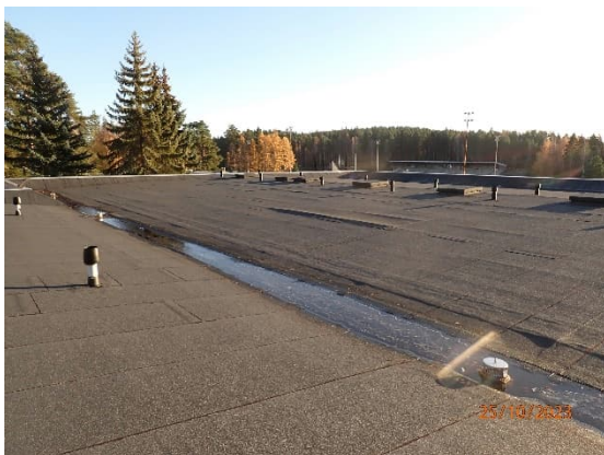
Kuva 72. Veden lammikoitumista vesikatton kourualueilla.
