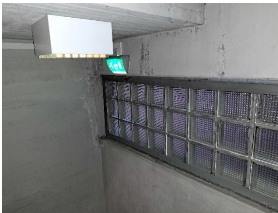
Kuva 26. Maanvastaisessa seinässä, sisääntulon alapuolella havaittiin kosteuden aiheuttamia vaurioita. Pintakosteus normaali.
