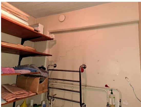
Kuva 30. Asuntolakerroksessa siivoustilan muuratussa väliseinässä halkeilua.
