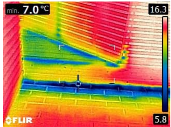
Kuva 65. Edellisen kuvan kohta kuvattuna lämpökameralla.
