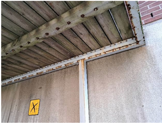
Kuva 8. Liikuntasalin hätäpoistumistien rakenteissa on ruostetta.
