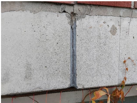
Kuva 12. Julkisivun elastiset saumat ovat ikääntyneet.
