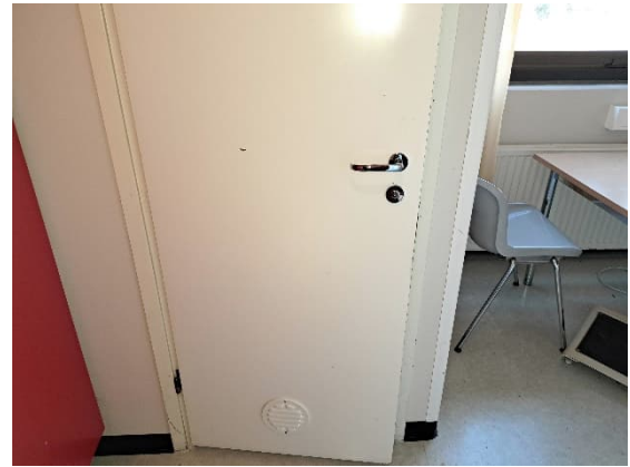
Kuva 2. Myös wc-tilojen ovissa on siirtoilmasäleiköt. Ovet ovat välttävässä kunnossa.
