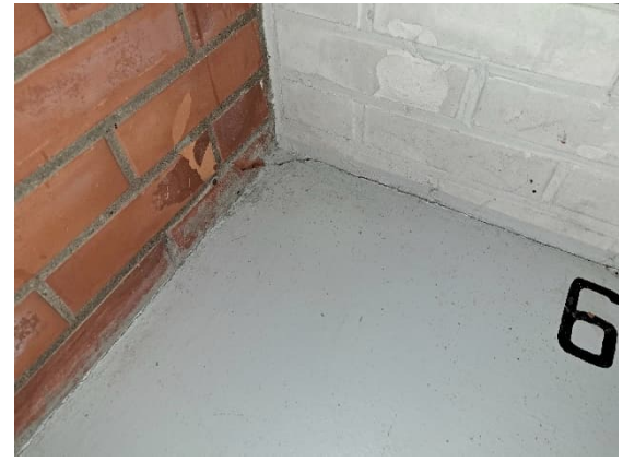
Kuva 39. Katsomorakenteen liittymissä väli- ja ulkoseinään on halkeilua.
