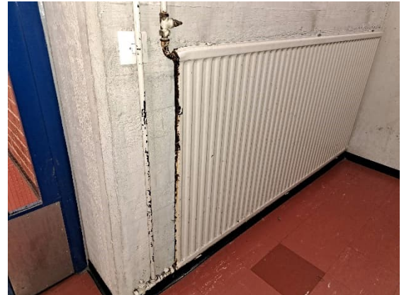
Kuva 101. Lämmityspatterissa on ruostetta.
