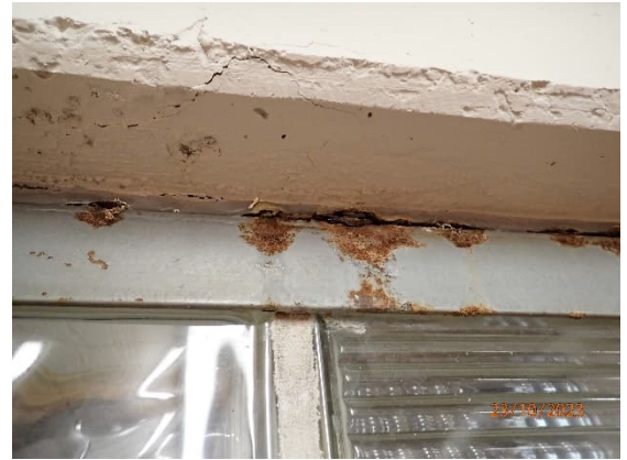
Kuva 53. Lasitiili-ikkunoiden teräskarmissa on ruostetta ja laastisaumoissa kalkkihärmää.
