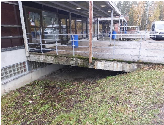
Kuva 10. Sisääntulosillan betonirakenteessa on sammaloitumista ja merkkejä veden kulkeutumisesta rakenteen läpi. Teräsrakenteissa on ruostetta.
