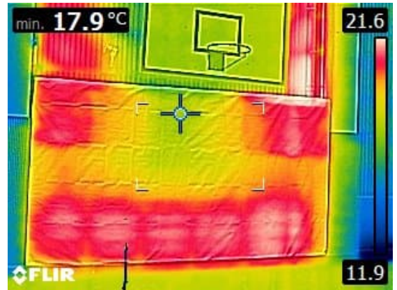
Kuva 83. Lämpökamerakuvan perusteella lämmityspatterin on jätetty pressun taakse.
