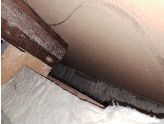
Kuva 68. Salin päädyssä julkisivumuuraus jää liimapuupalkin taakse, kylmäsilta.
