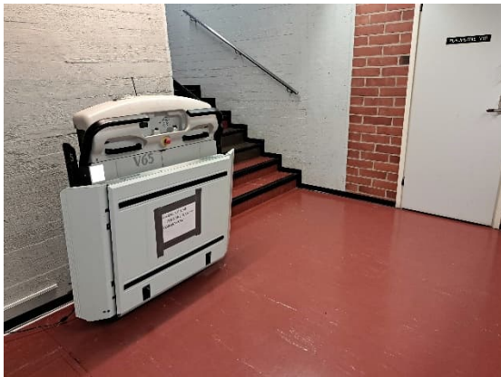
Kuva 102. Esteettömyyttä varten asennettu hissi kerrosten välille.
