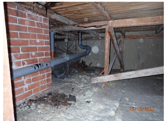
Kuva 79. Matalamman katto-osan yläpohjatila, eristeenä on lasivillaa. Viemärien tuuletusputket ovat eristämättömiä.
