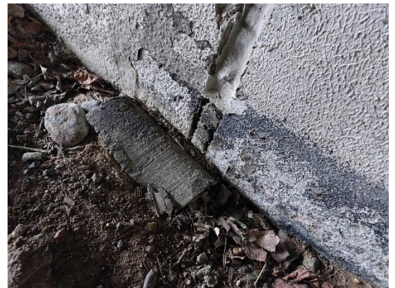
Kuva 13. Sokkeliementtien saumoissa on huonokuntoiset bitumikermitiivisteet.
