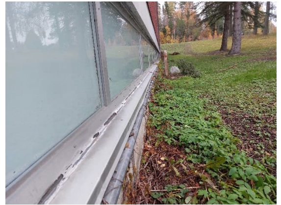
Kuva 9. Ikkunaliittymien elastiset saumaukset ovat huonokuntoiset.
