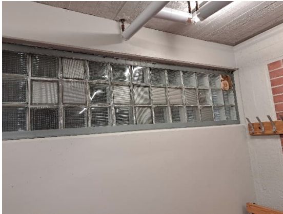
Kuva 52. Lasitiili-ikkunaa, osa tiilistä on vaihdettu.
