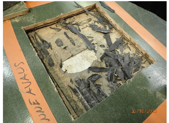
Kuva 23. Rakenneavaus RAK1, joustomuovikerros on murtunut kappaleiksi.
