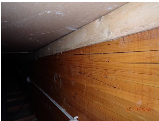
Kuva 78. Liimapuupalkkien saumoissa oli paikallisia halkeamia.
