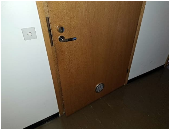
Kuva 1. Asuntolakerroksen ovissa on siirtoilmasäleiköt. Huoneiden ulko-ovet ovat tyydyttävässä kunnossa.
