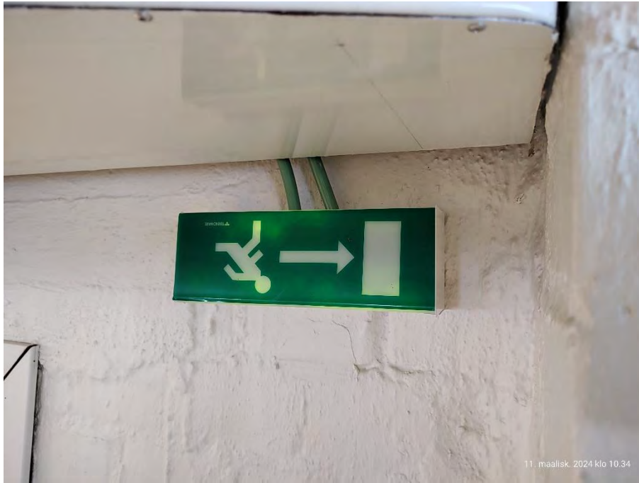
Kuva 42. Päiväkodin yhden poistumistievalaisimen opaste on väärin päin (ns. väärän kätinen).
