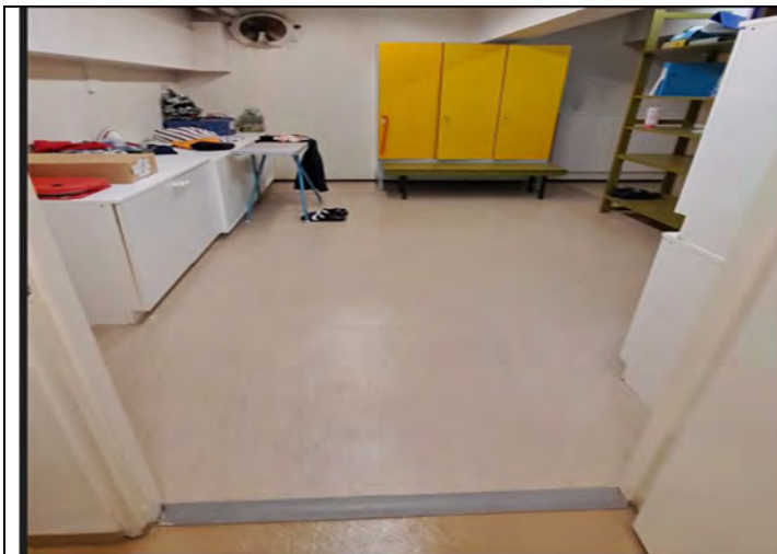
Keittiön sosiaalityötilat, jossa on aistinvaraisesti havaittavissa poikkeavaa tuoksua.
