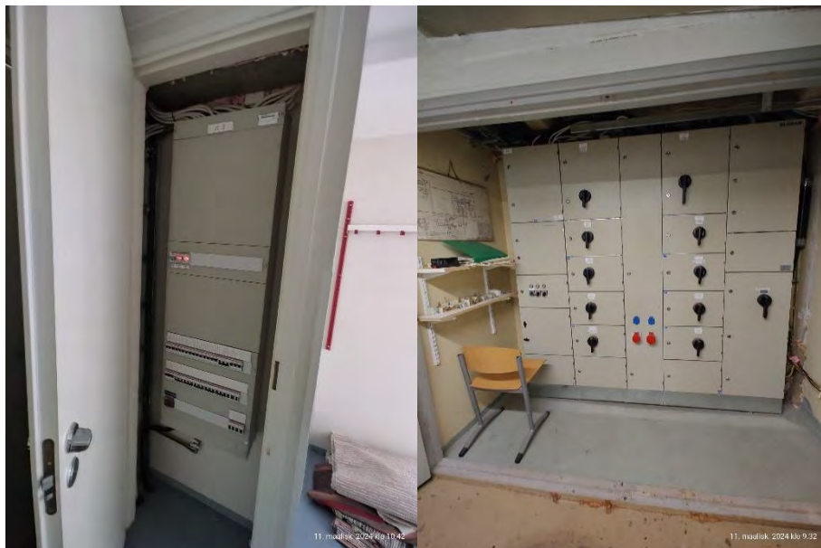
Kuva 27. Päiväkoti rakennuksen jakokeskusmalli v.1999 ja koulun pääkeskus v.2001.
