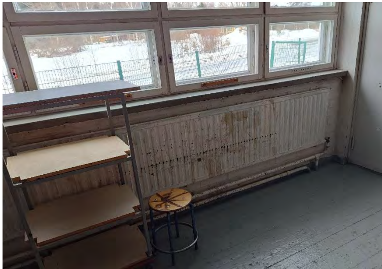
Kuva 6. Lämmityspatterissa ulkopuolisista tekijöistä aiheutunutta likaa.
