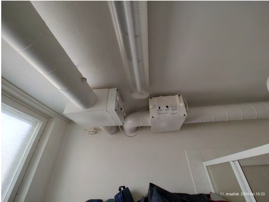
Kuva 37. Koulurakennuksessa on käytössä sähkötoimisia Vallox- tuloilmalämmittimiä 4 kpl.
