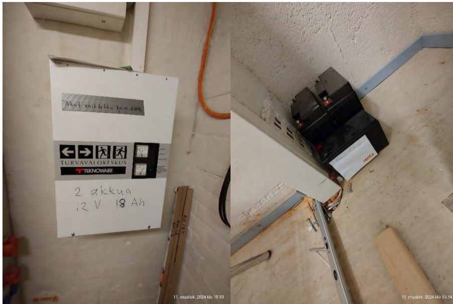
Kuva 43. Päiväkodin vanhempi turvalokeskus. Akut on uusittu 3/2024. Vanhat akut oli jätetty lattialle, ne tulisi hävittää/kierrättää asianmukaisesti.
