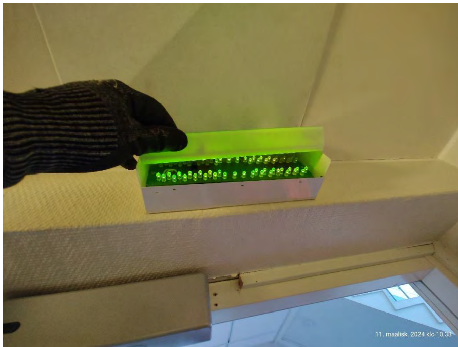
Kuva 41. Opastevalaisimet ovat pääosin LED-tekniikkaa, tekninen käyttöikä on noin 10 vuotta.
