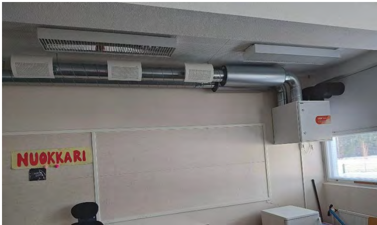
Kuva 17. Ilmanvaihtokone TK/PK2 kanavistoineen (Pääkoulu, nuorisotila)
