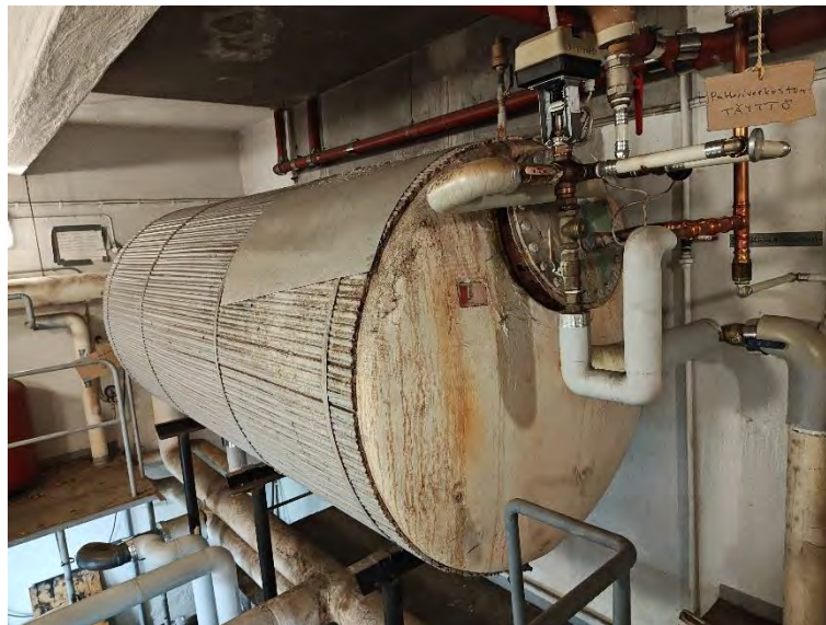
Kuva 10. Lämminvesivaraaja öljylämmityskeskuksen päällä.
