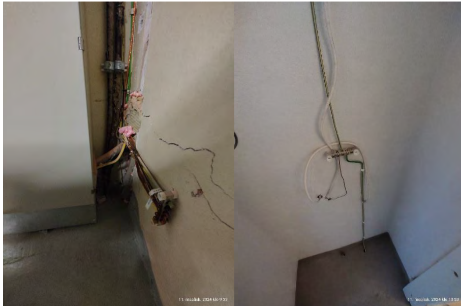
Kuva 31. Rakennusten maadoitusmerkintöjen päivitys on aiheellista.
