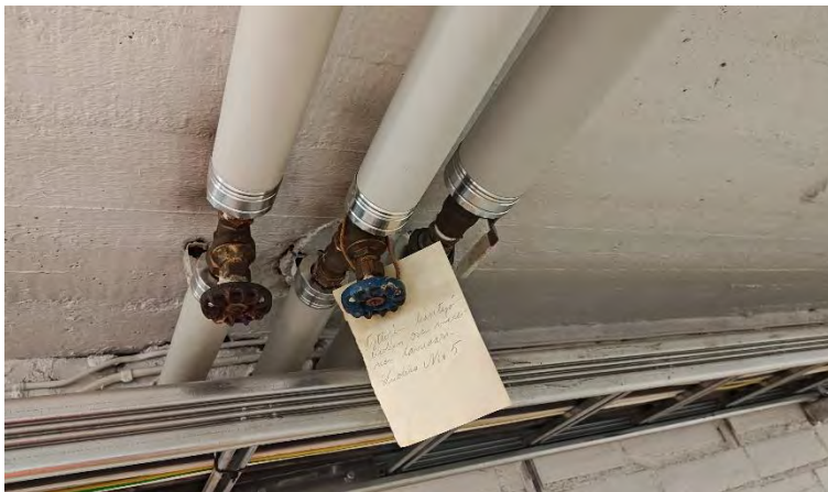
Kuva 5. Lämmitysverkoston venttiilit vaikuttivat huonokuntoisilta.
