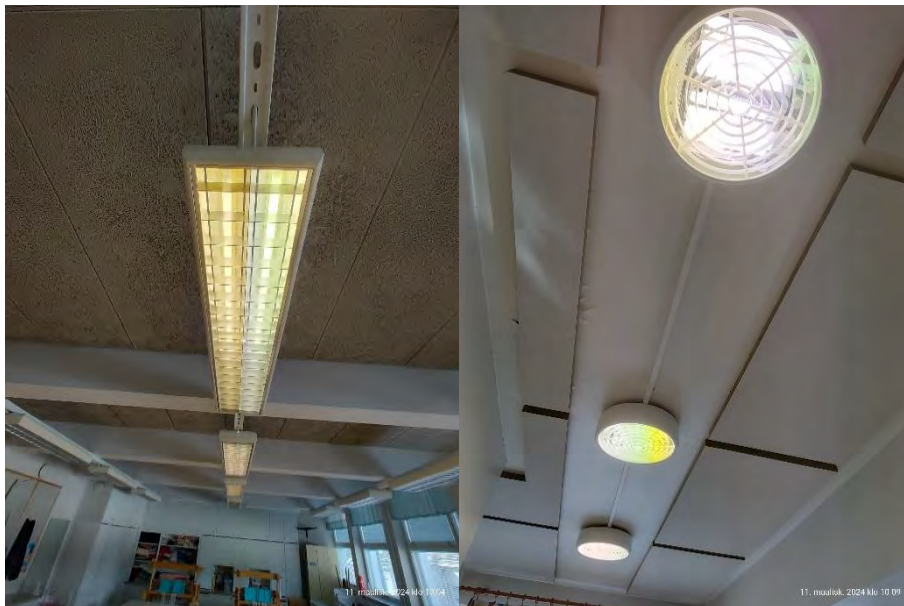
Kuva 35. Koulurakennuksen valaisinmalleja (Lp ja Plp). Valaistuksessa havaittiin paikoin sävyeroja.
