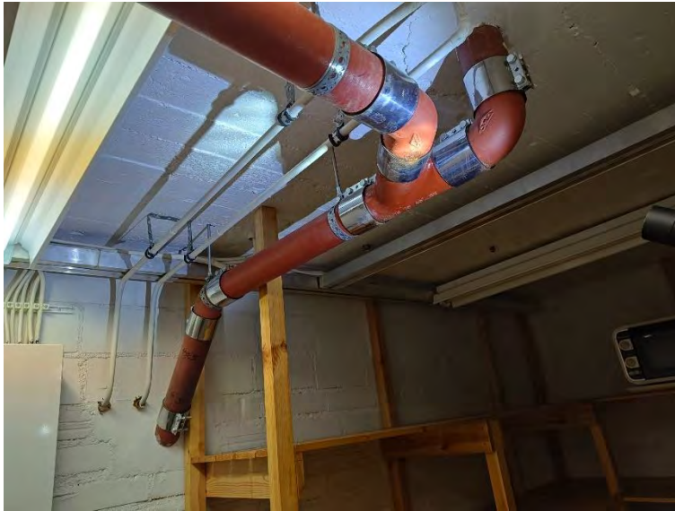
Kuva 14. Saneerausvuoden valurautaviemäreissä vanhoja vuotojälkiä sekä korroosiota.
