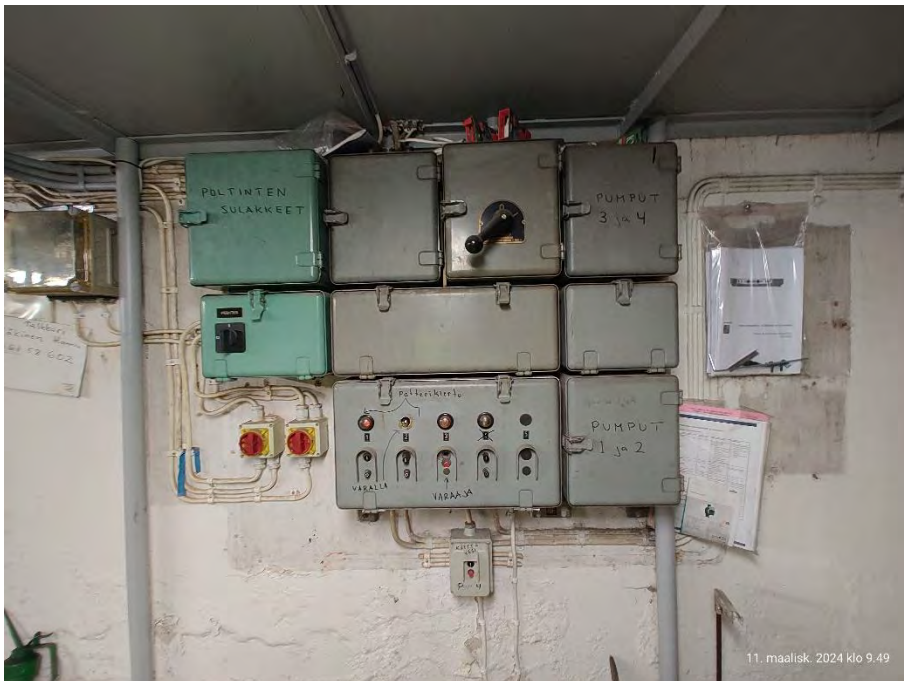
Kuva 25. Koulurakennuksen lämmönjakuhuoneen alkuperäinen ohjauskeskus 1960- luvulta.
