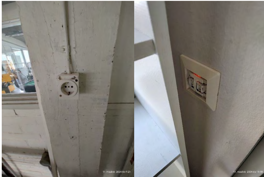
Kuva 32. Sähkökalusteissa havaittiin paikoin pieniä vikoja, jotka tulee korjata pikaisesti.
