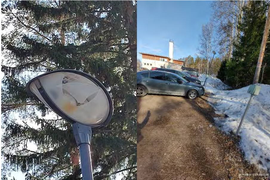
Kuva 21. Pylväsvalaisimen kupu rikki. Lämmitys- ja valalaisin tolppien suoritus on paikoin aiheellista.
