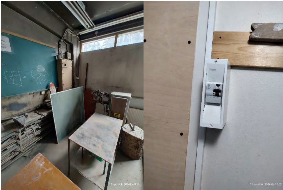
Kuva 22. Keskusten edessä paikoin tavaraa. Merkitsemätön vikavirtasuoja siivoustilassa.
