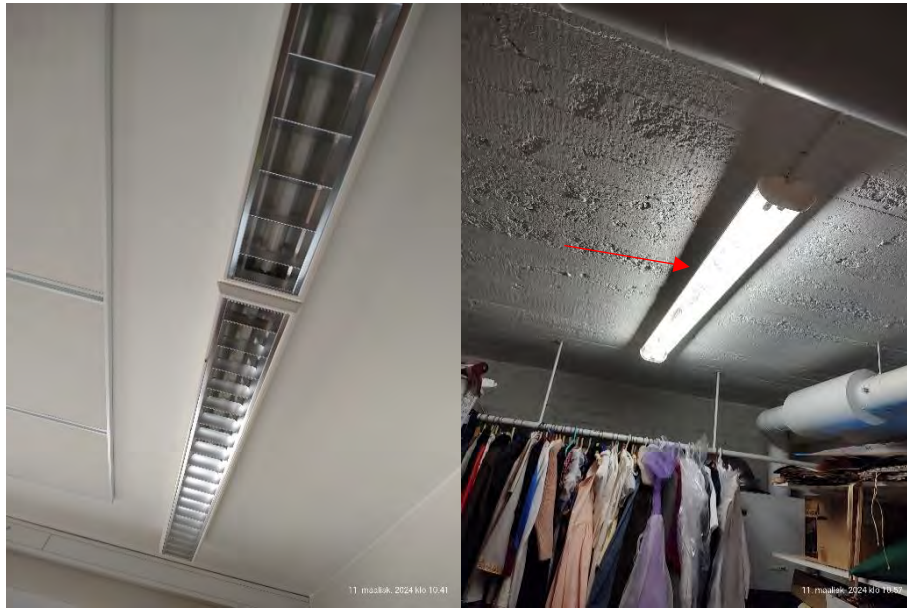
Kuva 36. Päiväkoti rakennuksen valaisinmalleja (Lp). Osasta puuttuu suojakupu.
