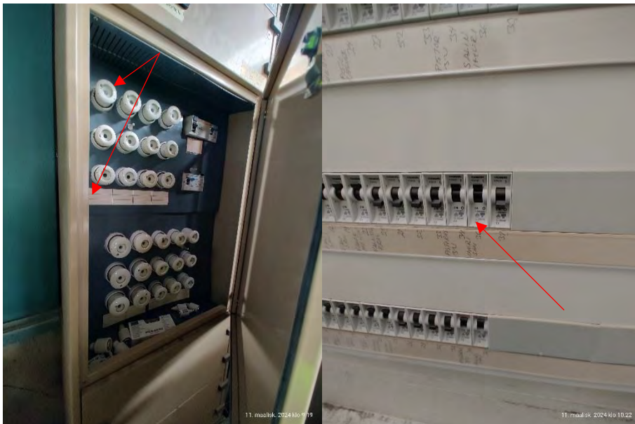
Kuva 23. Keskusten sulakemerkinnöissä havaittiin paikoin puutteita. Keskusten huoltoa ja lämpökuvauksia suositellaan.
