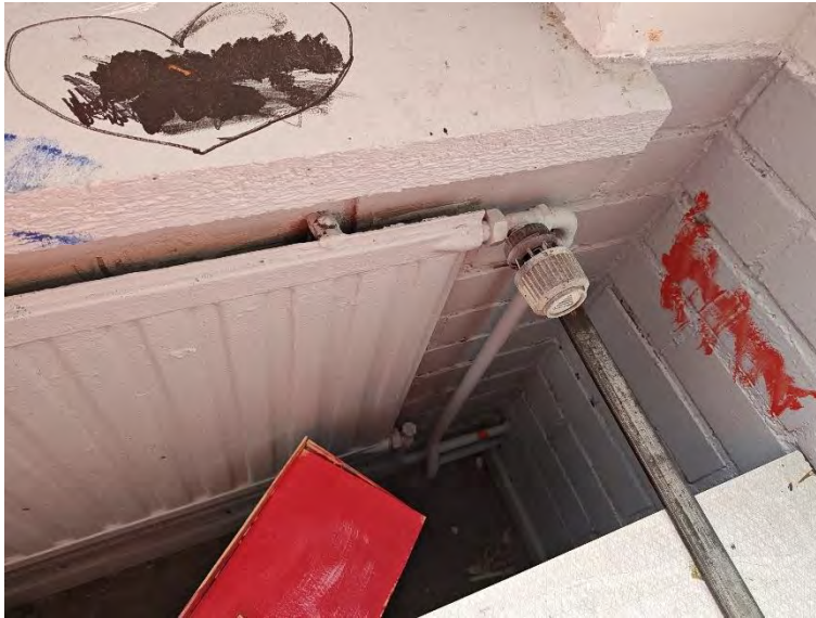
Kuva 7. Alkuperäinen lämmityspatteri sekä termostaattiventtiili työpajassa.
