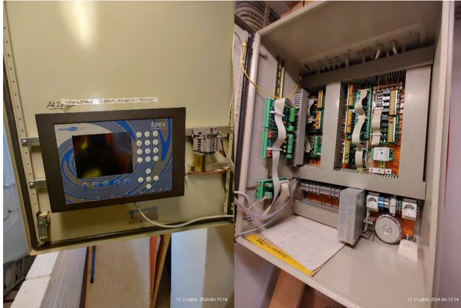
Kuva 45. Koulurakennuksen valvonta-alakeskus (TAC/Schneider). Säätimen paristo vaihdettu 9/2023.
