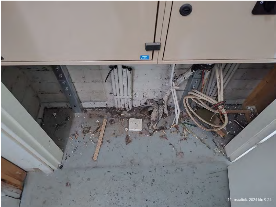
Kuva 24. Keskustilojen siivous on paikoin aiheellista.
