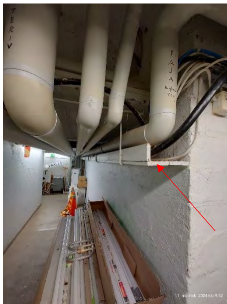
Kuva 28. Koulurakennuksessa vanhoja puisia kaapelihyllyjä vielä käytössä (paloturvallisuus).
