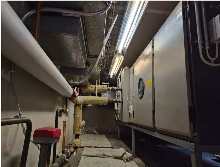
Kuva 16. Ilmanvaihtokone TK/PK1 (Pääkoulu, liikuntahalli ja ruokala)
