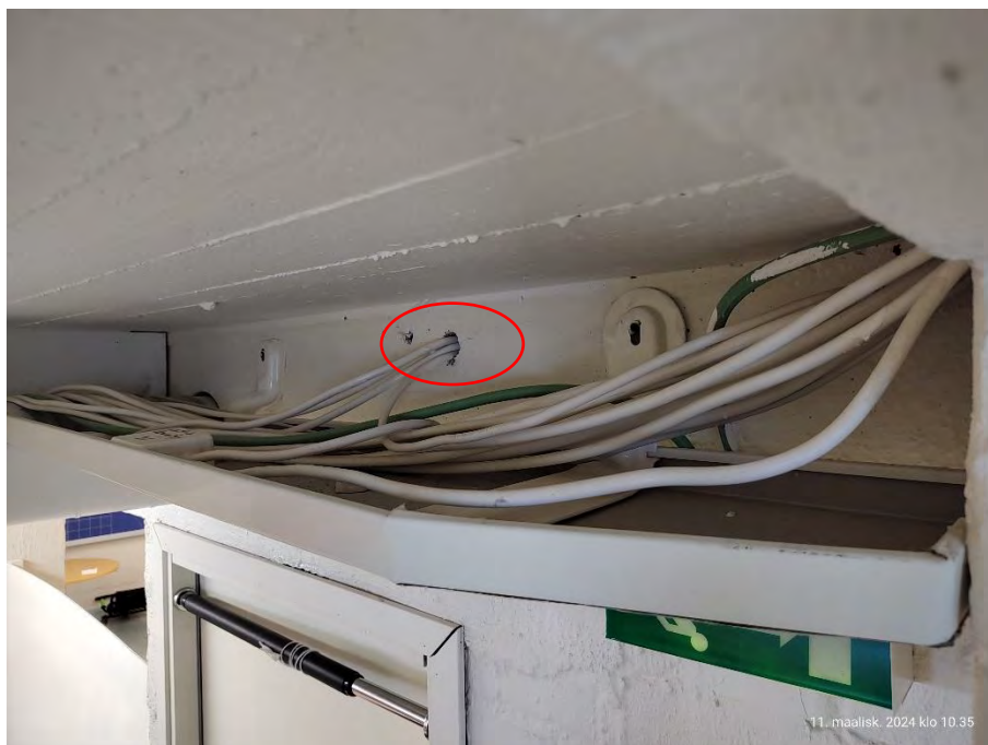
Kuva 30. Kaapeleita ei ole kaikilta osin suojattu mekaanista rasitusta vastaan läpivientien kohdalla.
