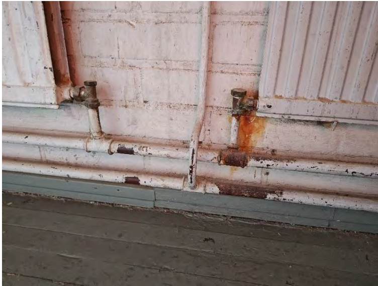
Kuva 4. Lämmitysverkoston putkistoissa vanha vuotojälki sekä pintakorroosiota.
