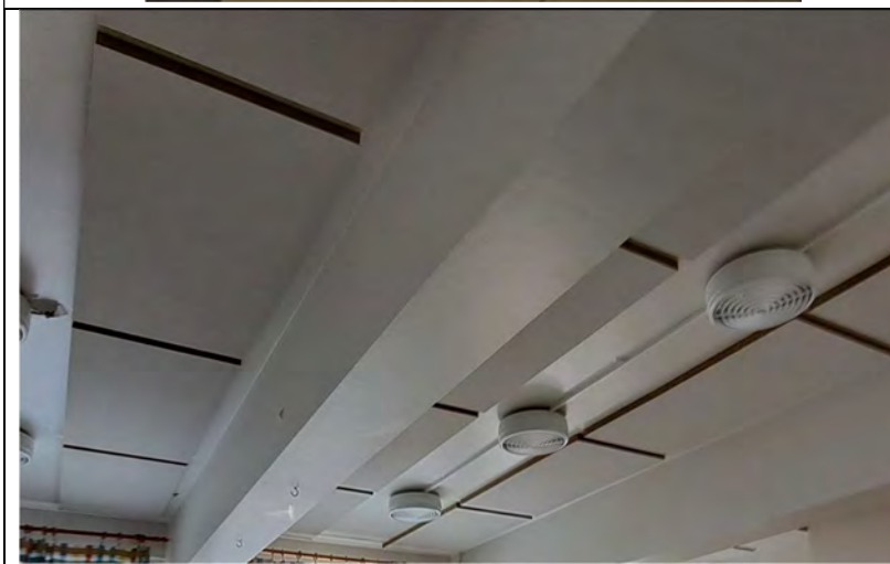
Reunapinnoiltaan pinnoittamattomat akustiikkalevyt ruokalan sisäkaton pinnalla. Kyseiset akustiikkalevyt ovat mineraalivilla lähteitä.
