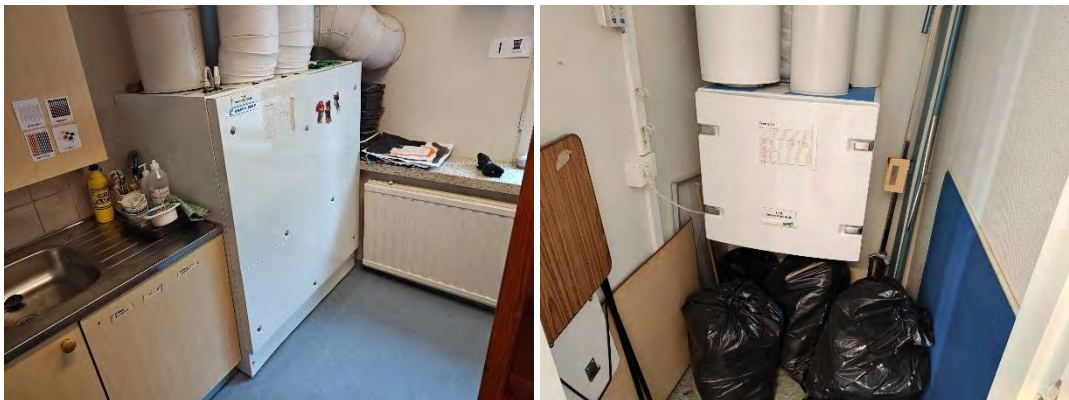
Kuva 18. Ilmanvaihtokoneet TK/PK3 ja 4 (Päiväkoti).
