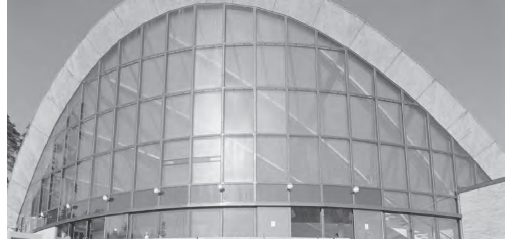
Osasuurennos viereisestä valokuvasta. Lasiseinän yksitiskohtia. Vaaka- ja pystysuuntaiset ikkunaseinän runko-/puittejakojen liitoskohdat muodotavat viisteytetyn kennomaisen yksityiskohtan. Vaakajajon profiilit ovat saman levyiset. Lasiseinällä olevissa valaisimissa on yläpuoliset varjostimet. Kuvat: Museovirasto. Valokuva Teuvo Kanerva, 1966 .
