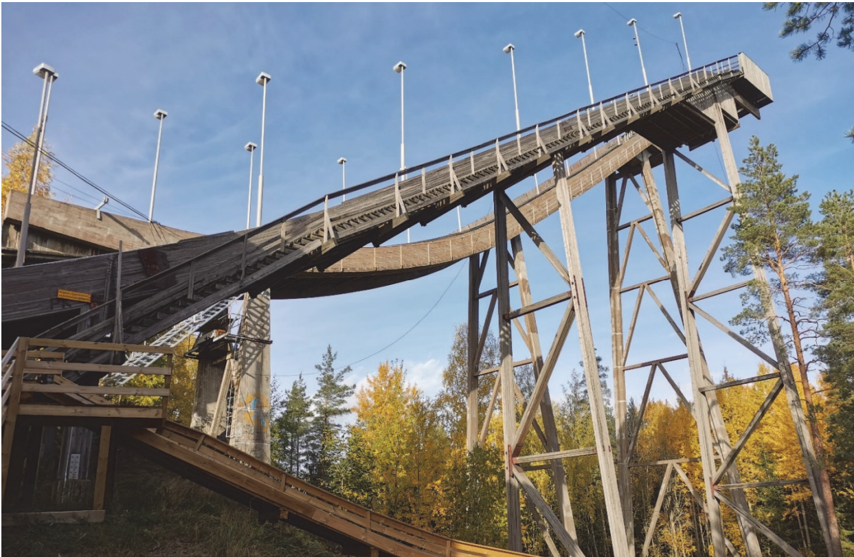
Kuva 19. Näkymä hyppyrimäkien juurelta. Etualalla puinen K58 ja taka-alalla betoninen vuonna 1961 käyttöön otettu K75 mäki
