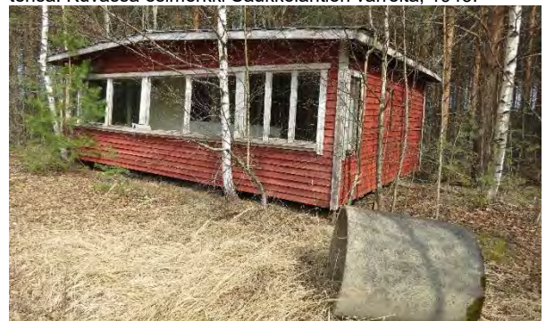
Kuva 97. Saksan raviradan alueen vanha huoltorakennus on huonokuntoinen.
