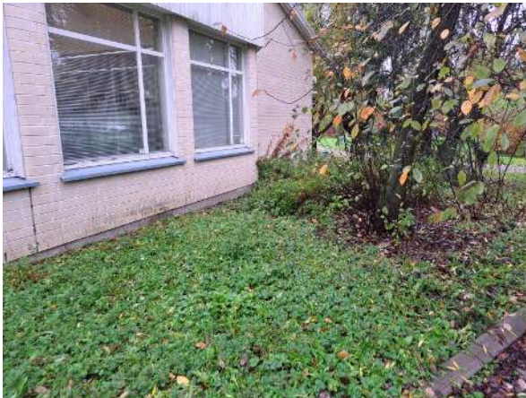
9. Kasvillisuus on liian lähellä rakenteita.
