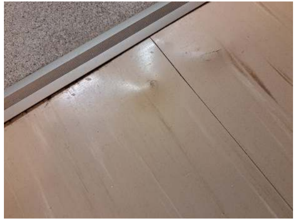
30. Maanvastainen alapohjarakenne. Paikoin lattioissa kohoumia.
