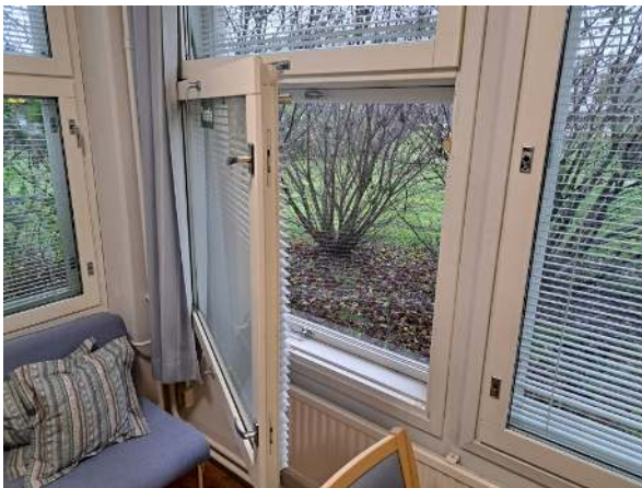
47. Ikkunoiden mekasmisseissa ei havaittu vaurioita.
