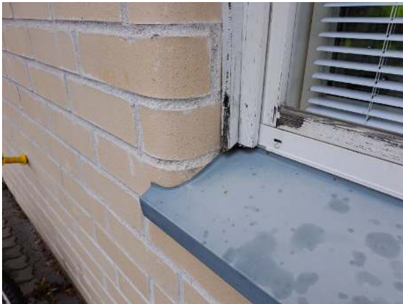
49. Vesipeltien tiivistyksissä havaittiin puutteita.
