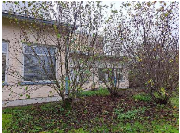
12. Kasvillisuus on liian lähellä rakenteita.
