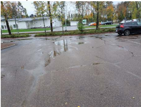
17. Pihapäällysteissä on havaittavissa painumaa.
