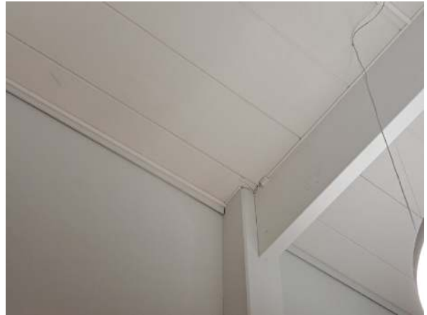
32. Siporex -laatan halkeama nurkassa kirjaston osalla.
