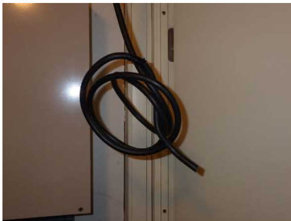
137. Käytöstä poistetut sähköjohdot tulee rasioida tai poistaa kokonaan.
