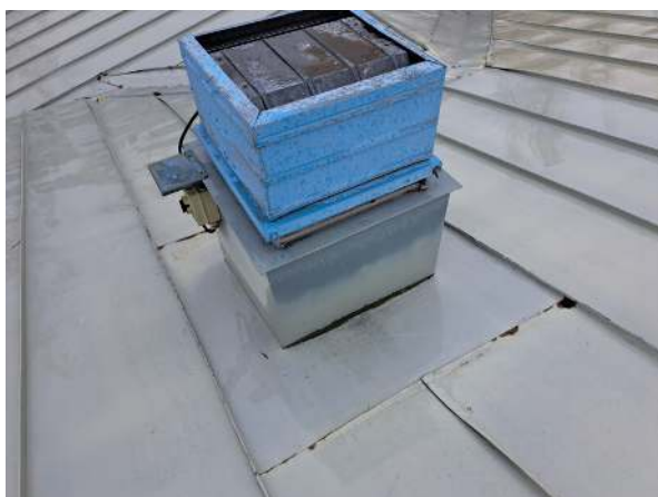
61. Läpivientipellitystä. Kaulus on epätiivis.
