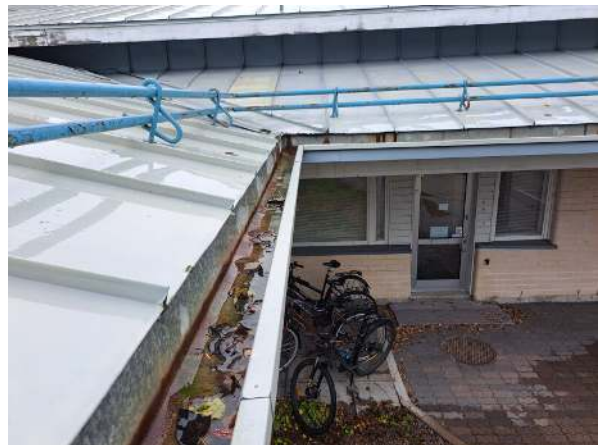
58. Vesikourua ja lumiestettä. Havaittavissa ruostetta.
