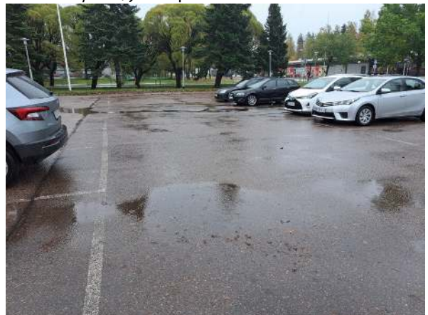
18. Pihapäällysteissä on havaittavissa painumaa.
