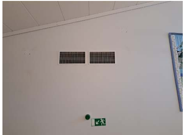
114. Kirjaston ylätasolle kantautuu voimakasta ääntä ilmanvaihtokoneesta.
