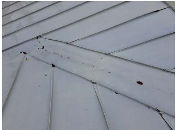
60. Vesikaton pinnoite irtoaa.
