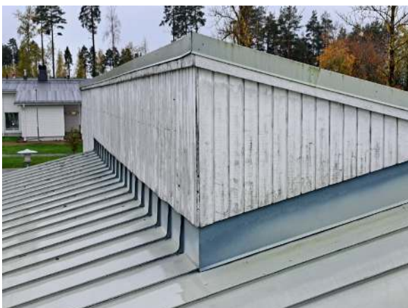
39. Puuverhoilua vesikatolla, jossa kulumaa.
