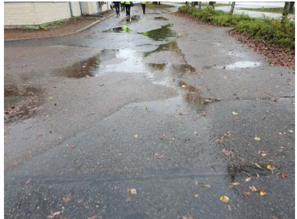
14. Pihapäällysteissä on havaittavissa painumaa.
