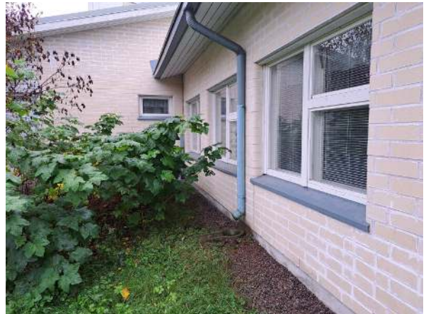
10. Kasvillisuus on liian lähellä rakenteita.
