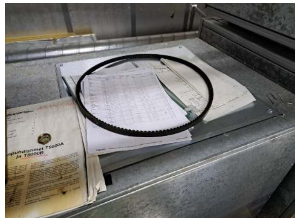
105. Ilmanvaihtokoneet ovat hihnakäyttöisiä.
