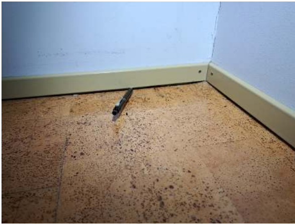
29. Maanvastainen alapohjarakenne. Ulkoseinän ja lattian välissä rakoa.
