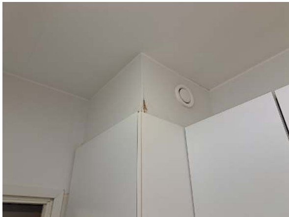
1. Mäyrien wc-tilan hormin yläosassa vanhat kosteusjäljet.
