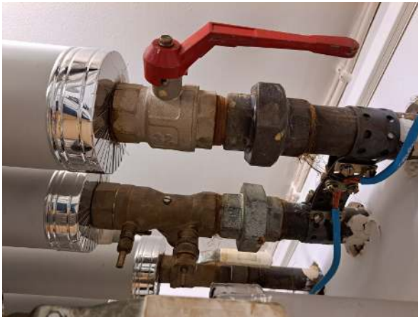
94. Linjasäätö- ja sulkuventtiilipari.
