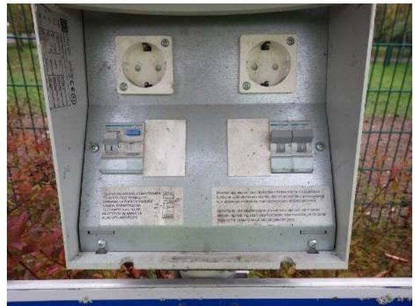
124. Uusittu autolämmityspistorasia (kannet tulisi pitää aina lukittuina).
