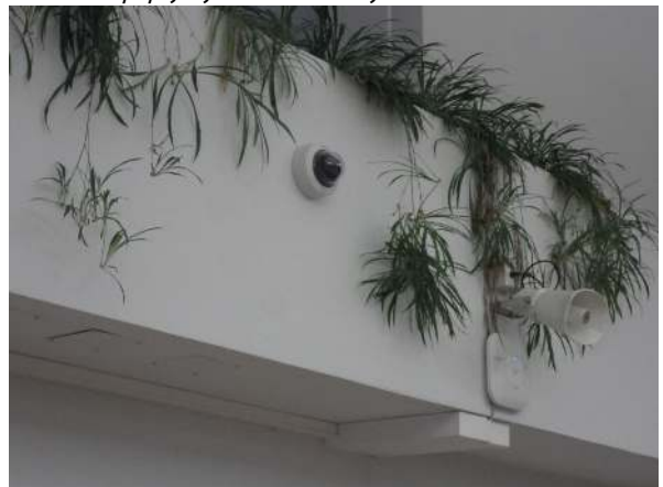
158. Äänentoistojärjestelmän kaiutin (ja dome-kamera).
