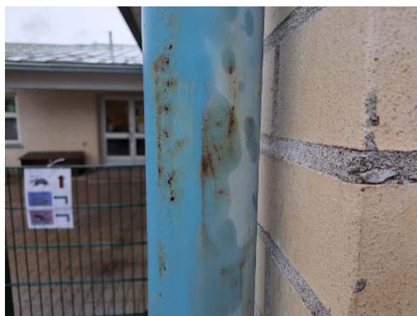
62. Myös syöksyputkissa on kulumaa.
