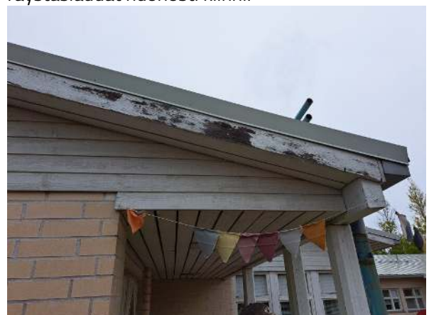
40. Päiväkodin osalla räystäässä vaurioita.
