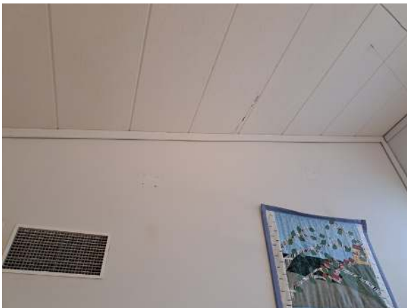
33. Siporex -laatan halkeama nurkassa kirjaston osalla.
