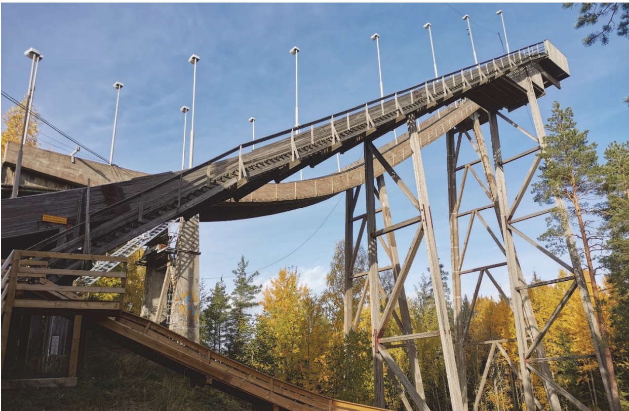
Kuva 19. Näkymä hyppyrimäkien juurelta. Etualalla puinen K58 ja taka-alalla betoninen vuonna 1961 käyttöön otettu K75 mäki
