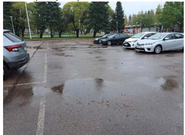
18. Pihapäälysteissä on havaittavissa painumaa.
