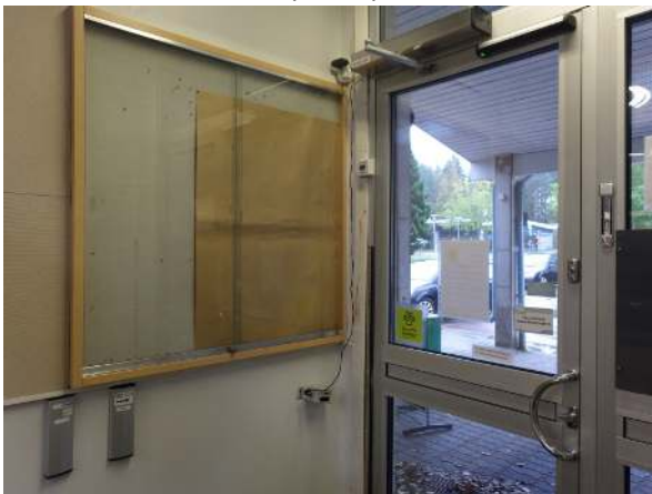
157. Ulko-oven sähköinen avauslaite.
