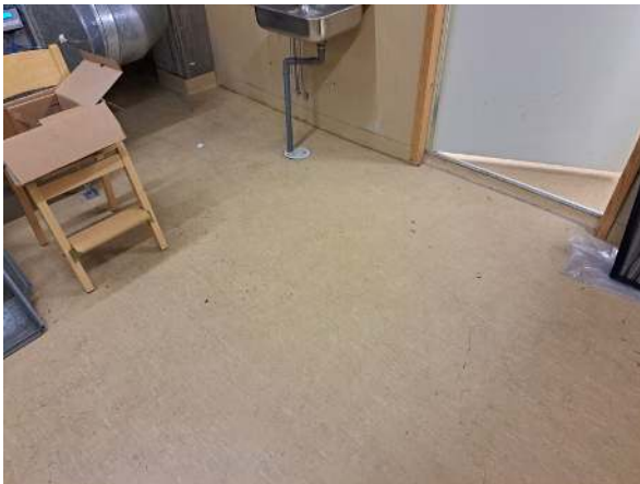
64. Ilmanvaihtokonehuoneen lattiassa muovimatto.
