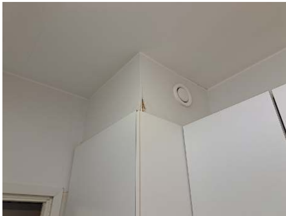
1. Mäyrien wc-tilan hormin yläosassa vanhat kosteusjäljet.
