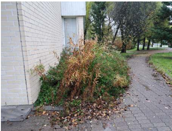
11. Kasvillisuus on liian lähellä rakenteita.
