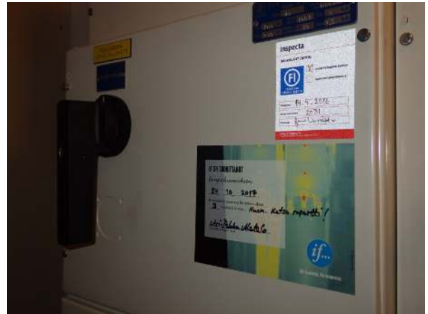
126. Sähköjärjestelmien määräaikaistarkastus ja keskusten lämpökamerakuvaus (suoritettu).
