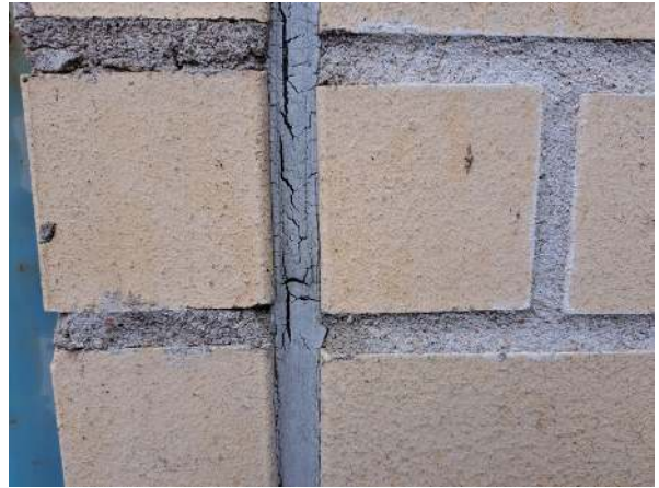
42. Elastisissa saumoissa vaurioita.
