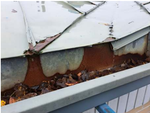
59. Kattopinnoite irtoaa erityisesti räystäällä.
