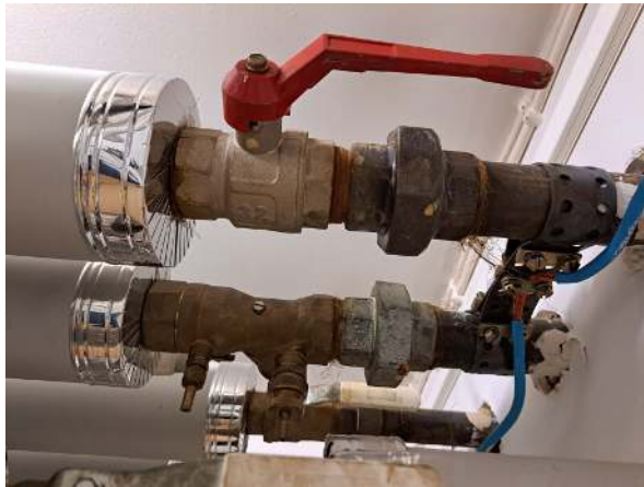
94. Linjasäätö- ja sulkuventtiilipari.
