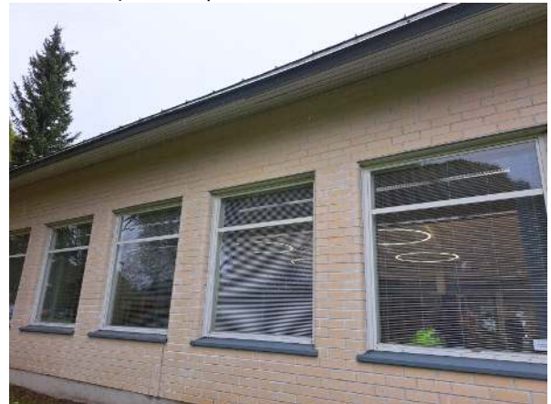
38. Kuvaa julkisivuista ja räystästä. Osin räystäslaudat huonosti kiinni.
