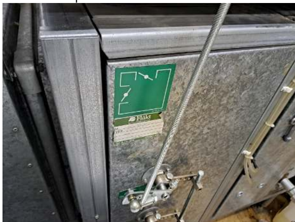
106. Ilmanvaihtokoneissa on kiertoilmapelit.
