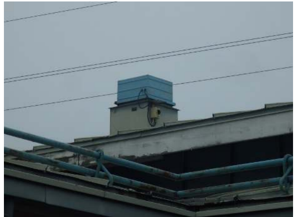
139. Ulkona oleva sähkökaluste (suojattu sateelta).
