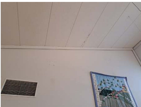
33. Siporex -laatan halkeama nurkassa kirjaston osalla.
