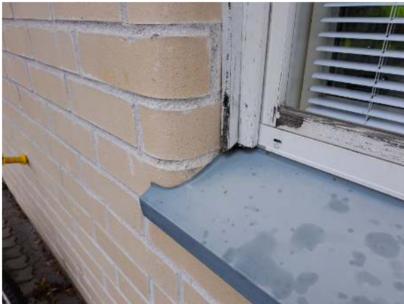
49. Vesipeltien tiivistyksissä havaittiin puutteita.
