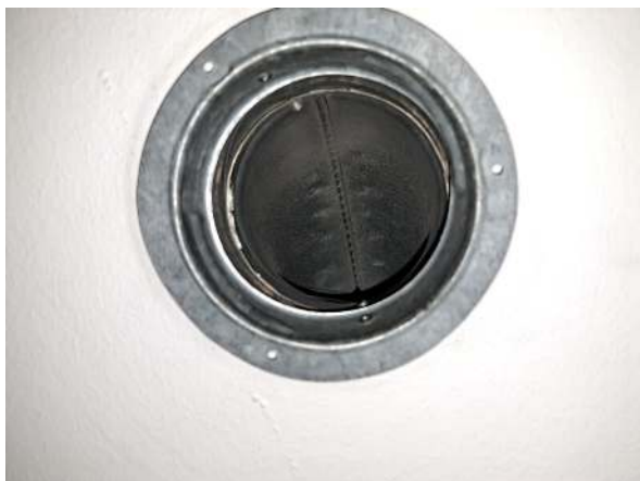
112. Poistokanava varsin puhdas.
