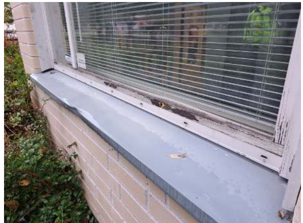
44. Vesipeltien kallistuksissa havaittiin osin puutteita. Ulkopinnat ovat kuluneita.
