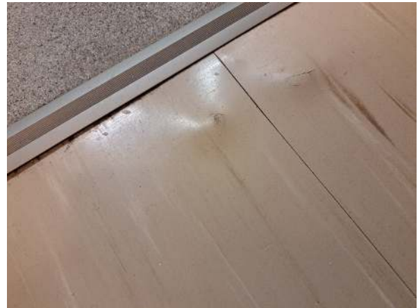
30. Maanvastainen alapohjarakenne. Paikoin lattioissa kohoumia.
