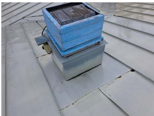
61. Läpivientipellitystä. Kaulus on epätiivis.
