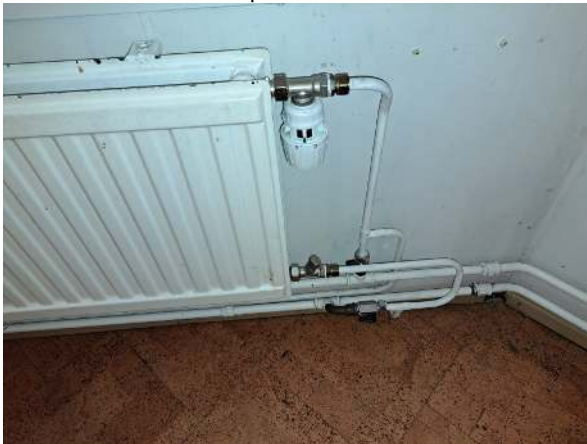
97. Termostaattinen patteriventtiili, uusittu päiväkodin salissa.
