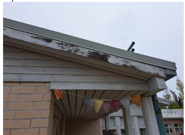
40. Päiväkodin osalla räystäässä vaurioita.
