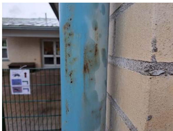
62. Myös syöksyputkissa on kulumaa.
