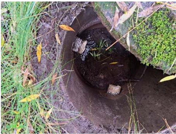
6. Salaojien tarkastuskaivo. Putket taipuneet.
