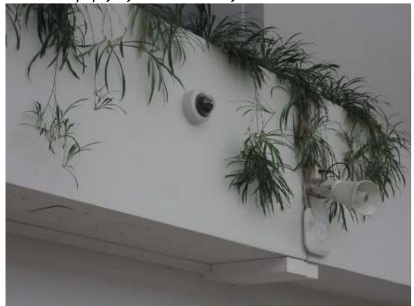
158. Äänentoistojärjestelmän kaiutin (ja dome-kamera).
