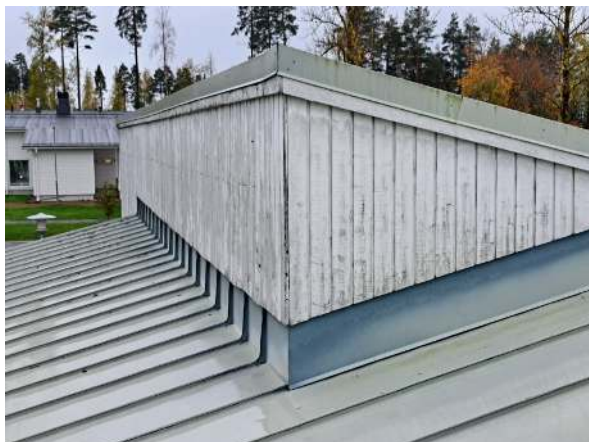
39. Puuverhoilua vesikatolla, jossa kulumaa.
