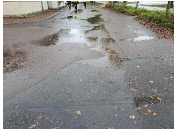
14. Pihapäälysteissä on havaittavissa painumaa.
