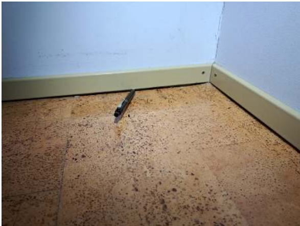
29. Maanvastainen alapohjarakenne. Ulkoseinän ja lattian välissä rakoa.
