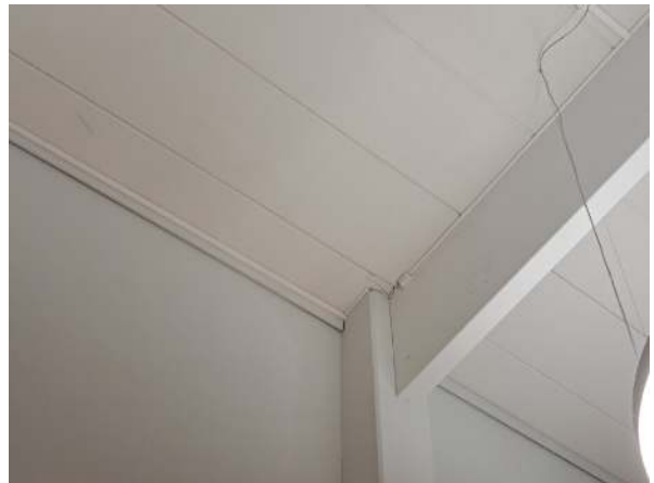
32. Siporex -laatan halkeama nurkassa kirjaston osalla.
