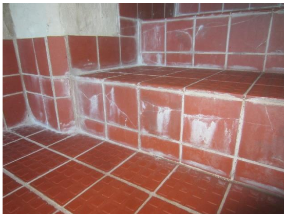
Kuva 40 Ison altaan ja lasten altaan välisessä portaikossa todettiin laattojen halkeilua.
