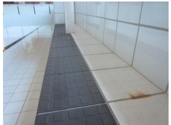
Kuva 16 Toinen ruoste jälki matalan pää- dyn portaassa.
