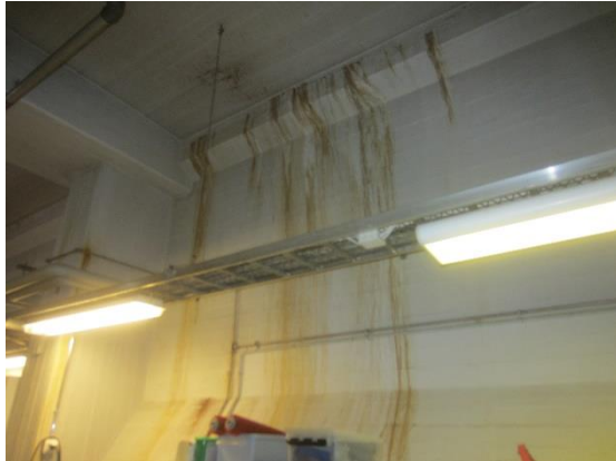
Kuva 19 Ison altaan ulkopuolelta oli havaittavissa vain vanhoja vuotojälkiä.
