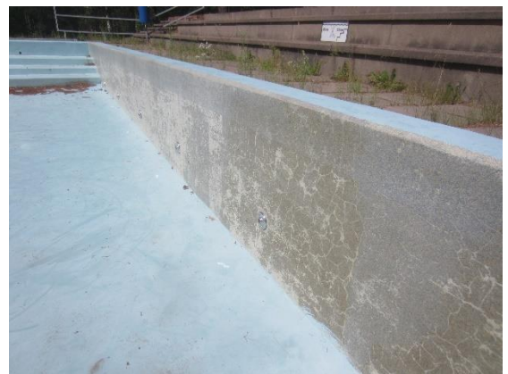
Kuva 53 Altaan seinäpinnoilla on nähtävissä verkkomaista halkeilua.
