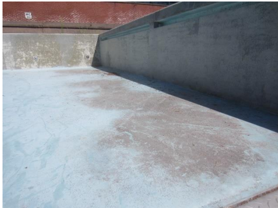
Kuva 54 Ulko-altaan pohjan pinnoitteet ovat kuluneet ja vaurioituneet.
