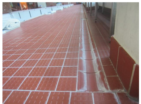
Kuva 43 Vesikourussa laattojen pintojen kalkkeutumista.
