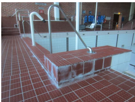
Kuva 42 Laatoitetuilla pinnoilla on nähtävissä paikallisesti pintojen kalkkeutumista.
