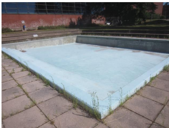
Kuva 52 Ulko-altaan pinnat ovat kuluneita
