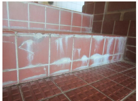
Kuva 41 Porraslaattojen halkeamista on nähtävissä kalkkivalumia.
