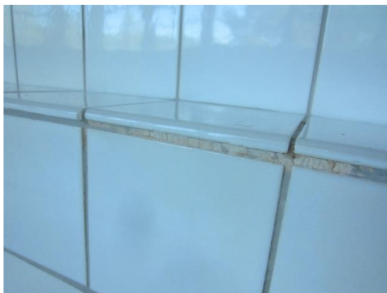
Kuva 17 Laattojen saumoissa todettiin vain yksittäisiä saumojen vaurioita.
