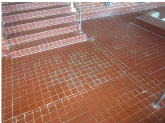
Kuva 36 Laatoituksia on uusittu paikalli- sesti molemmilla allastasoilla.
