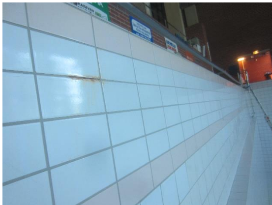
Kuva 15 Altaan seinässä yksittäinen ruoste- valumajälki.
