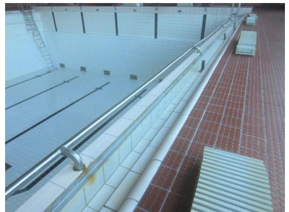
Kuva 12 Loiskekouruissa havaittiin vain yksittäisiä ruostejälkiä.
