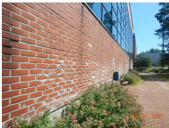
Kuva 8 Lounaissivulla sokkelivierustalla on betonitiililaatoitusta ja pensasistutuksia sekä rikkaruohoja.
