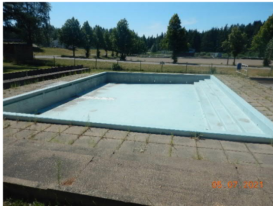
Kuva 10 Ulko-altaan reunalaatoitus on painunut ja saumat heinittyneet.
