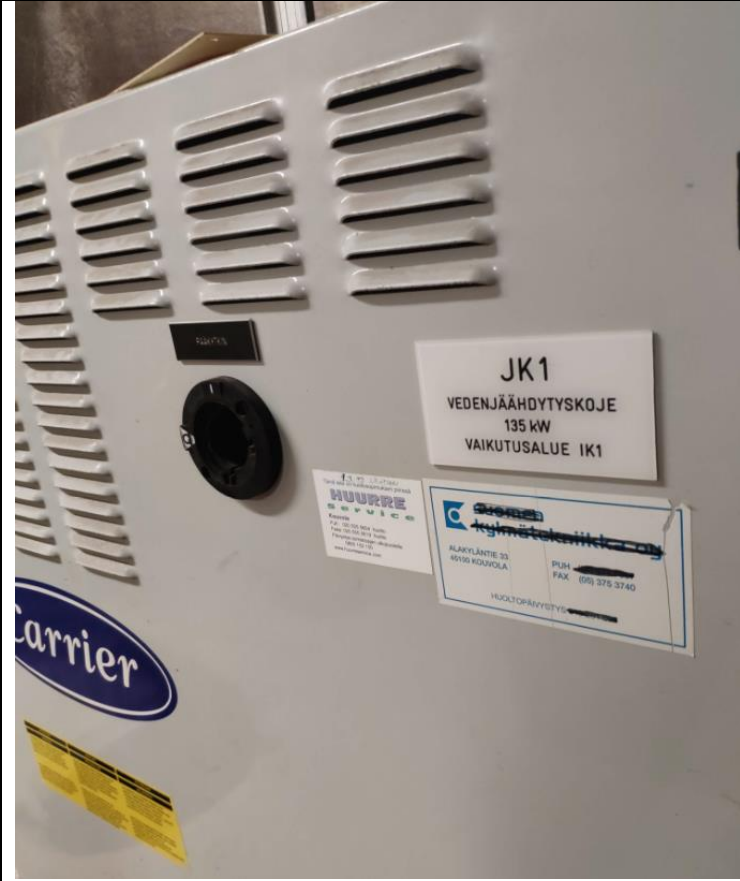
Jäähdytyslaitteiston pääkytkin on rikkoutunut
