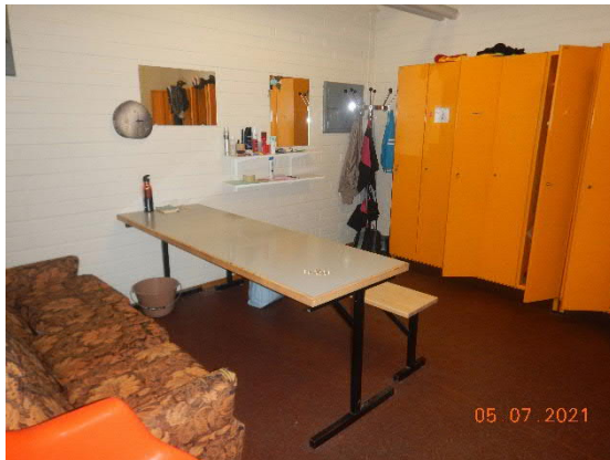
Kuva 97 Tekniikkakerroksessa tekniikkakanaalin ja muiden tilojen välisen väliseinän alimmalla tiilivarvella havaittiin kohonneita pintakosteuslukemia.
