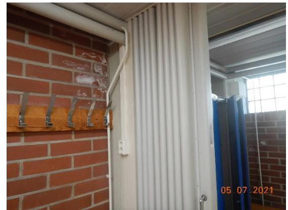
Kuva 84 Pukuhuoneissa on muoviset haitariverhot, joista lähtee voimakas haju. Ulkoseinässä verhon vieressä on tiilipinnan kalkkeutumaa.
