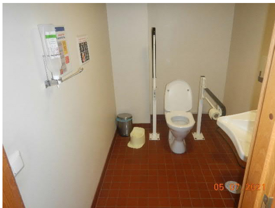
Kuva 93 Aulan wc-tiloissa välipohjassa havaittiin kohonneita pintakosteusarvoja.
