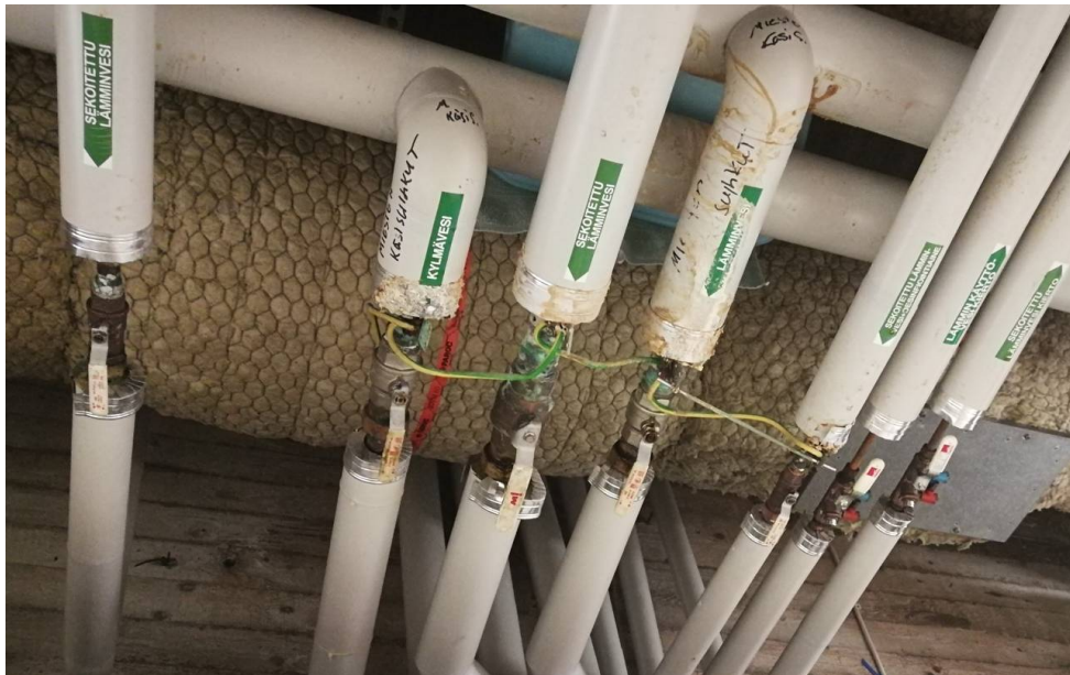
Kuva 5. Esimerkki käyttöveden sulku- ja linjasäätöventtiileistä.
