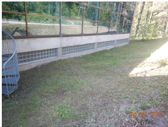
Kuva 6 Maanpinta kaataa kohti rakennusta. Sokkelinvierusta on sammaloitunut hiekkaa ja nurmea.
