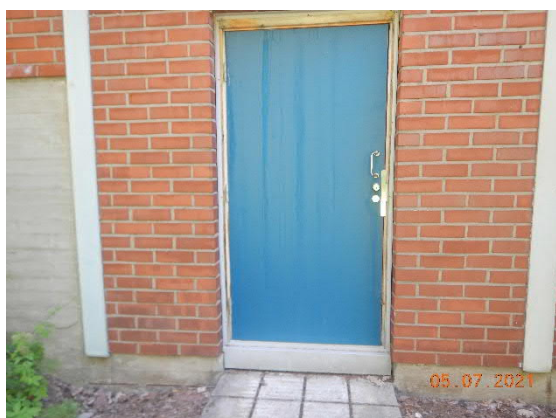
Kuva 58 Ulko-ovet ovat välttävässä kunnossa. Teräsrakenteissa on ruostetta.
