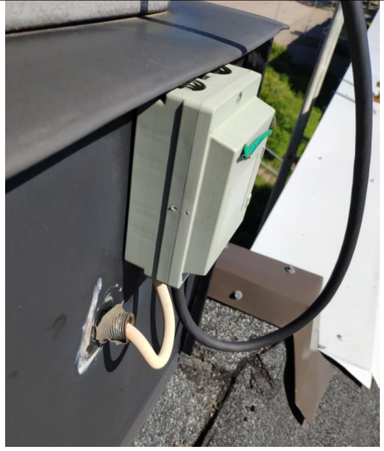
Huippuimurin kaapelin läpivienti ei ole tiivis
