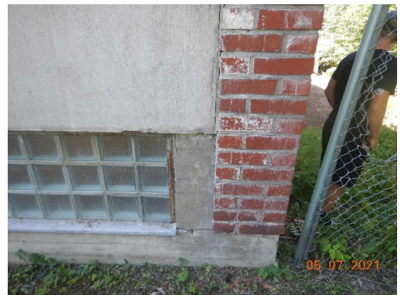
Kuva 53 Pukuhuonekerroksen lasitiili-ikkunoiden teräsrakenteet ovat ruosteiset.
