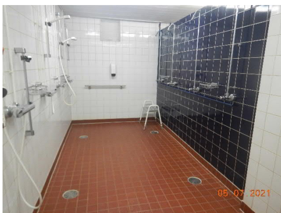
Kuva 79 Pesuhuoneissa pintamateriaalina on keraaminen laatoitus. Pintamateriaalit ovat ehjiä, mutta ikääntyneitä.
