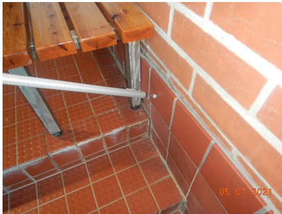
Kuva 91 Allastiloissa välipohjassa ja seinien alaosissa havaittiin kohonneita pintakosteuslukemia.
