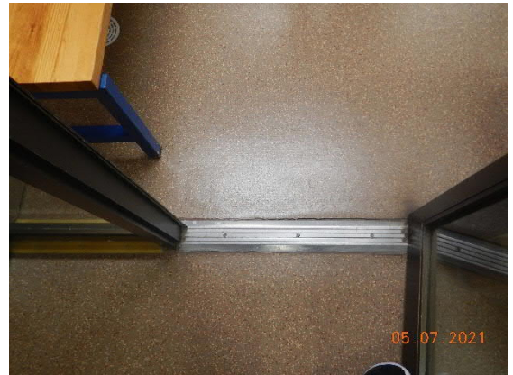
Kuva 31 Muovimatto on irti alustastaan ryhmäpukuhuoneen kynnyksellä.
