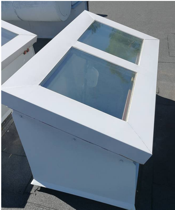
Kuva 16. Savunpoistoluukku vesikatolta kuvattuna.
