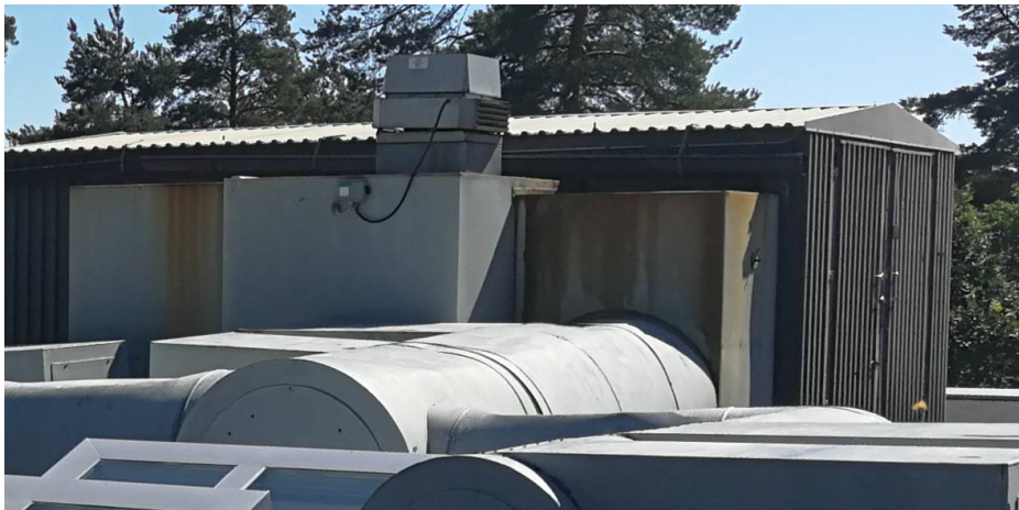
Kuva 11. Esimerkki vesikatolla sijaitsevista poistoilmapuhaltimista. PK3 näkyvillä ja PK1 ja PK2 sijoitettuna taka-alalla olevaan koppiin.
