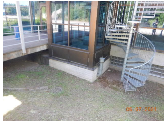
Kuva 5 Asfaltilta maanpinta laskee jyrkästi rakennusvierustalle. Sisäänkäynti rakennukseen on betonisen siltarakenteen kautta, joka on kuvassa vasemmalla.
