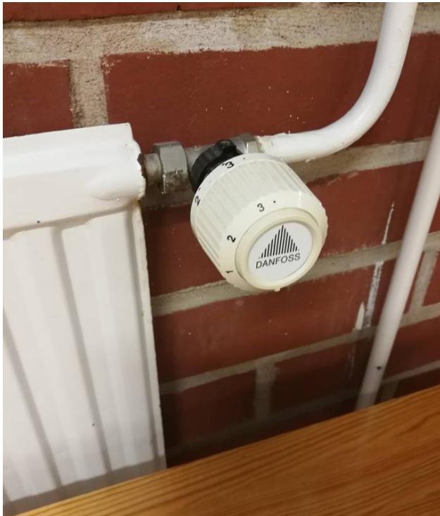
Kuva 3. Esimerkki radiaattorista termostaattiventtiileinen.
