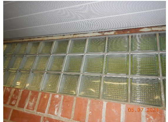
Kuva 63 Lasitiili-ikkunoiden teräsraakenteissa on ruostetta myös sisätiloista tarkastellen.
