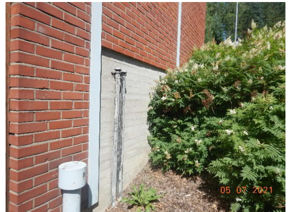
Kuva 11 Sokkelinvierustalla on paikoin kasvillisuutta.
