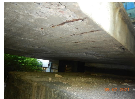
Kuva 19 Pääsisäänkäynnille vievän betonisillan alaosassa on rapautumaa, teräkset ovat osin näkyvillä.
