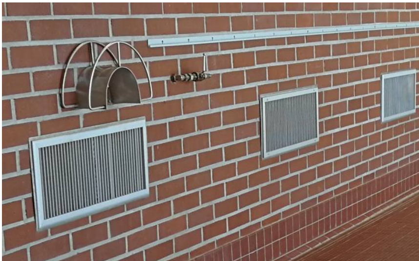
Kuva 15. Uimahallin poistoilman päätelaitteita.
