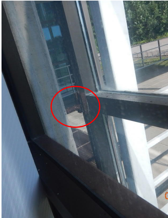
Kuva 62 Ikkunarakenteissa on ruostetta. Kuvassa keskellä erityisen ruostunut kiinnike.
