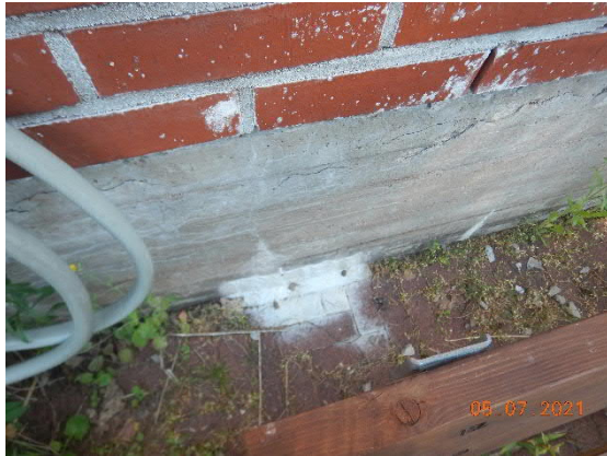
Kuva 16 Sokkelissa on paikoin halkeamia, kalkkihärmää ja teräksiä näkyvillä.
