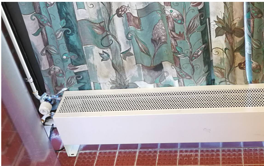
Kuva 4. Esimerkki konvektorista termostaattiventtiileinen.
