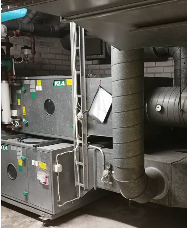
Kuva 10. Esimerkki IV-konehuoneessa sijaitsevista tuloilmakoneista.
