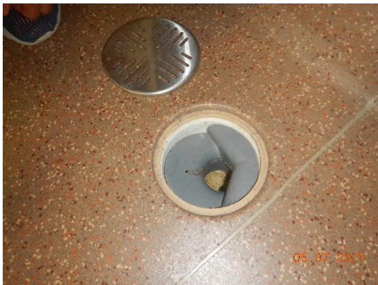
Kuva 32 Pukuhuoneissa muovimatto on hieman irti useamman lattiakaivon ympärillä.
