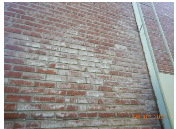
Kuva 49 Runsaasti kalkkihärmää luoteisivulla. Tiilimuurausta tukevien I-terästen reunat on ruosteessa.
