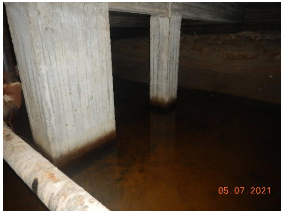
Kuva 22 Betonipilareiden alaosat ovat veden alla.
