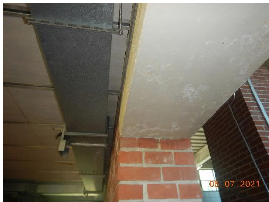
Kuva 85 Allasosaston ja luoteisen portaiden välisessä väliseinässä, aukonylityspalkissa ja alakattopinnoissa havaittiin paljon kosteuden aiheuttamia jälkiä.
