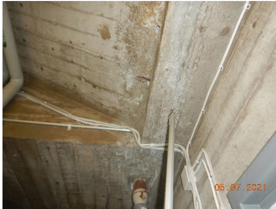
Kuva 87 Tekniikkakerroksessa on havaittavissa paljon vuotojälkiä välipohjan alapinnoissa ja väliseinissä.
