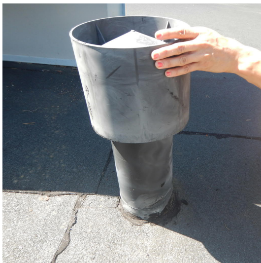
Kuva 109 Vesikaton tuuletusputkien tiivistysmassa on kovettunut mutta liittymä vaikuttaa tiiviiltä.
