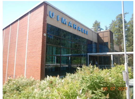
Kuva 51 Rakennuksen itänurkka. Kaakkoispuolella on selkeästi vähemmän kalkkihärmää kuin lounais- ja luoteissivulla.
