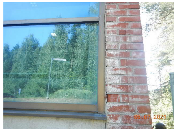
Kuva 55 Ikkunoiden ja ulkoseinien liittymät ovat epätiivit.
