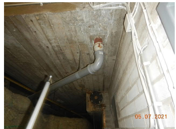
Kuva 96 Tekniikkakerroksessa välipohjan alapinnoilla havaittiin kohonneita pintakosteusarvoja valumajälkien kohdilla.
