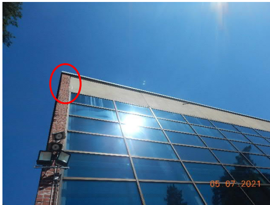
Kuva 44 Lounaissivulla ylimmissä ikkunoissa on veden valumajälkiä. Länsinurkan tiilimuuraus on kallistunut ulospäin sandwich-elementistä.
