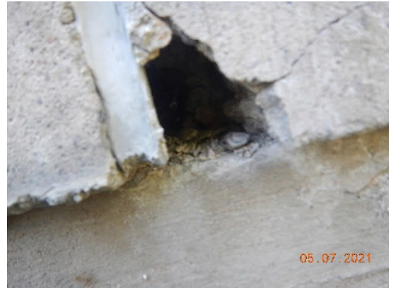
Kuva 17 Sokkelin ja tiiliseinän liittymässä halkeilua.
