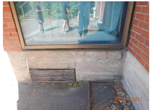
Kuva 13 Sadevedet todennäköisesti lammikoituvat kaakkoissivulla ilmanottoaukon eteen ja valuvat aukosta sisään.
