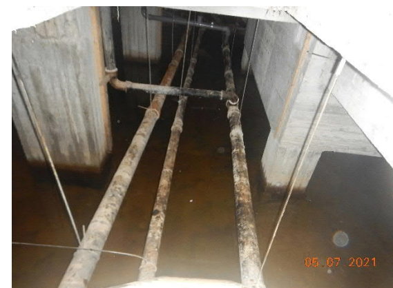
Kuva 21 Alapohjatilassa on runsaasti vettä, jonka vuoksi rakenteita ei päästy tarkastamaan.
