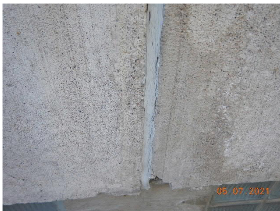
Kuva 54 Elastiset saumamassat ovat kovuuttuneet ja halkeilevat.
