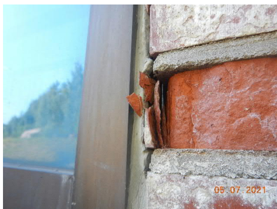
Kuva 56 Rapautuneen tiilen, huonokuntoisen saumamassan ja ikkunan väleistä on suora ilmayhteys allastilaan.
