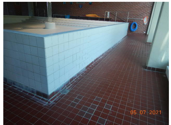
Kuva 78 Allastiloissa altaiden, pilareiden ja seinien vierustoilla oli havaittavissa kalkkeutumaa.
