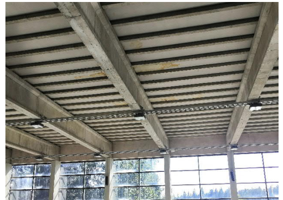
Kuva 112 Allasosastolla on näkyvillä yläpohjan vuotojälkiä. Vesikatolla ei kuitenkaan havaittu jälkien kanssa yhteneväisiä kohtia, joista vuotoja olisi voinut tapahtua. On mahdollista, että vuotojäljet ovat vanhempia.
