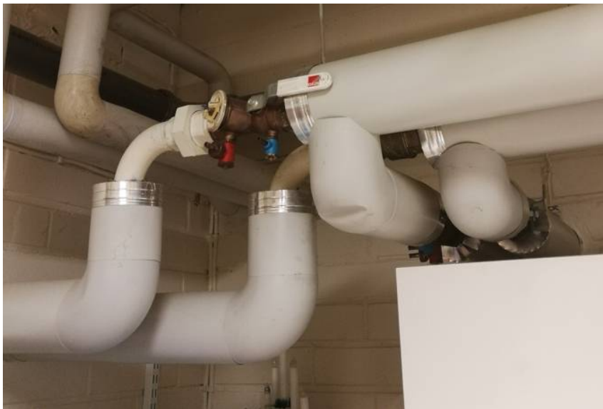
Kuva 2. Esimerkki lämmityksen paluujohdojen linjasäätöventtiilistä.
