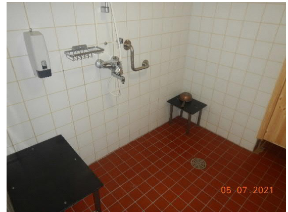
Kuva 92 Tilaussaunojen pesuhuoneissa havaittiin kohonneita pintakosteusarvoja.
