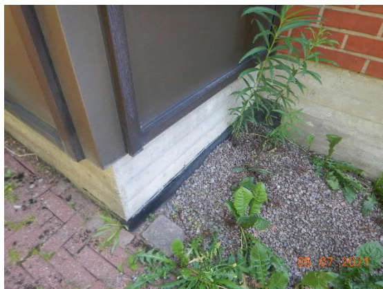
Kuva 18 Luoteissivulla havaittiin paikallisesti raitisilmakanavan sokkelissa bitumisively ja jonkinlainen kumilista.
