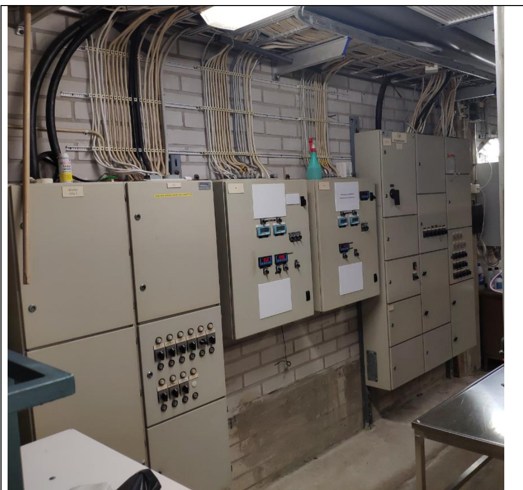
Allaslaitetilan jakokeskuksia ja kiinteistöautomaatiokeskuksia.
