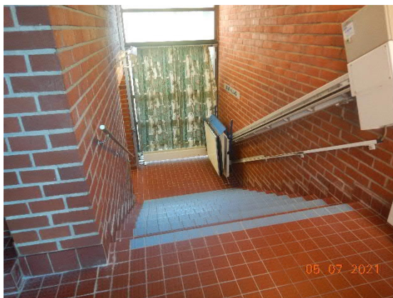
Kuva 95 Kaakkoissivulla allasosastolta lähtevässä portaikossa havaittiin kohonneita pintakosteusarvoja.
