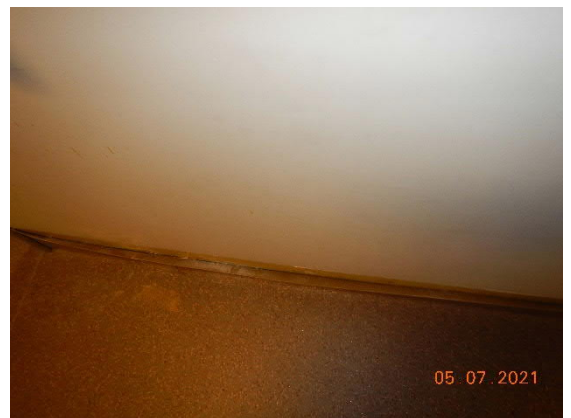
Kuva 36 Muovimatto on kirkannut irti reunoistaan.
