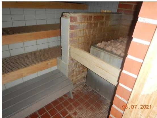
Kuva 83 Saunojen pintamateriaalit ovat kuluneet.
