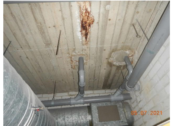
Kuva 88 Vuotojälkiä läpivientien ympärillä.
