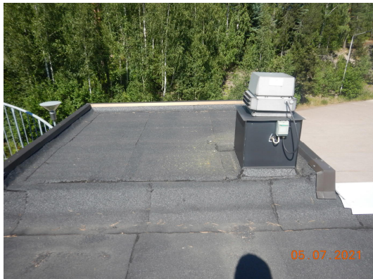
Kuva 107 Vuoden 1995 peruskorjauksessa rakennetun hissien vesikatto on hyvässä kunnossa ja limitys vanhaan vaikuttaa tiiviiltä.
