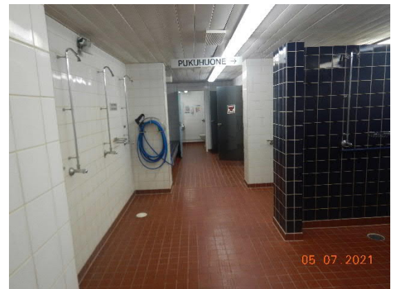
Kuva 94 Pesuhuoneissa havaittiin kohonneita pintakosteuslukemia.
