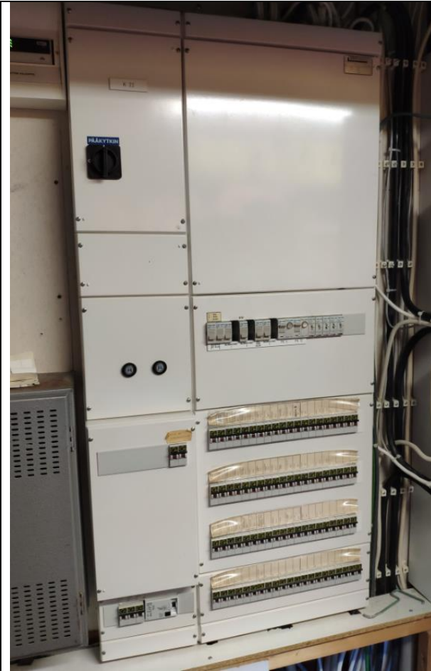
Uimavalvojan tilassa olevan jakokeskuksen kosketussuojaus puutteellinen.
