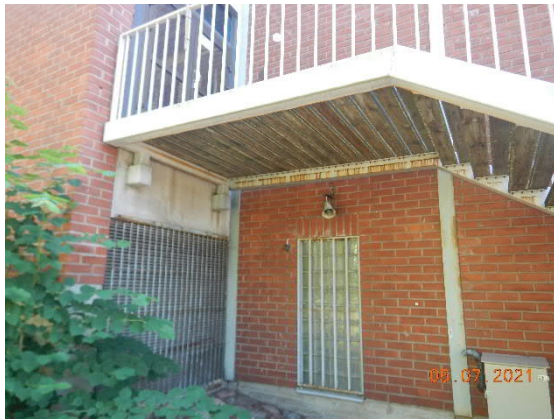
Kuva 50 Luoteissivun teräsrakenteinen portaikko on tyydyttävässä kunnossa. Ruostetta on erityisesti alapinnoilla.
