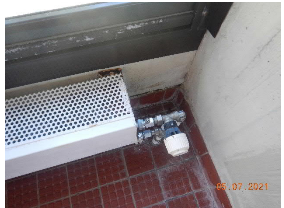
Kuva 67 Ikkunaelementtien alla ulkoseinän sisäpinnalla on kosteuden aiheuttamia jälkiä.
