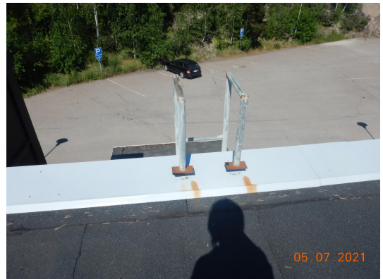
Kuva 108 Vesikatolle johtavat vanhat kattotikkaat eivät ole yläreunastaan kiinni.
