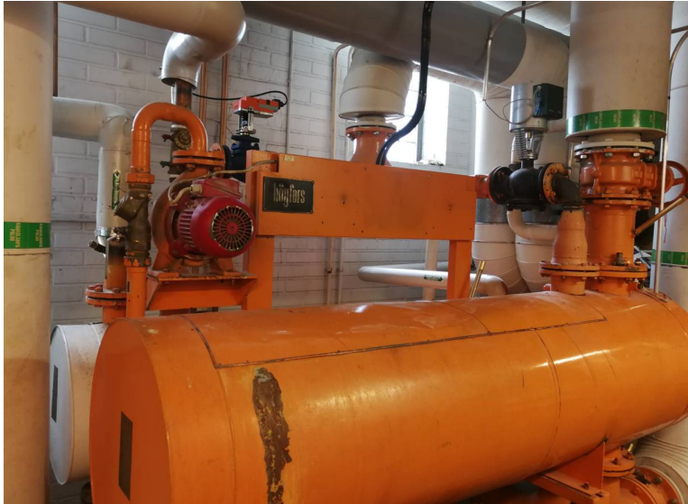
Kuva 1. Kaukolämmön siirtimet varusteineen.
