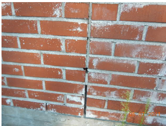
Kuva 48 Muuraussaumat ovat paikoin rapautuneet.
