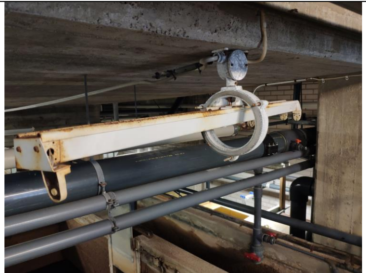
Käytöstä poistettu valaisin allaslaitetilassa
