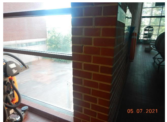
Kuva 65 Kaakkoissivun portaikon luona seinäpäädyssä on pientä halkeilua.
