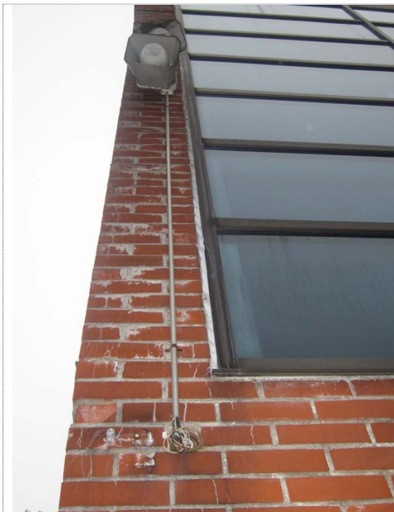
Kuva 7, Ulkokaiuttimen jakorasia ilman kantta
