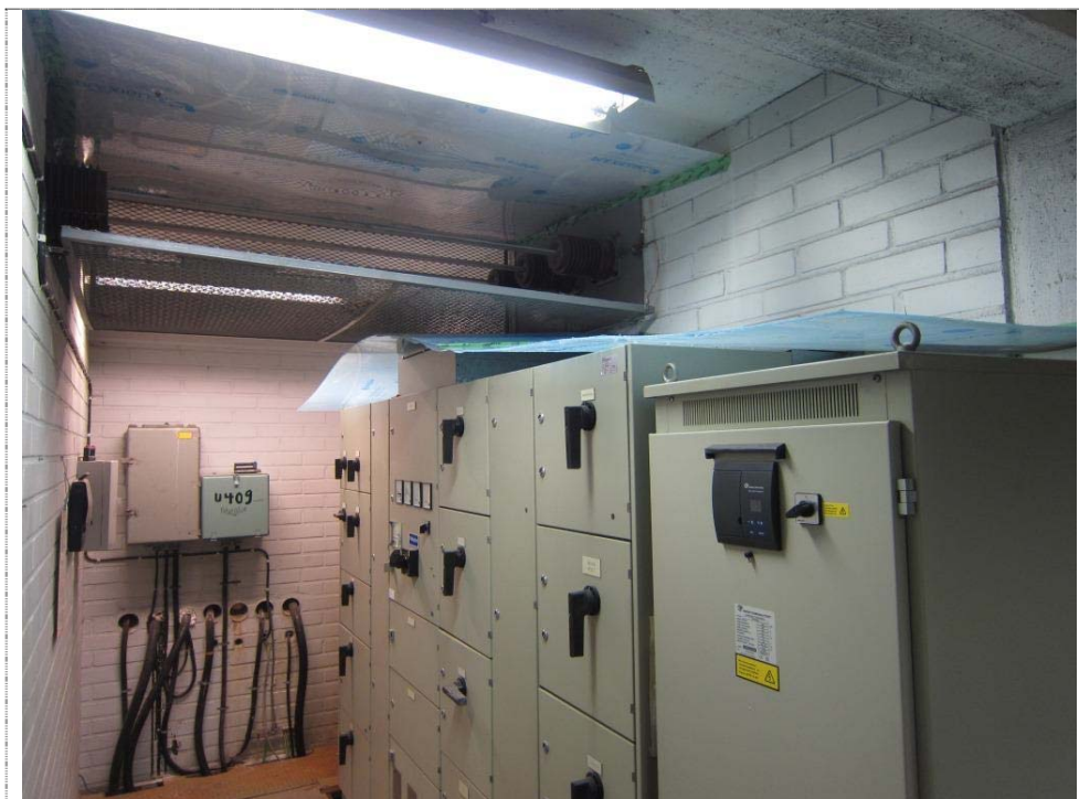
Kuva 2, Pääkeskus ja tilapäiset vesisuojat
