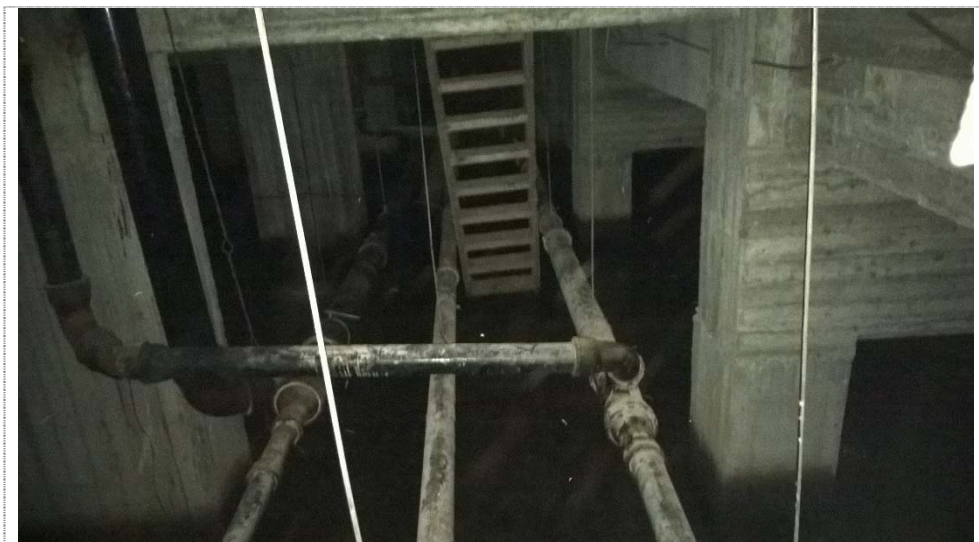
Kuva 6.: Tekniikkatason alapuolella pohjaviemärit ja vettä.
