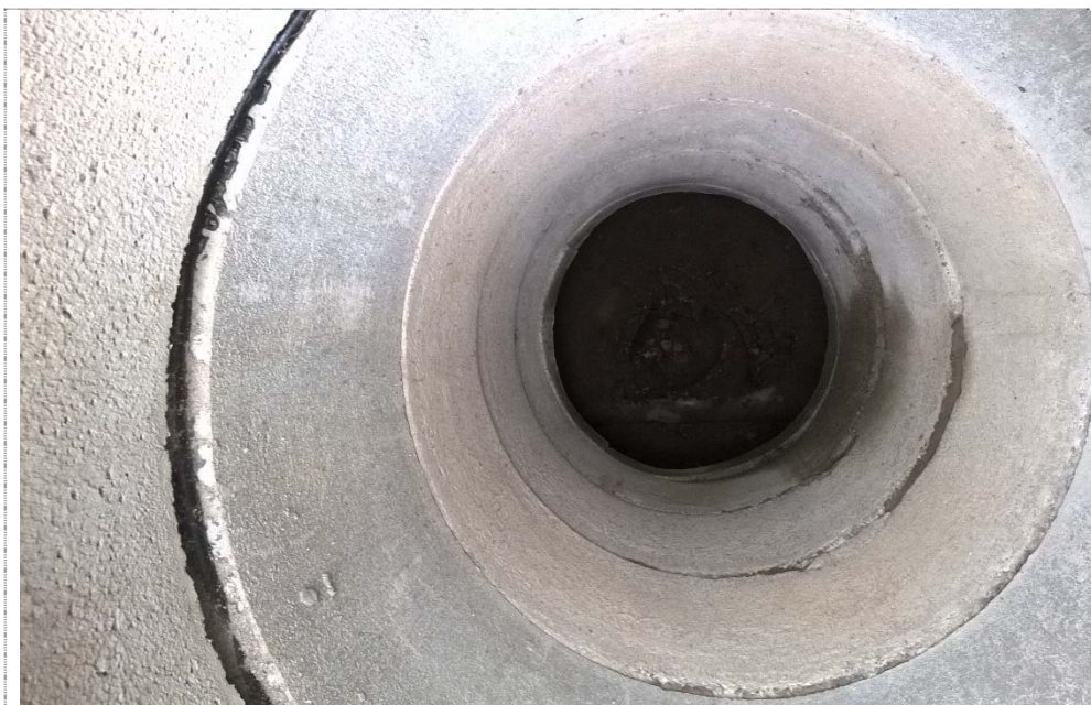
Kuva 14.: Betonirengaskaivo on liikahtanut.
