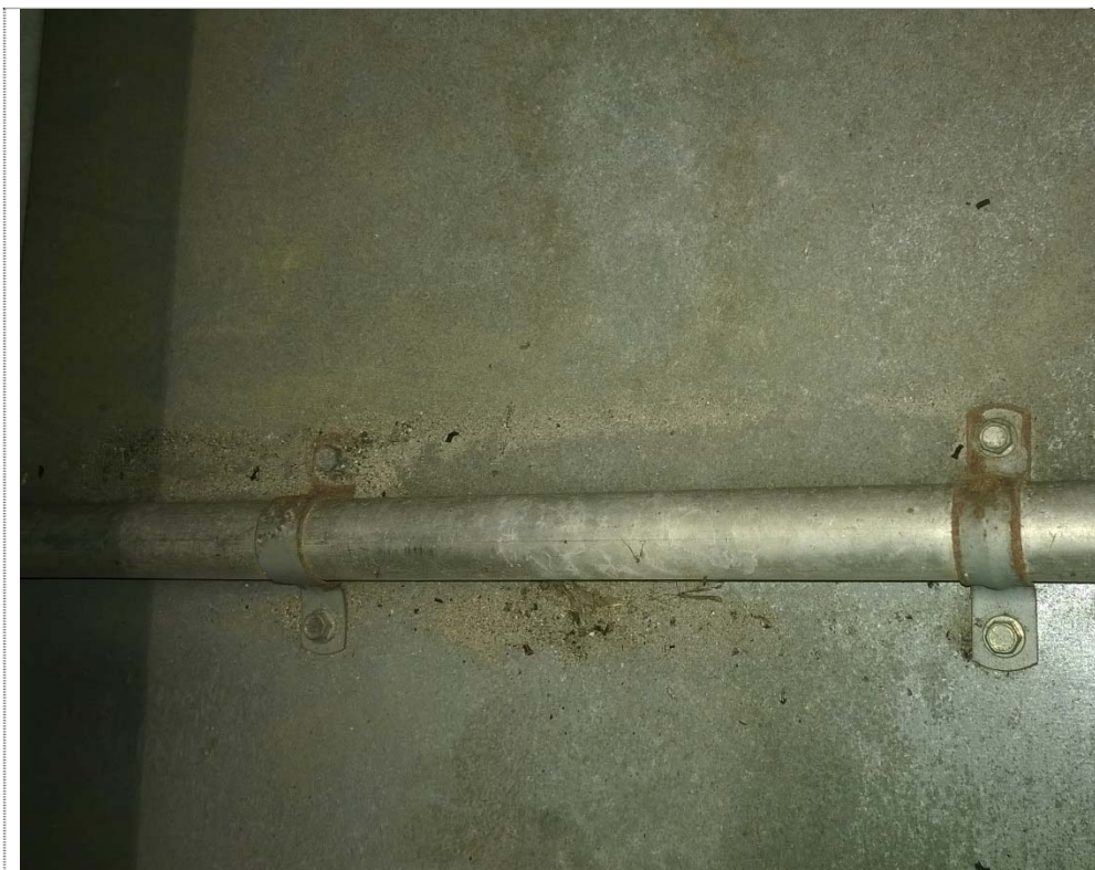
Kuva 19.: TK1, karkeaa irtolikaa puhallinkammiossa tulopuolella.
