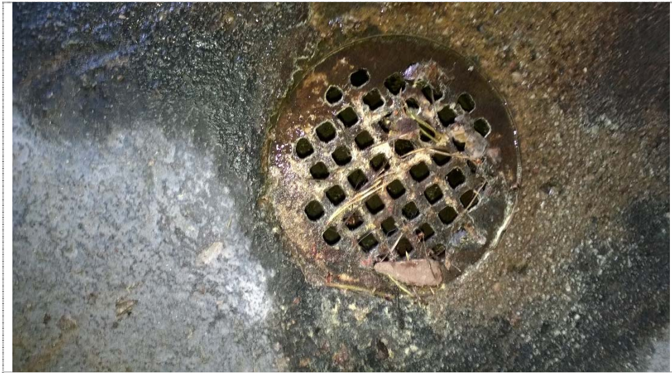
Kuva 10.: Lattiakaivo tekniikkatason porrassyvennyksessä ulkona.
