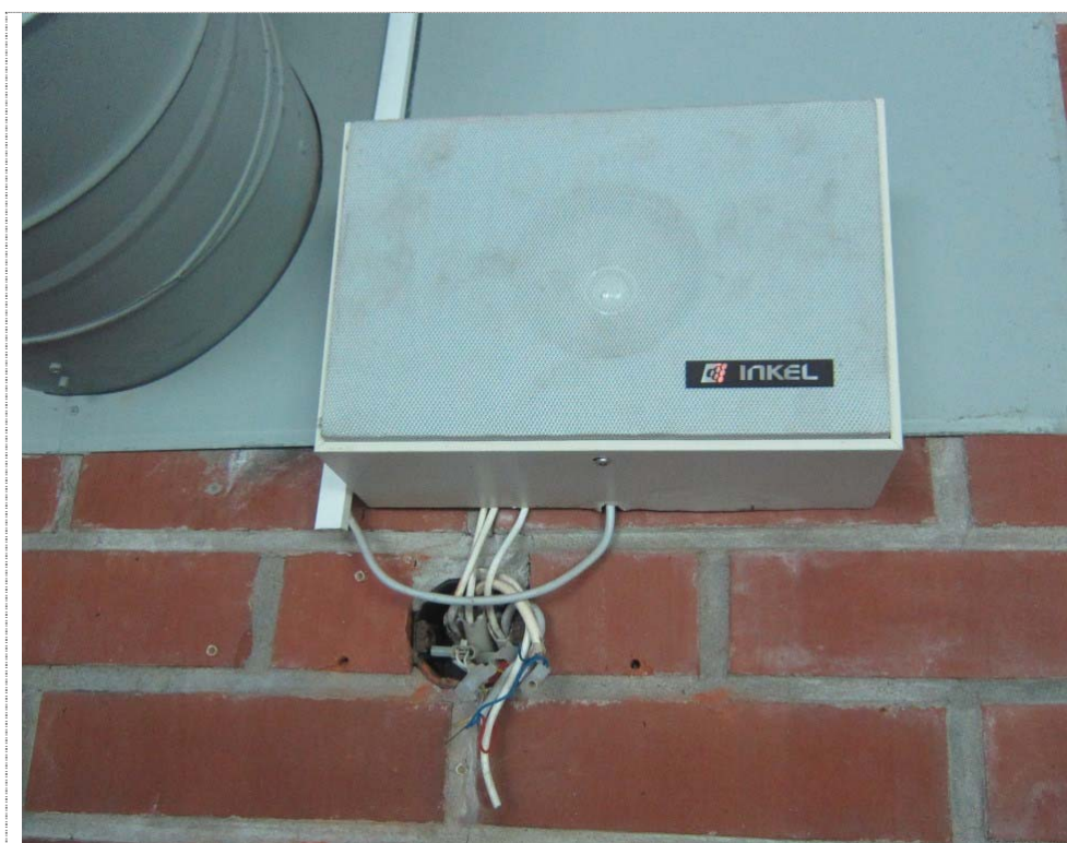
Kuva 6, Kahvion kaiuttimen jakorasialla ilman kantta
