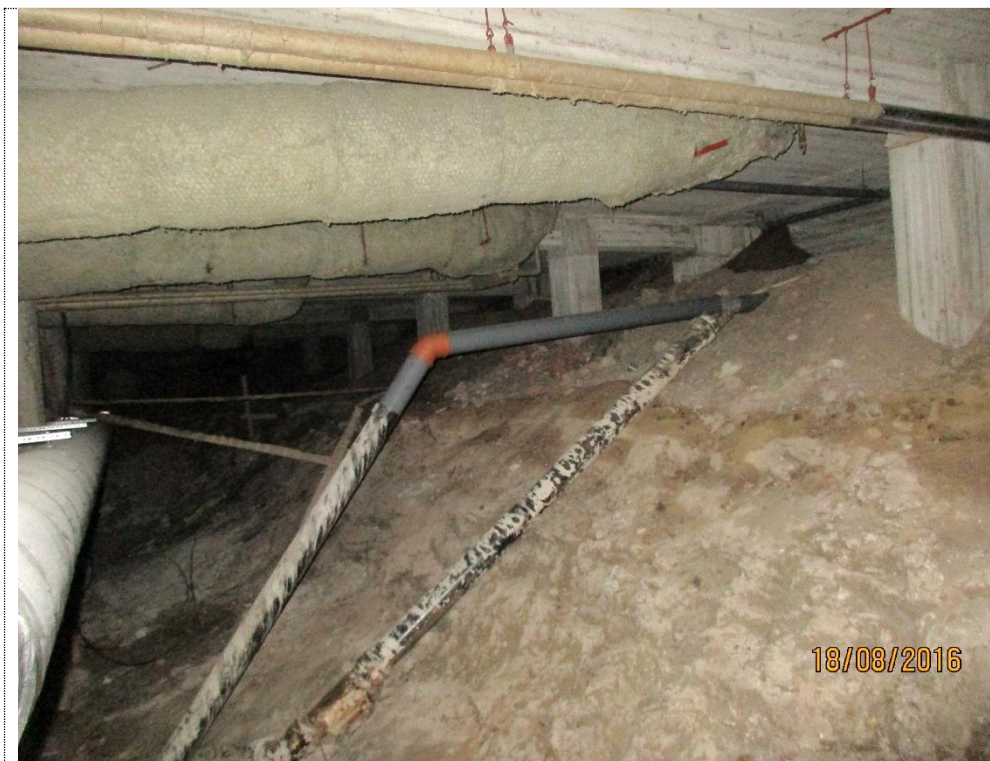
Kuva 10. Puutteellinen viemäriputken tuenta
