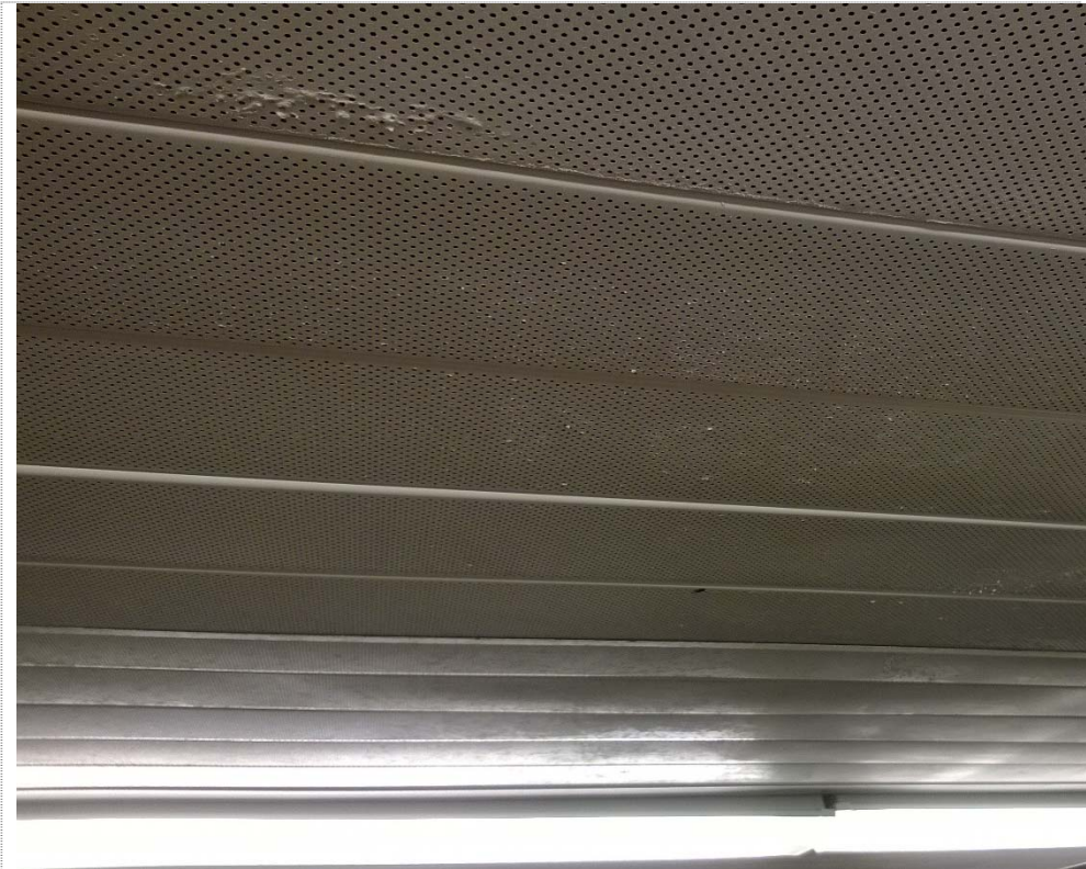
Kuva 1.: Peltisälealakaton päällä pesutiloissa on mineraalivillaa, jonka kunto saattaa olla huono. Katossa kosteusjälkiä.
