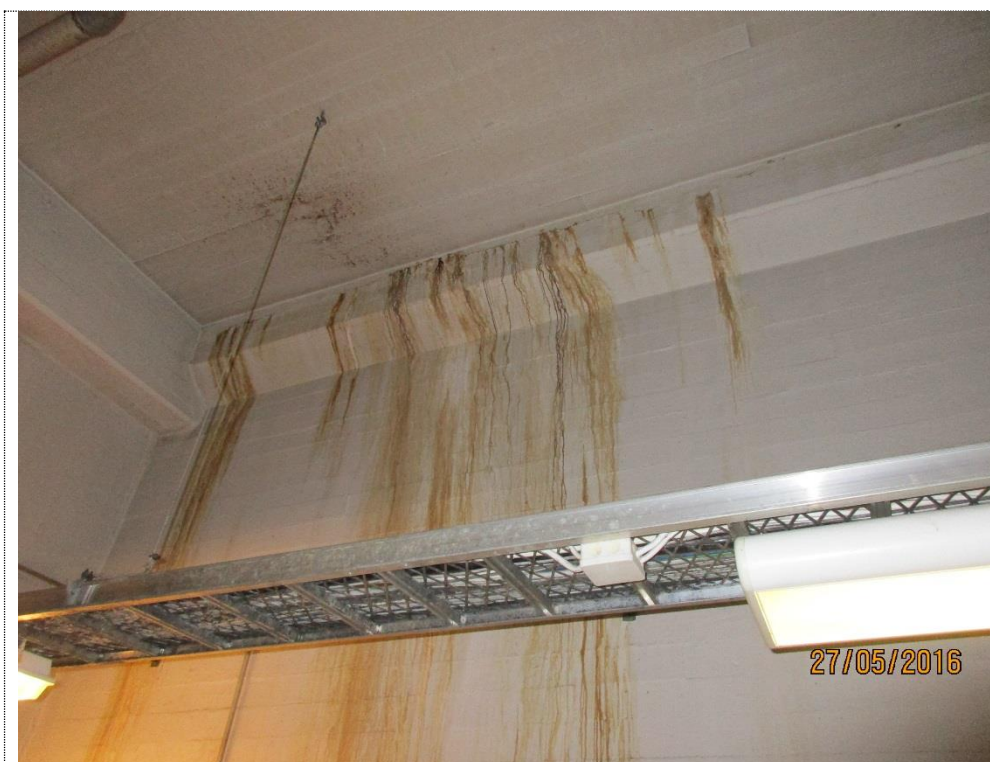
Kuva 12. Vuotojälkiä tekniikkatason rakenteissa
