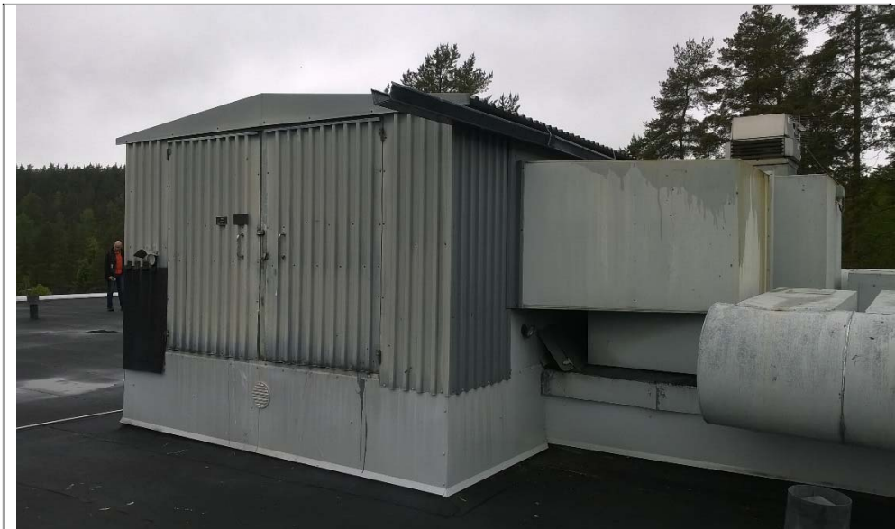
Kuva 21.: Poistoilmahuone PK1 vesikatolla omassa konehuoneessaan.
