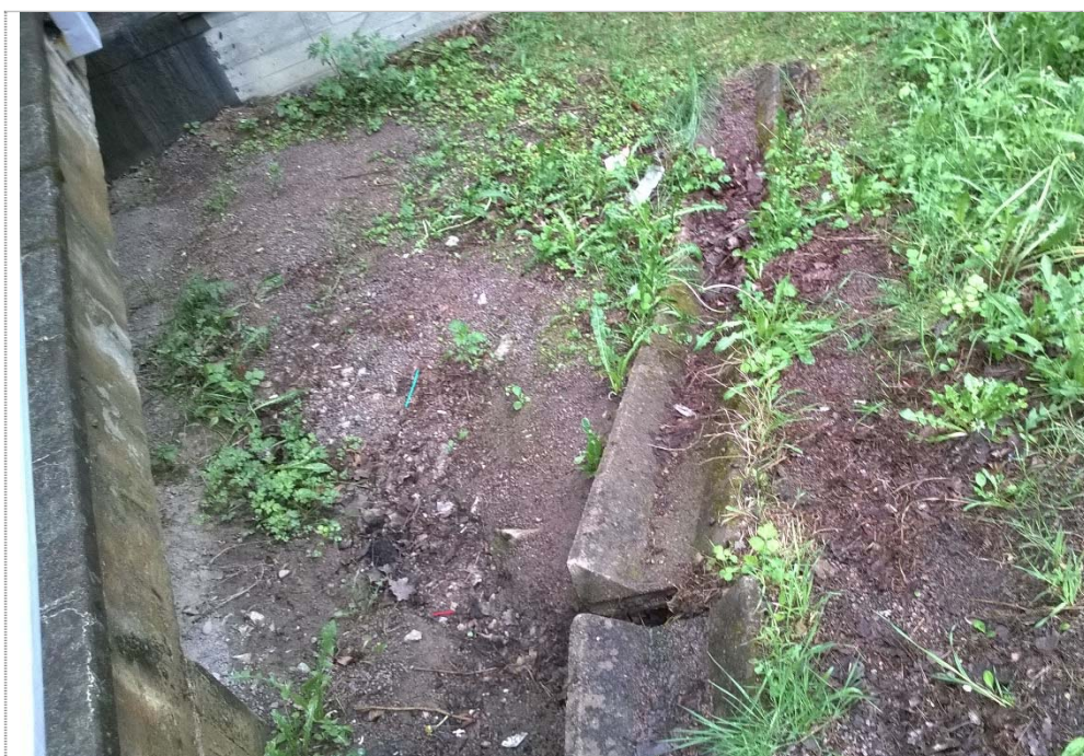
Kuva 15.: Betoninen sadevesikouru on poikki.
