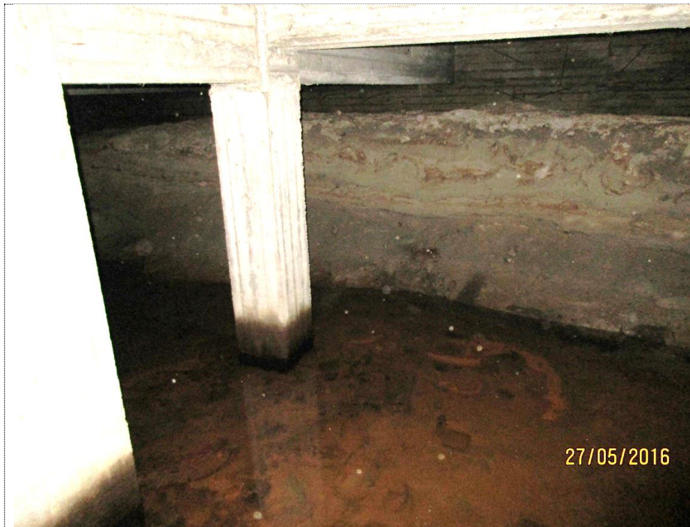
Kuva 7. Vapaata vettä alapohjatilassa
