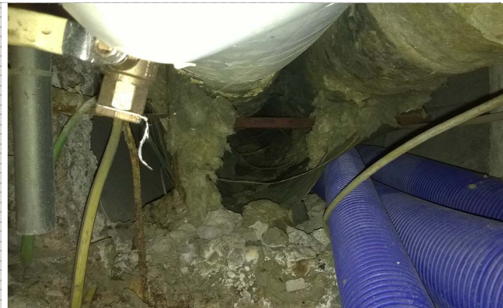
Kuva 2.: Putkikanaalin pää on avoinna lämmönjakohuoneeseen. Kanaalista tulee tunkkaista ilmaa.
