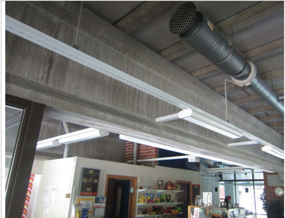
Kuva 1, Kahvion kanavapuhaltimen laakerivika
