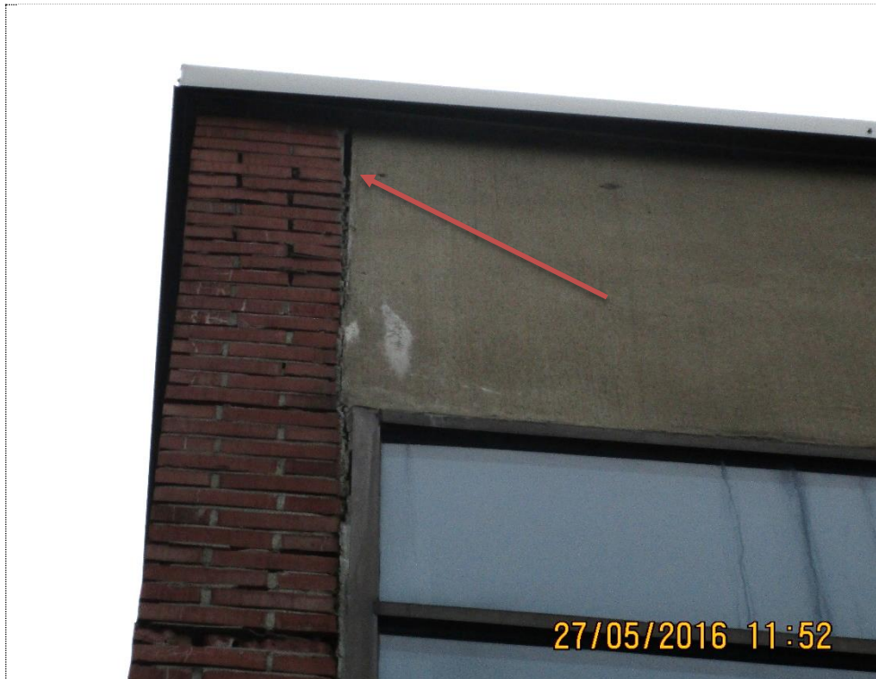
Kuva 15. Tiilimuurauksen yläosassa rakenne on pullistunut ulospäin
