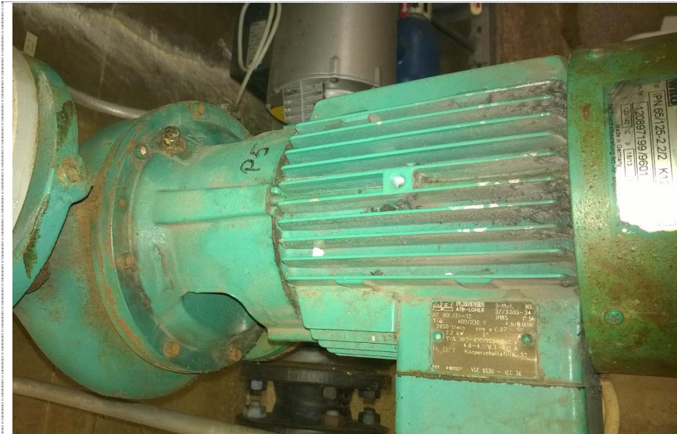
Kuva 23.: Jäähdytyspiirin pumppu n. vuodelta 1996.
