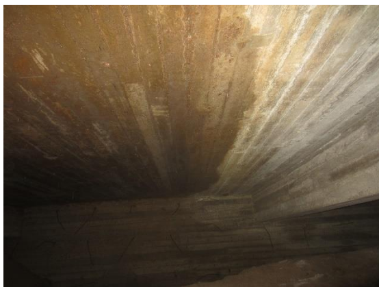
Kuva 13 Alapohjatilassa havaittiin vain paikallisesti alapohjan alapinnoissa tiivistyvää kosteutta.
