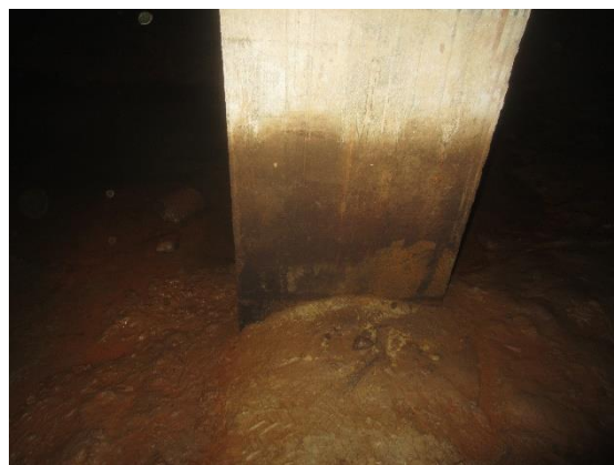
Kuva 10 Alapohjatilassa keskialueella olevien pilareiden alapäävät ovat jatkuvasti veden alla.
