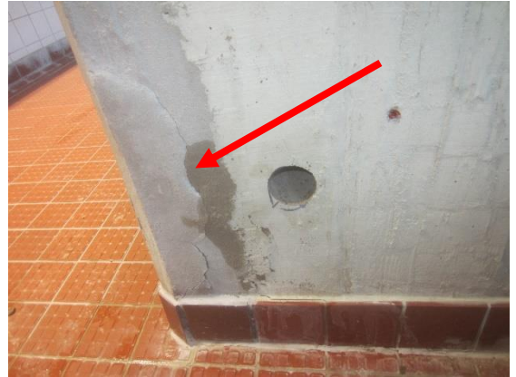
Kuva 18 Eniten korjatussa pilarissa on korjauksesta huolimatta nähtävillä halkeilua.
