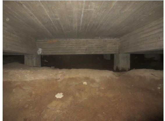
Kuva 12 Myös alapohjan alapinnat olivat pääosin kuivia.
