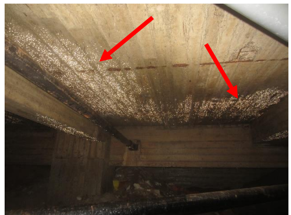
Kuva 14 Kosteus on paikallisesti tiivistynyt pisaroiksi betonin alapintaan.
