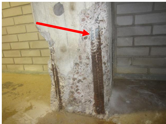
Kuva 5 Rakenneavausten perusteella teräkset eivät olleet ruostuneet betonin sisällä.
