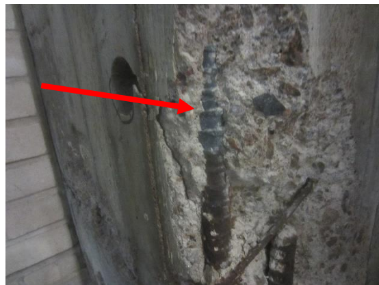
Kuva 6 Betonin sisältä paljastui puhdasta harjaterästä.
