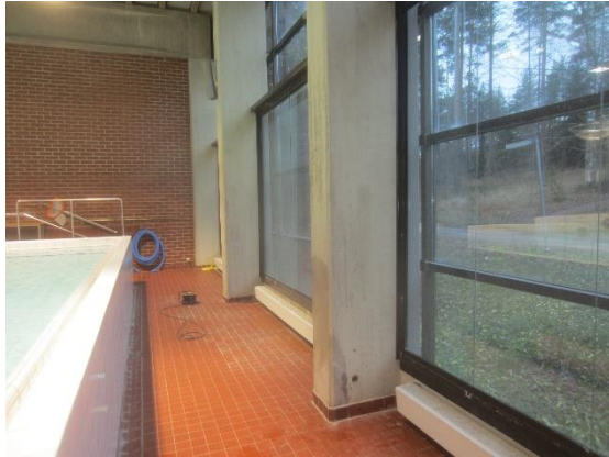
Kuva 17 Uima-allastilassa pilareita on hieman paikkakorjailtu aiemmin.
