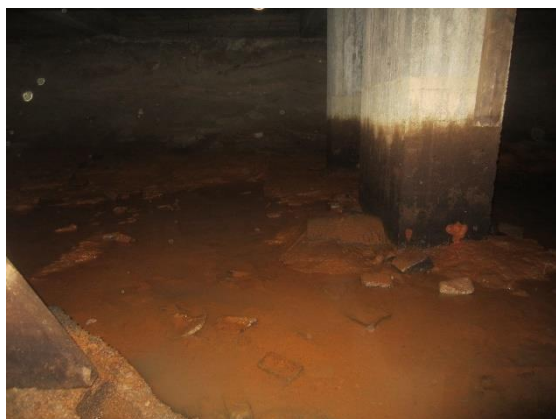
Kuva 9 Rakennuksen alapohjatilaan kertyy runsaasti vettä.
