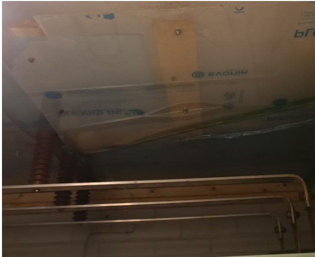
Kuva 3. 20kV kojeiston päällä oleva muovilevy on halkeillut useammasta kiinnityspisteestä.
