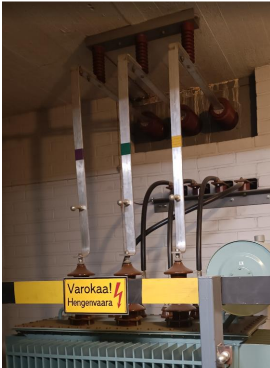
Kuva 1. Vuotojälkiä muuntajan 20kV kiskoston läpivientien päällä
