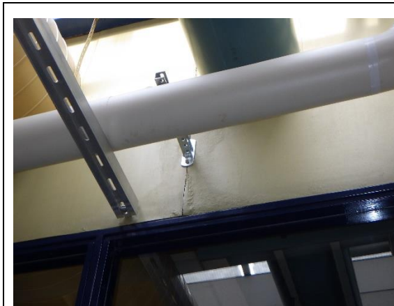
Kuva 22. Kosteusjälkiä ulkoseinän levyrakenteissa kattoikkunoiden alapuolella
