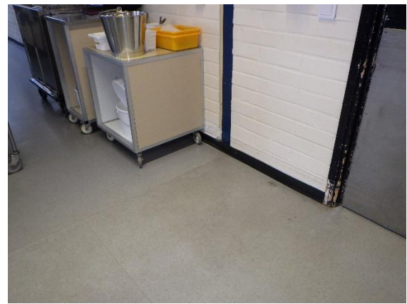
Kuva 74. Kosteusjälkiä ruokailutilan väliseinän alaosassa
