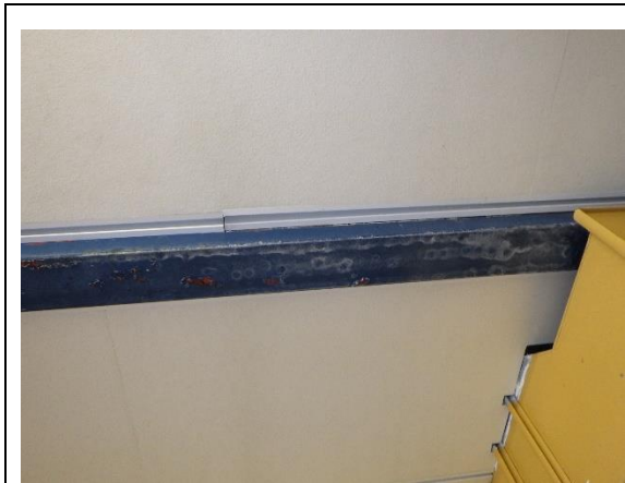
Kuva 59. Ruostetta tiskaushuoneen 53 teräspalkissa
