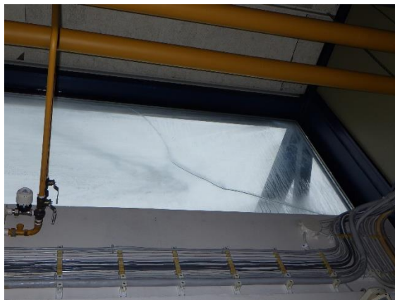
Kuva 40. Eteisen 4 ikkunassa havaittiin halkeama
