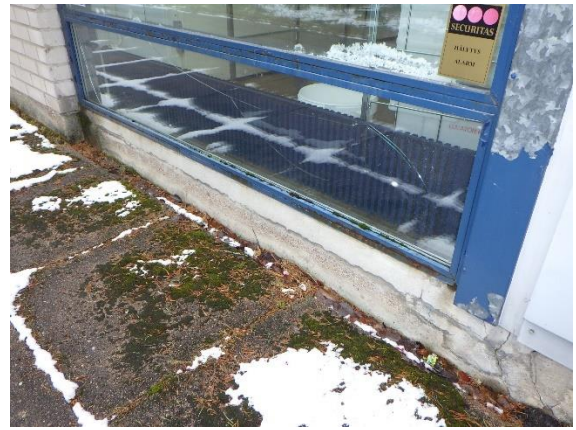
Kuva 9. Halkeamia ja pinnoitteen irtoamista sokkelissa
