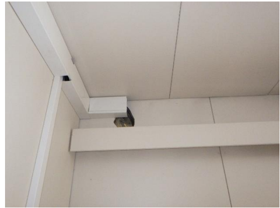
Kuva 72. Ulkoseinän osalla oleva avoin läpivienti
