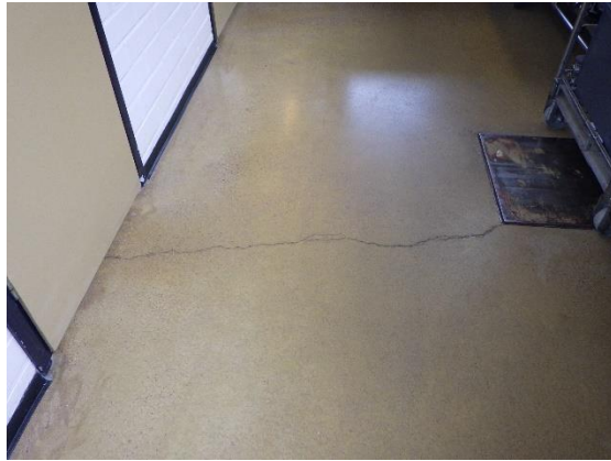
Kuva 69. Halkeama käytävän massapinnoitteessa
