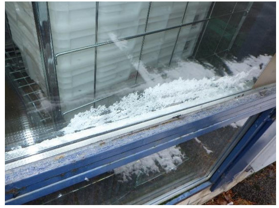
Kuva 39. Kalkkihärmettä ikkunan välissä
