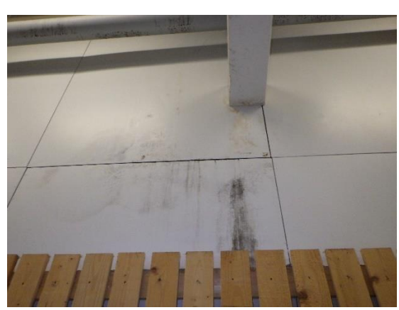
Kuva 62. Levytyksissä havaittiin tummentumia
