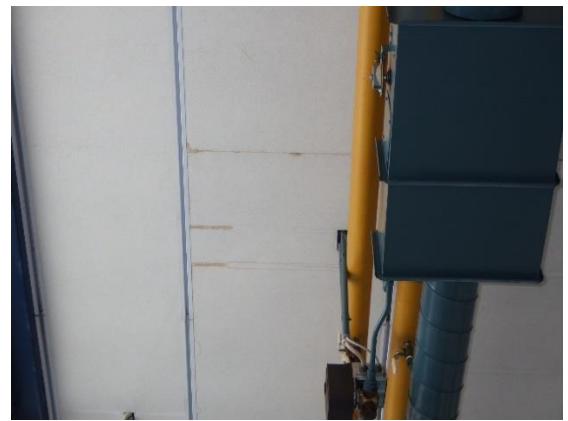
Kuva 37. Kattopinnoitteissa havaittiin kosteusjälkiä
