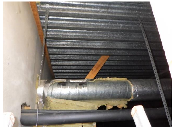
Kuva 95. Ilmanvaihtokanavia, puuttuva eristys ja avoimia villapintoja.
