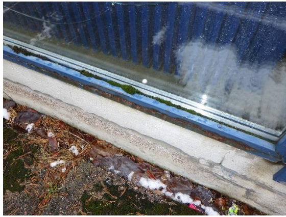
Kuva 38. Ikkunoiden osalla havaittiin paikoin sammaloitumista ja metalliosissa ruostetta
