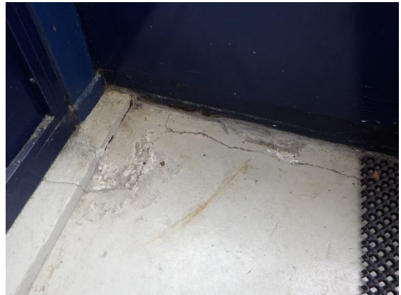
Kuva 11. Kosteusjälkiä ja halkeamia tuulikaapin lattiassa
