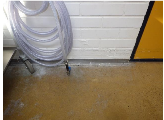
Kuva 70. Kosteusjälkiä diettikeittiön väliseinän alaosassa käytävän puolella
