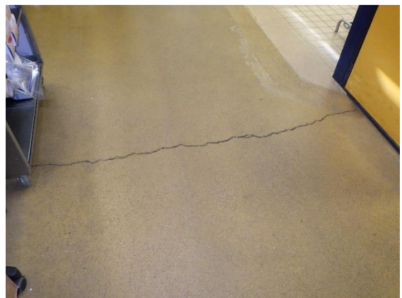
Kuva 13. Halkeama käytävän 7 lattiassa
