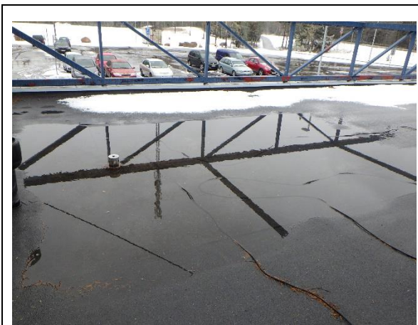
Kuva 30. Vesikatolla havaittiin veden lammikoitumista, koska roskat tukkivat roskasihtiä
