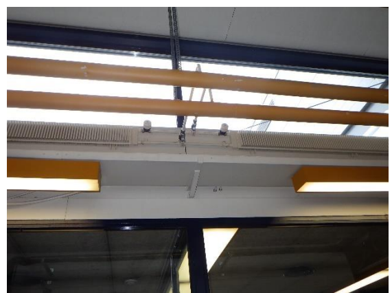
Kuva 80. Lämmityspatteri katon rajassa ikkunan alla
