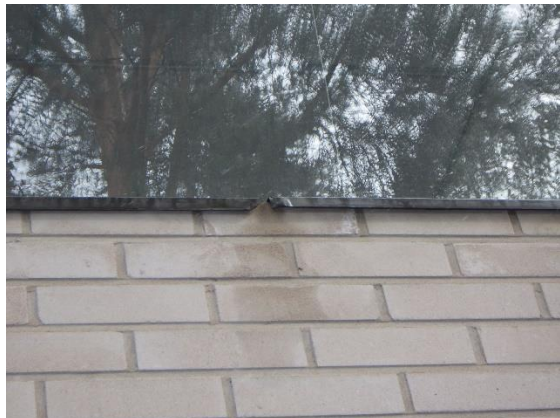
Kuva 42. Epätiiviyiskohta ikkunan vesipellissä
