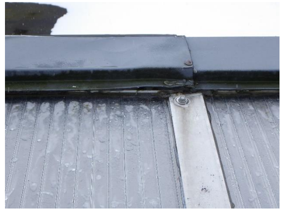
Kuva 45. Kattoikkunan harjapellin liittymä ei ole tiivis
