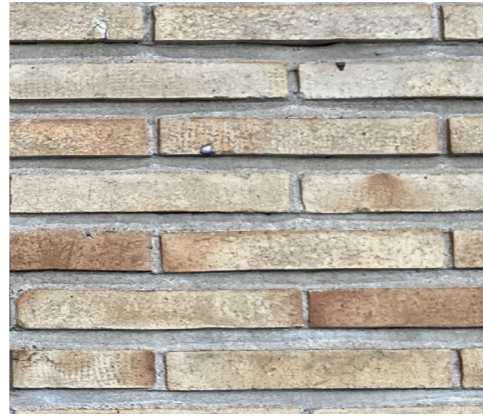
Vanhan uimahallin tiilimuurausta. Peruskorjattavan osan tiilimuuraus ehdotetaan muurattavaksi kokonaan uudelleen. Valittavan julkisivutiilen mittojen ja värityksen tulisi vastata mahdollisimman hyvin vanhaa tiiltä.
