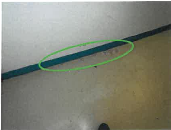
Alapohjassa paikoitellen kosteuden aiheuttamia jälkiä
