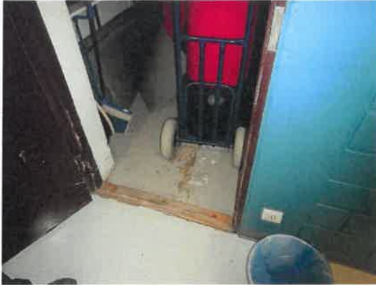
Salissa väliovi, jonka puinen kynnyks on kosteus-/lahovaurioitunut
