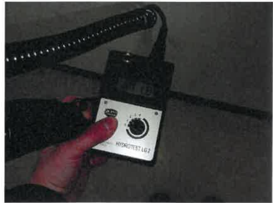
Pintakosteudenilmaisimella todettiin paikoitellen kohonneita arvoja, jotka indikoivat rakenteessa olevaan kohonneeseen kosteuteen
