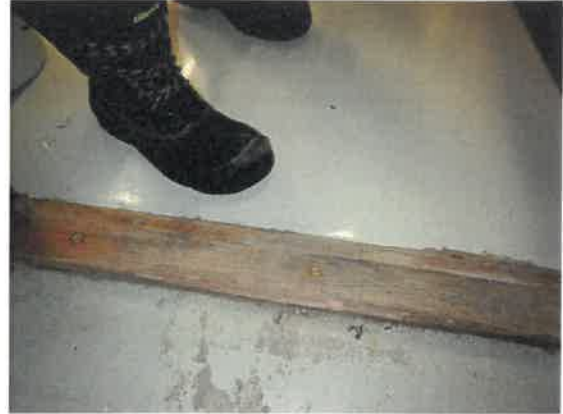
Puinen kynnyks lahovaurioitunut
