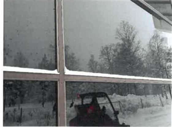
Lasijulkisivun puisissa listoissa kulumaa
