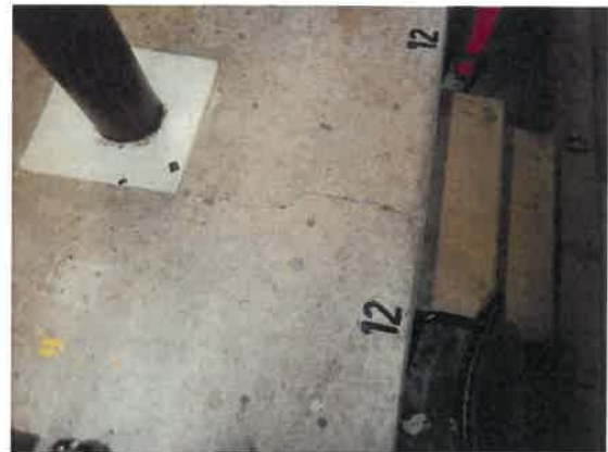
Paikallinen halkeama katsomon laattapinnassa
