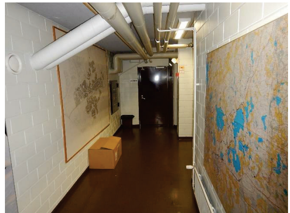
Alkuperäistä, todennäk. asbestipitoista, vinyylilaatta toimistotiloissa, katossa akustolevytyks
