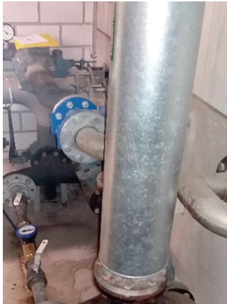
Vesimittari ja sprinklerin syöttöputki
