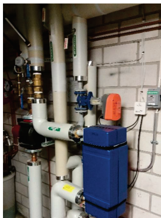
Lämmönjakosiirrin ja säätöventtiili
