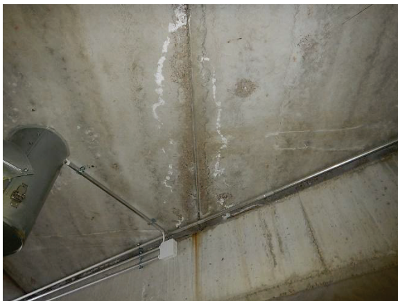
Pihakansirakenteen alapuolella näkyviä vanhoja vuotojälkiä
