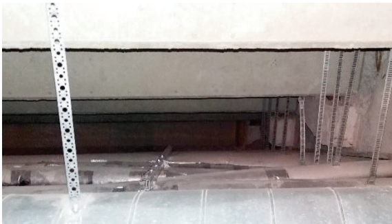
Katsoman alla putket vaikeasti huollettavissa
