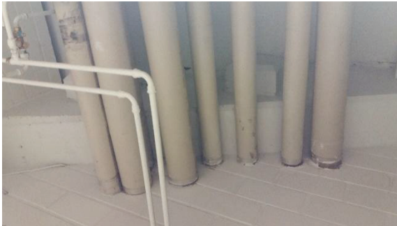
Vanhempaa putkistoa hallin katossa
