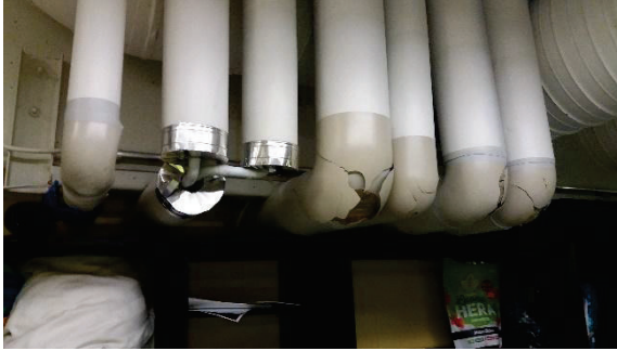
Vanhoissa eristeissä on hajonneita kohtia
