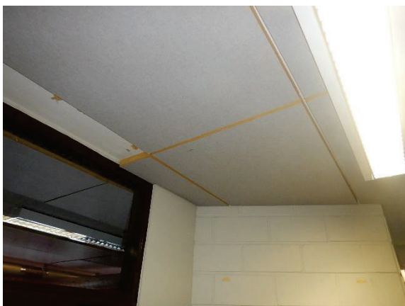
Toimistotilojen alakatoissa akustiikkalevyjä, joiden reunat ovat pinnoittamattomia
