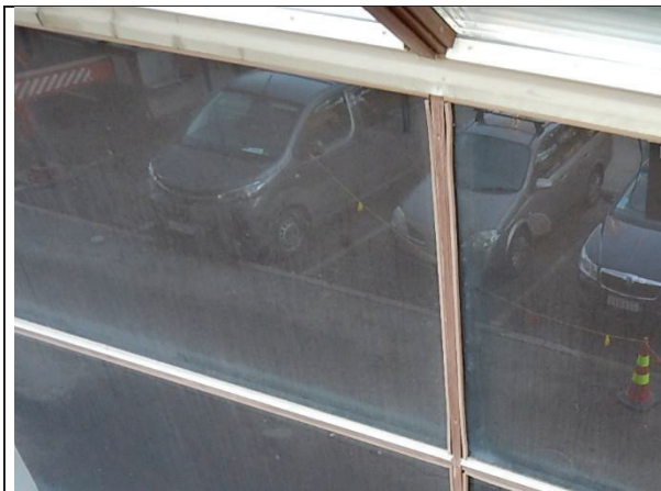
maantasokerroksen ikkunoiden lasilistoissa käyritystä ja halkeilua
