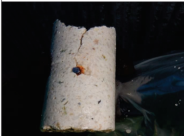
Halkeamat ulottuvat raudoitukseen
