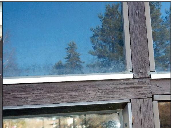
Ikkunan puitteissa haristumaa ja maalivaurioita
