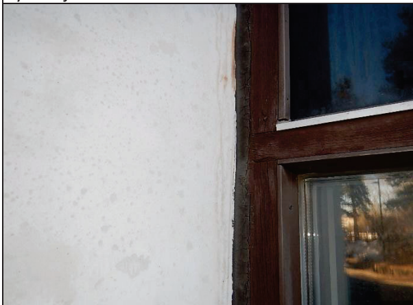
ikkunoiden julkisivuliittymien tiivistyksissä on monin paikoin puutteita
