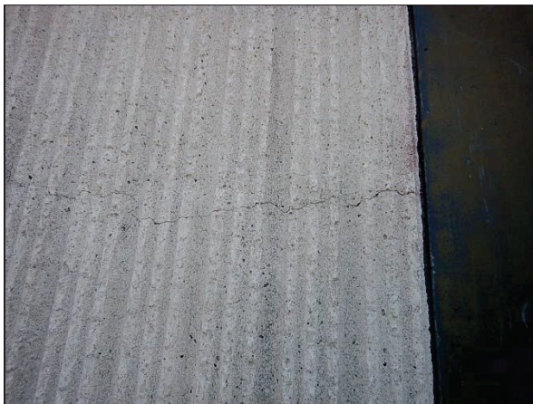
Elementeissä vaakasuuntaista halkeilua
