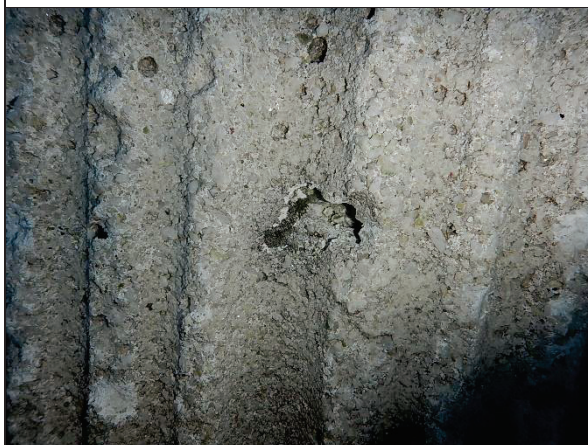
Laaja-alaista pakkasrapaamaa julkisivun pinnassa
