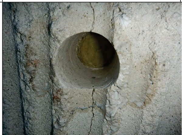
Ansaan kohdalla pystyhalkeama ulottuu teräkseen asti
