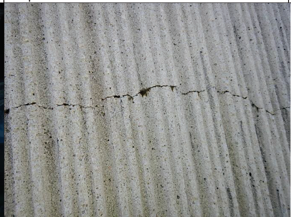
Vinolla julkisivuosuudella halkeamassa sammalkasvustoa
