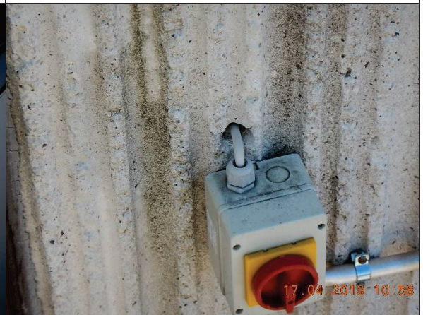
läpivientien tiivistyksessä paikallisia puutteita
