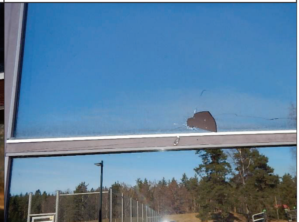
yksittäisiä ikkunaruutuja rikkoutunut
