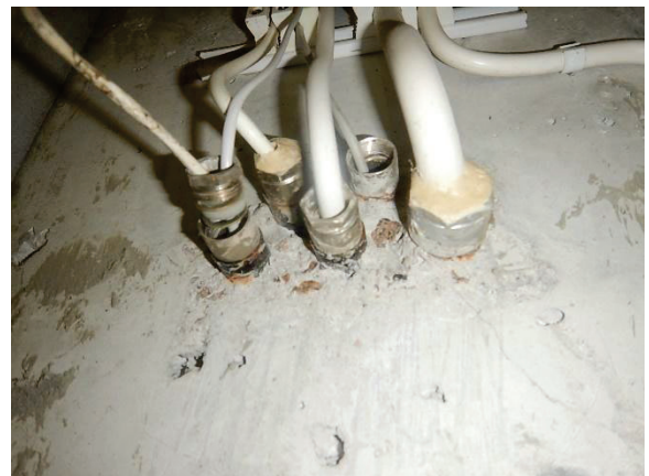
Puutteellinen väestönsuojan paineläpivienti
