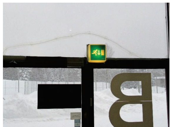
Vanha poistumistievalaisin B-ovella
