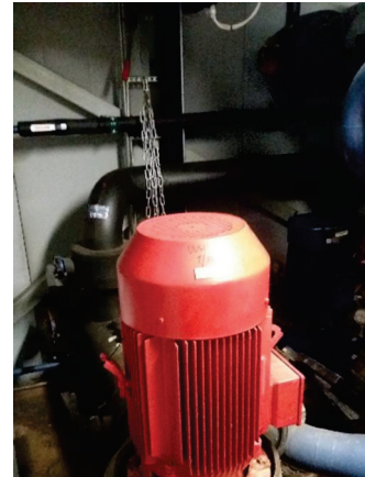
Jäähdytyspiirin vaihdettava pumppu
