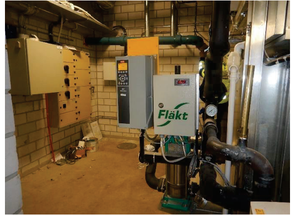
Ilmanvaihtokonehuoneessa rakennusautomaation alakeskus, ryhmäkeskus ja koneikon keskus, sekä taajuusmuuttaja
