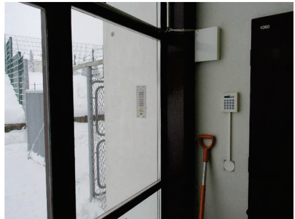
Oviympäristö, jossa HHL-järjestelmän ovikeskus ja käyttönäppäimistö
