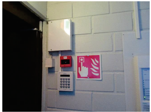
Oviympäristössä HHL-järjestelmän lukitusta ohjaava ovirasia ja järjestelmän kautta kytketty rikosilmoitusjärjestelmän näppäimistö
