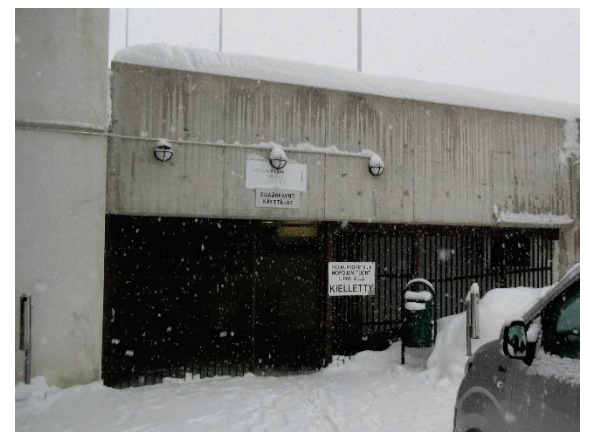
Käyttäjien sisäänkäynnin valaistusta
