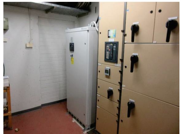
Loistehon kompensointiparisto pääkeskuksen vieressä
