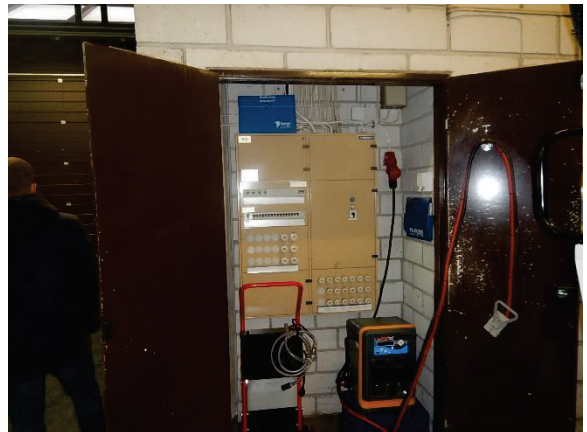
Jäänhoitokoneen akkujen latauslaitteita keskuksella
