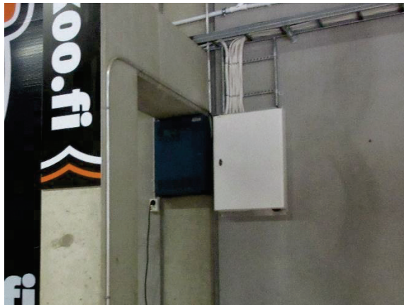
Antennivahvistin sähkökeskuksen vieressä
