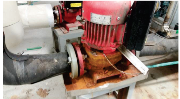
Jäähdytyspiirin vuotanut pumppu
