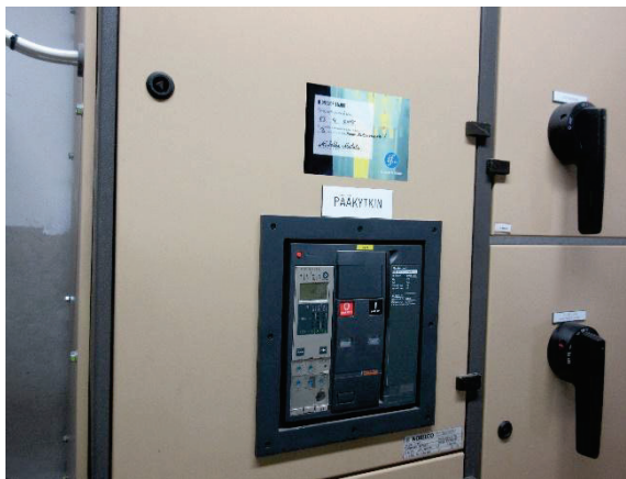
Sähköpääkeskuksen pääkytkimenä toimiva katkaisija
