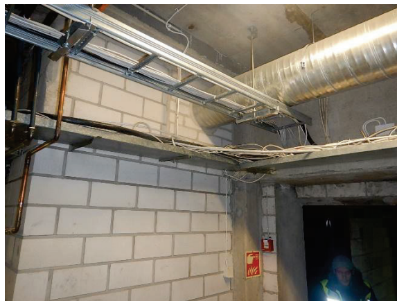
Kaapelihyllyjä teknisissä tiloissa
