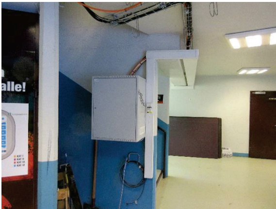
Uudehko yleiskaapelointikaappi aulassa
