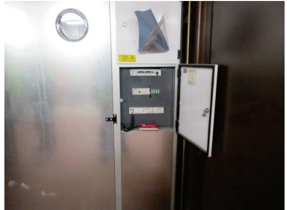
Ilmanvaihtokoneen sisäänrakennettu ohjauskeskus
