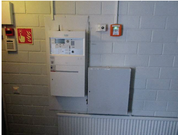
Paloilmoitinlaite ja paikantamiskaaviot rappukäytävässä
