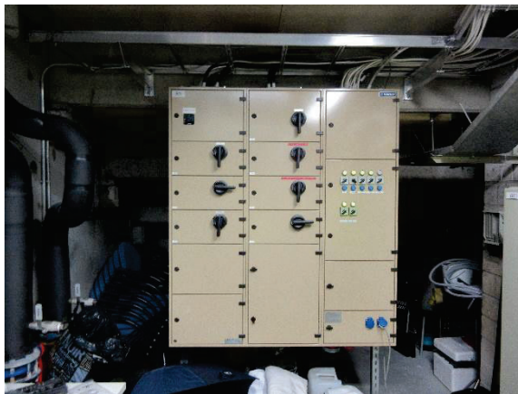
Ilmavaihtokonehuoneessa keskus RK116
