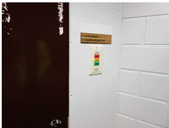
Uppoasenteinen sisäänpyyntökoje toimistotiloissa
