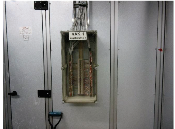
VAK1:n kenttäkytkentäkotelo ilmanvaihtokonehuoneessa
