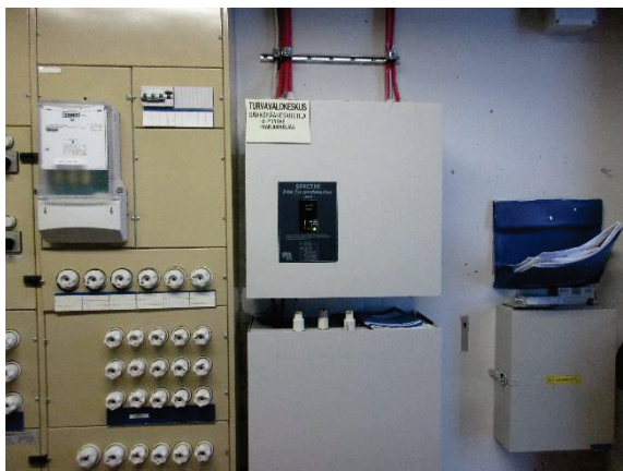
Turvavalaisinkeskus TVK1 pääkeskushuoneessa
