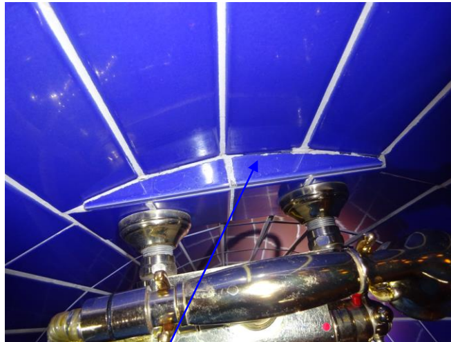
Kuva 11, avonainen kohta saumauksessa.
