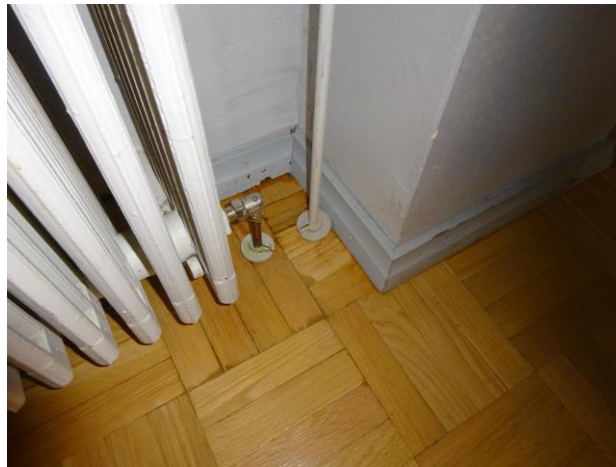
Kuva4, pienimuotoinen kosteusvaurio parketissa.
