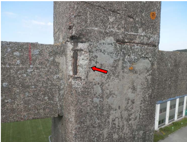
Kuva 4. Pilariosaa keskimmäisen orren kohdalta (pylväs 7). Nuolella on merkitty ruostunut ja lohjennut kohta.
