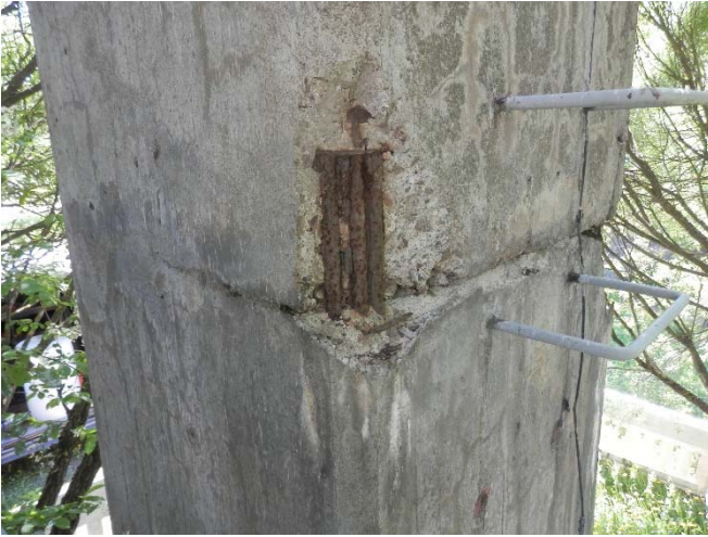
Kuva 7. Pylvään 7 nurkissa on erittäin vakavasti ruostuneita ja syöpyneitä teräksiä. Kuvassa näkyy myös vaakahalkeama.
