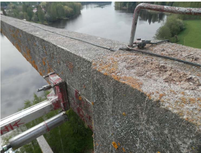
Kuva 2. Ylin orsi, pylväs 10. Kuvassa näkyy orren päälle kiinnitetty maadoitusjohdin.
