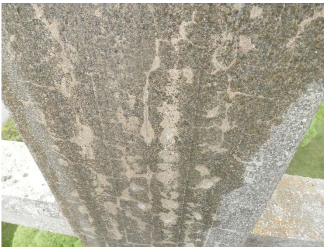
Kuva 5. Pylvään 7 pinnassa on verkkohalkeilua. Verkkohalkeilua on paikoin myös muissa pylväissä.
