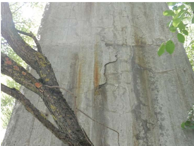
Kuva 6. Alempana pylvästä verkkohalkeilu on vakavampaa ja lohkeilua esiintyy.
