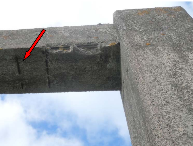
Kuva 9. Betoniteräksiä oli pinnassa koko pylvään 7 alueella useissa kohdin.
